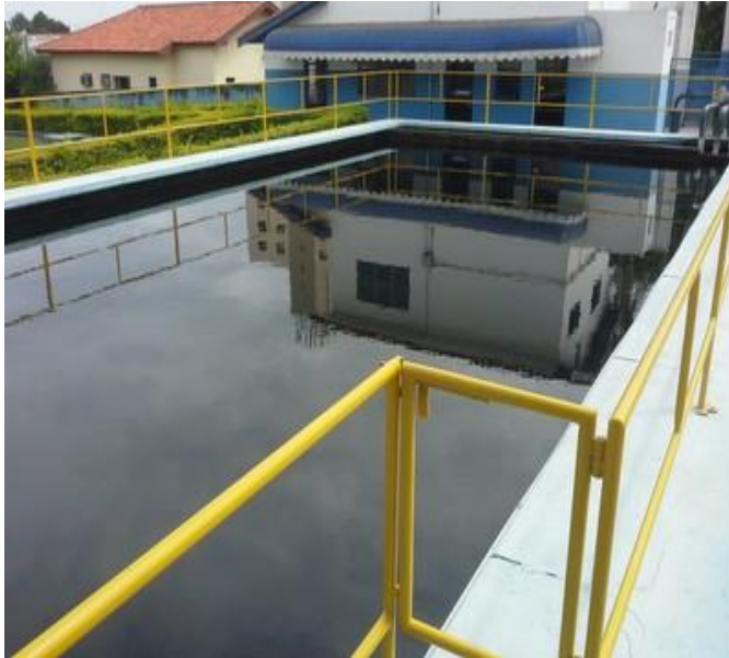
Descrição(2): Tanque para oxidação de Ferro e Manganês
