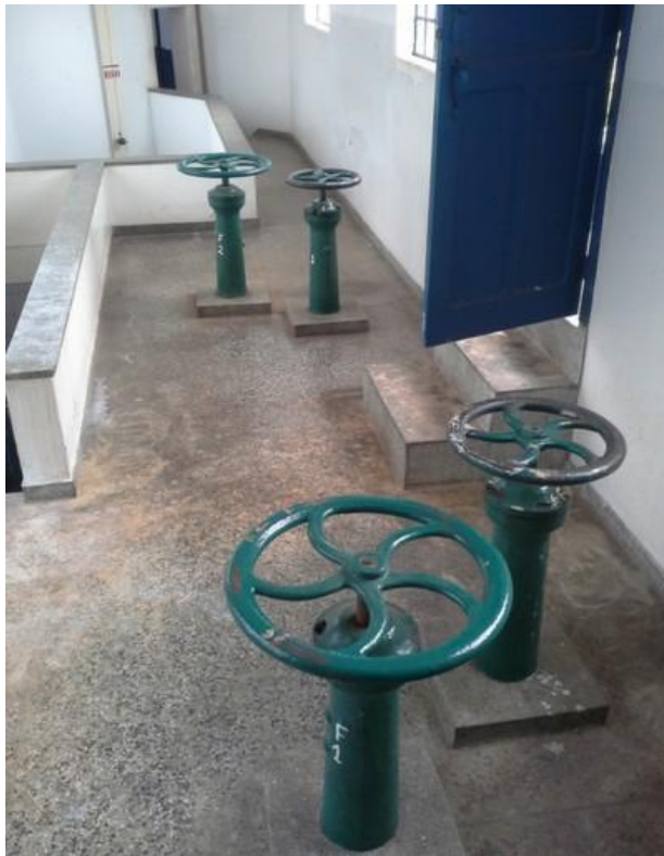
Descrição(6): Comando dos filtros
