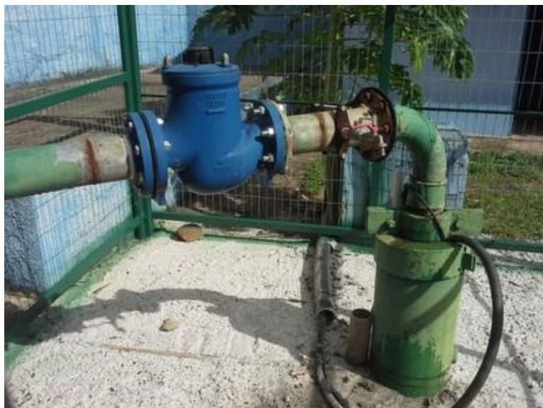
Descrição(2): Hidrômetro, tomada de água e tubo guia
