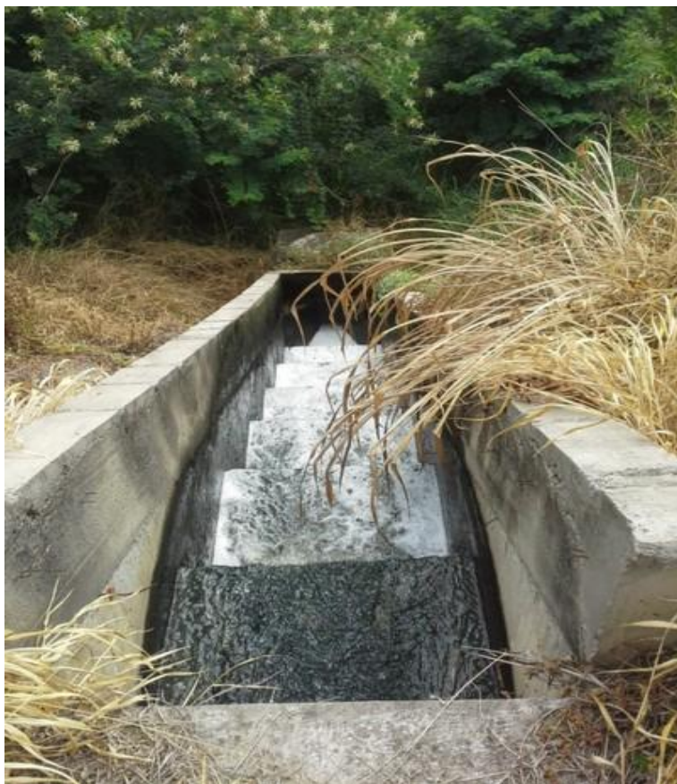
Descrição(10): Lançamento do efluente final
