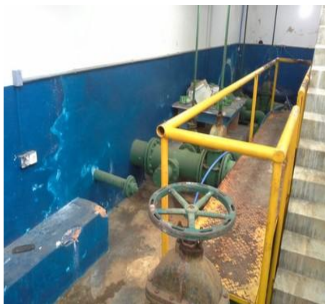
Descrição(7): Saída dos filtros
