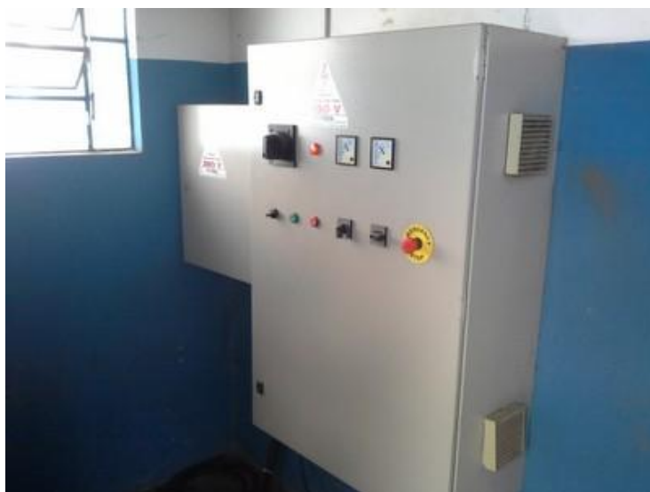
Descrição(3): Painéis elétricos
