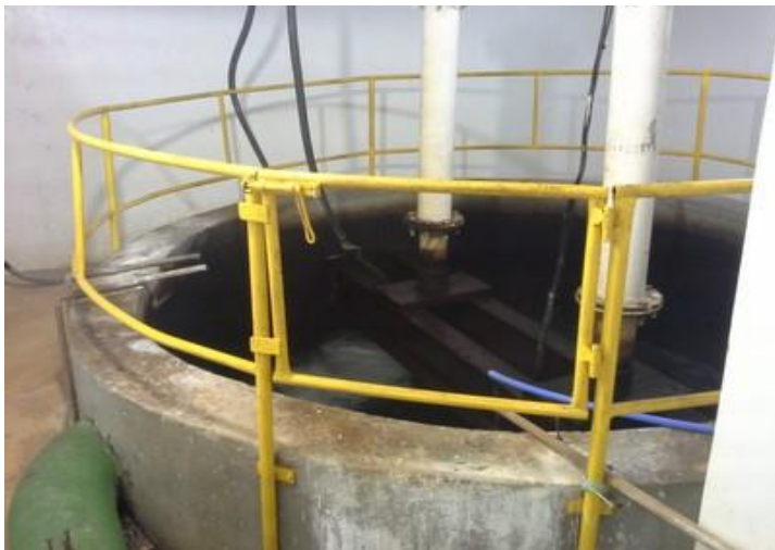
Descrição(10): Tanque de contato
