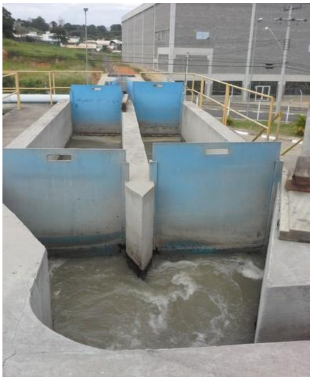
Descrição(4): Chegada do esgoto bruto, desarenador e Calha Parshall
