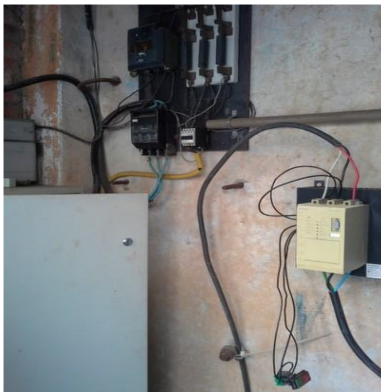
Descrição(3): Painéis elétricos
