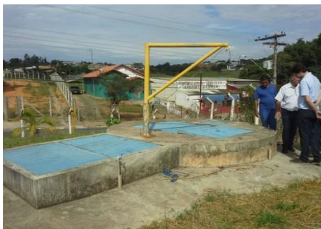
Descrição(11): Estação Elevatória de Esgoto Bruto (EEEB)
