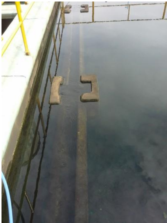
Descrição(3): Entrada dos filtros
