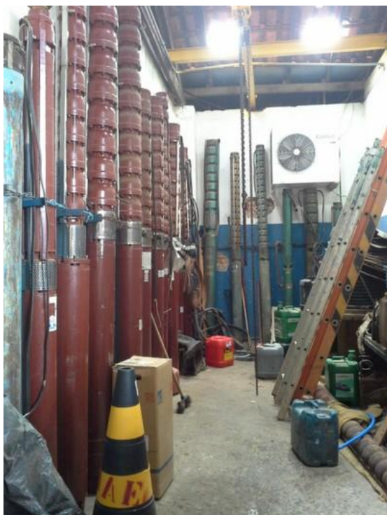
Descrição(4): Conjuntos reserva
