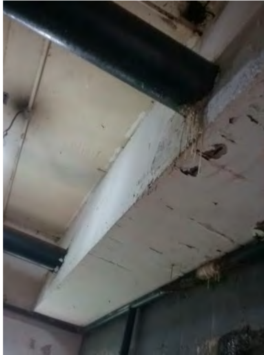
Descrição: Etalactites devido à lixiviação e carbonatação do concreto FOTOS(6)
