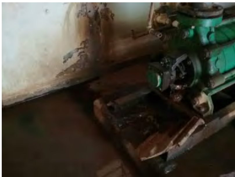
Descrição(4): Conjunto moto-bomba
