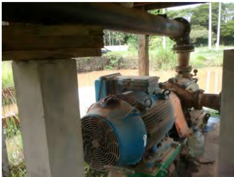
Descrição(4): Conjunto moto-bomba
