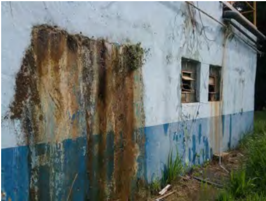
Descrição: Machas de umidade
