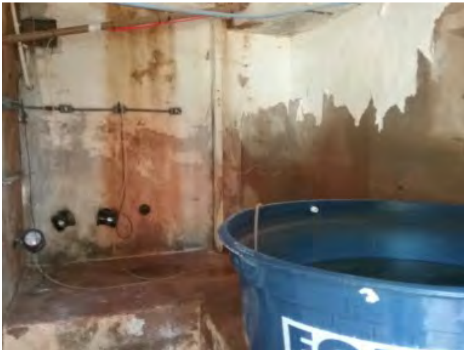
Descrição: Armazenagem de sulfato de alumínio
