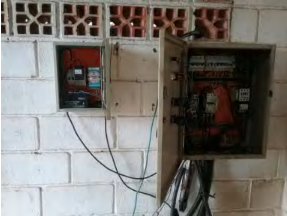
Descrição(3): Painel elétrico
