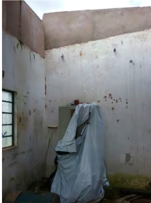
Descrição(3): Detalhe do painel desprotegido
