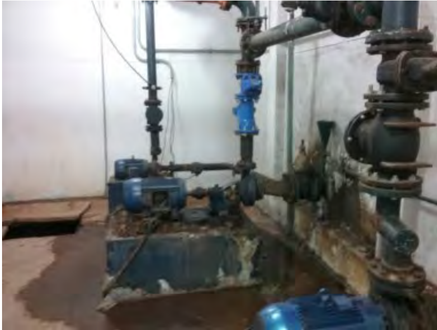
Descrição(1): Vista geral dos conjuntos de recalque Imagem(2)
