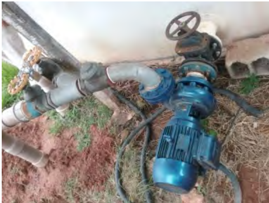
Descrição(2): Conjunto moto-bomba
