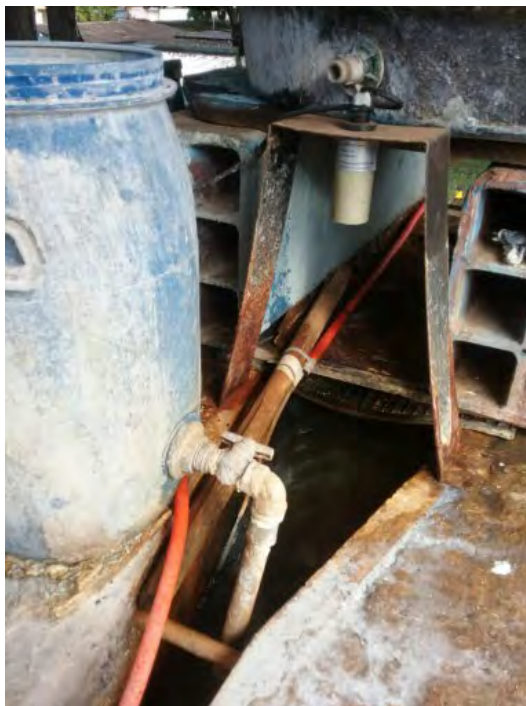
Descrição: Mistura rápida e medidor ultrassônico de vazão
