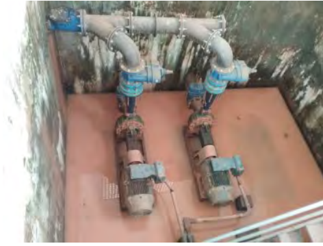
Imagem(2): Conjuntos moto-bomba em lugar inundado
