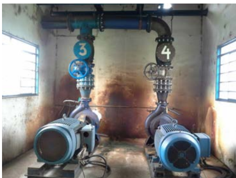
Descrição(7): Conjuntos de recalque
