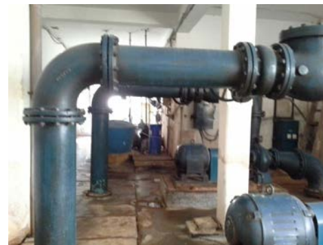
Descrição(16): Saída filtros
