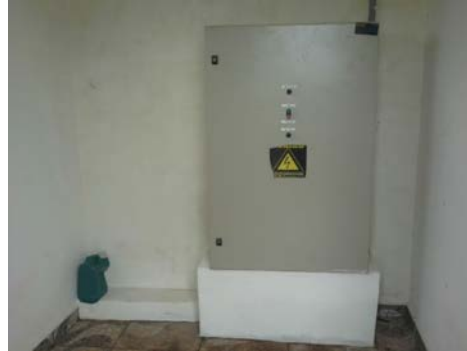
Descrição (2): Painel elétrico Imagem(4)
