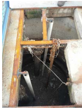
Descrição (3): Bomba recalque Imagem(5)
