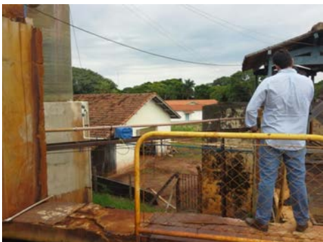
Descrição(8): Local ausencia de guarda corpo
