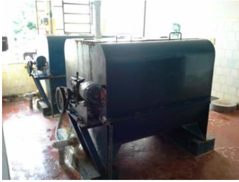
Descrição(11): Dosador de cal Imagem(13)
