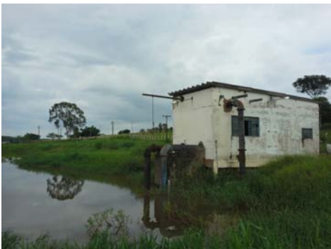
Descrição(13): Casa de bombas II
