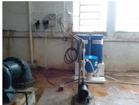
Descrição(14): Dosagem de cloro automatizada Imagem(16)
