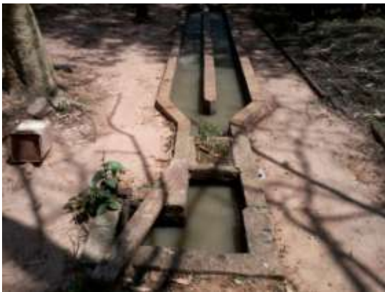
Figura 6 - Entrada do esgoto bruto e desarenadores
