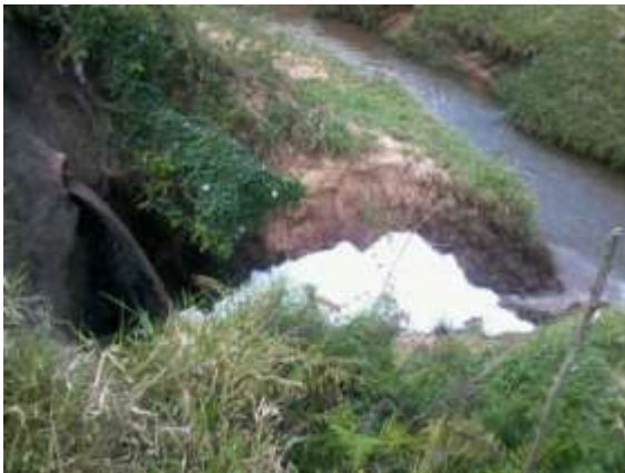
Figura 12 - Despejo do efluente tratado, com destaque a formação de espuma e perda de trecho de tubulação por erosão do solo
