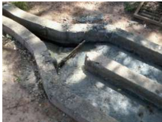
Figura 7 - Gradeamento obstruído e desarenadores afogados
