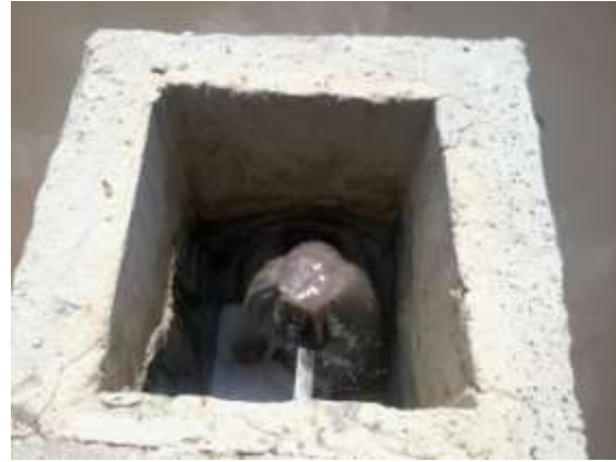
Figura 11 - Saída do efluente tratado
