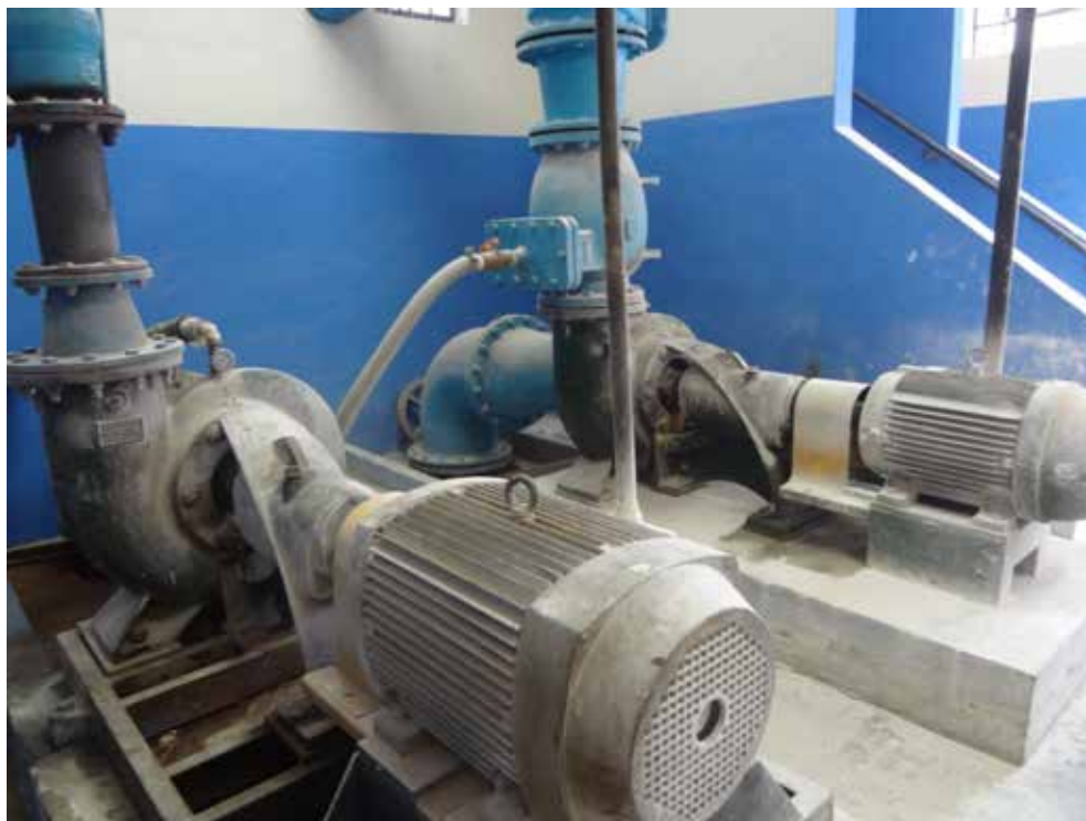
Figura 7 - Estação Elevatória de Água Tratada na ETA Bela Vista
