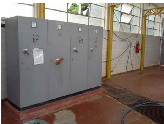
Descrição(8): Painel elétrico e extintor de incêndio
