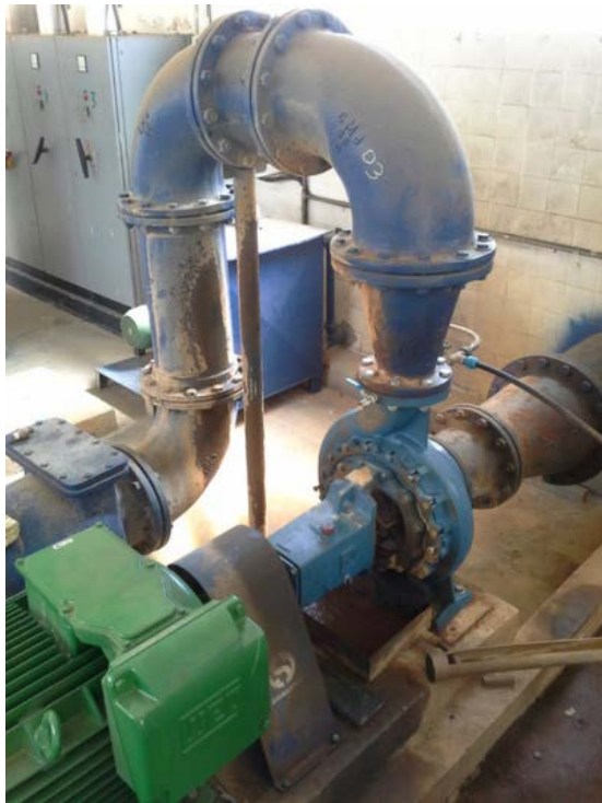
Descrição(5): Conjunto de recalque
