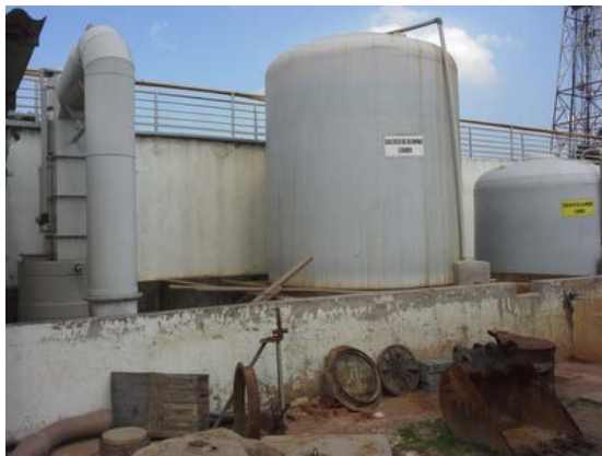
Descrição(15): Lavador de gases e armazenamento de produtos químicos
