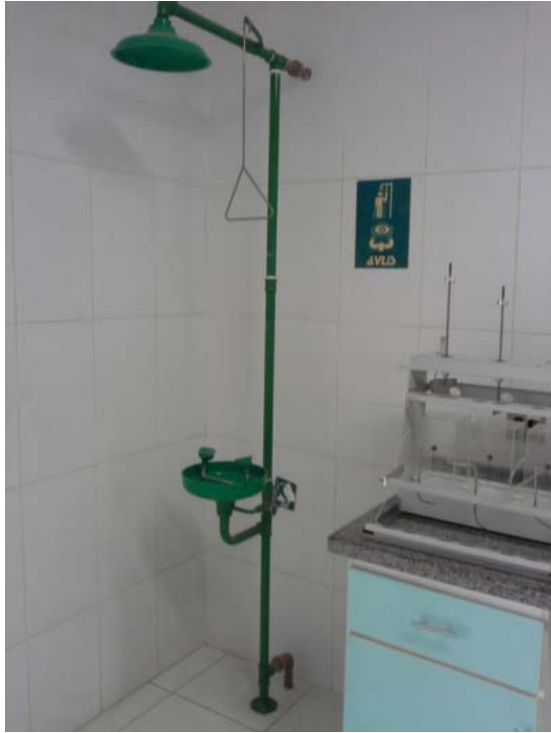
Descrição(3): Chuveiro de emergência
