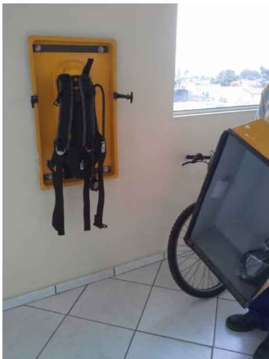
Descrição(13): Kit para vazamento de Cloro gás
