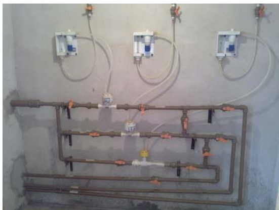
Descrição(16): Dosadores de Cloro
