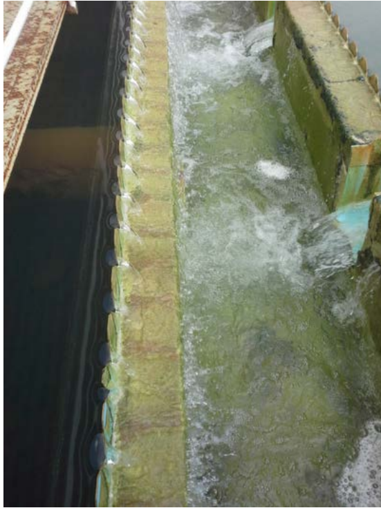
Descrição(10): Entrada dos filtros
