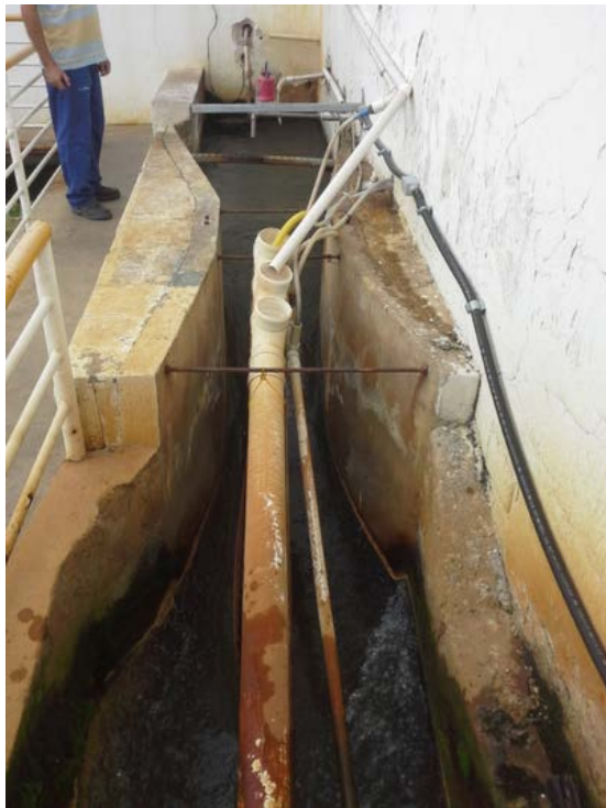
Descrição(5): Entrada da água bruta
