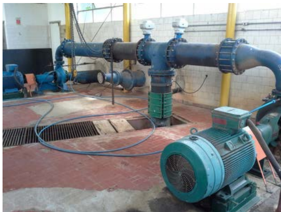
Descrição(7): Conjuntos de recalque
