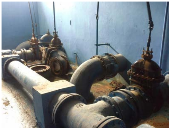
Descrição(18): Tubulações dos filtros
