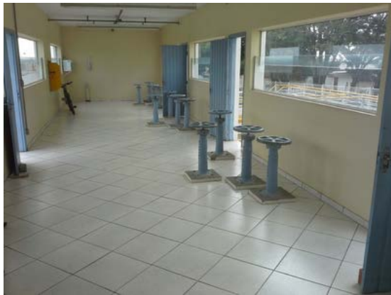
Descrição(11): Sala de comando de filtros
