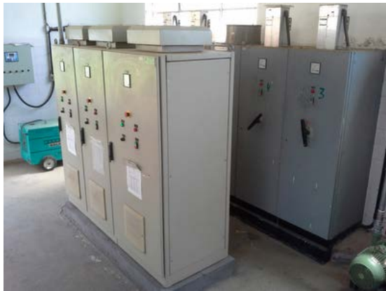
Descrição(6): Paineis elétricos
