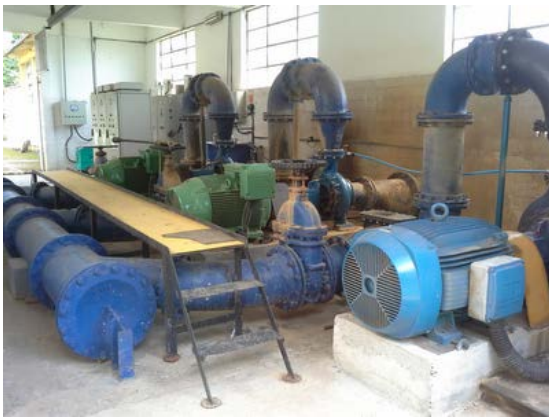
Descrição(4): Conjuntos de recalque
