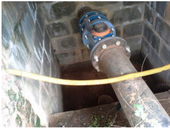
Descrição(4): Macromedidor na saída para distribuição
