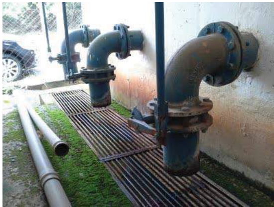
Descrição(7): Vista detalhada dos vazamentos dos registros de descarga de fundo dos filtros
