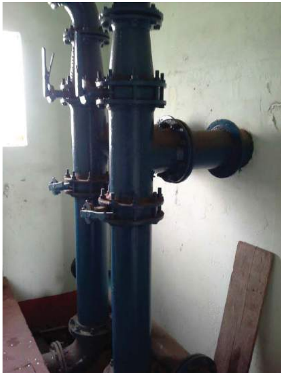
Descrição(8): Vista geral dos barriletes dos filtros
