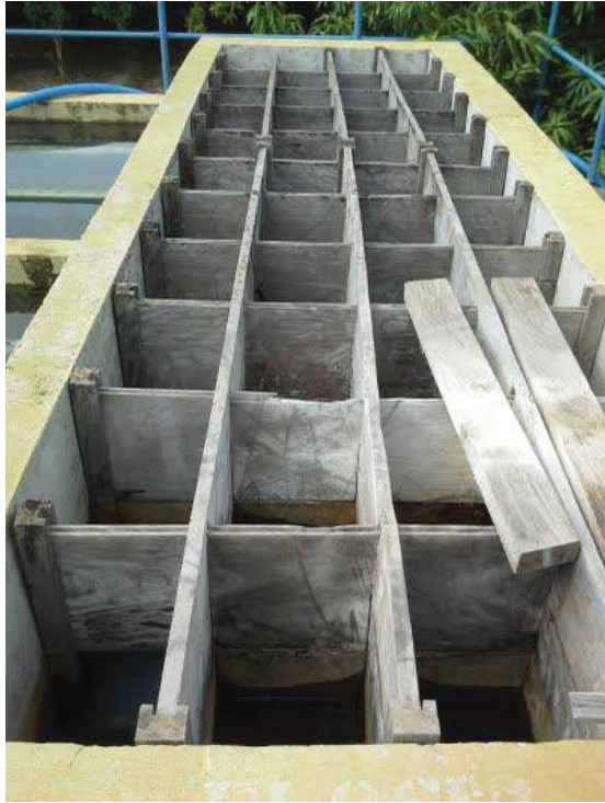
Descrição(2): Vista geral dos floculadores
