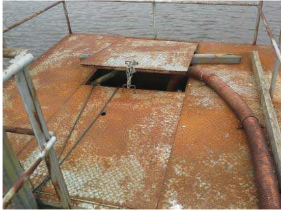
Descrição(3): Vista detalhada da plataforma da bomba submersa
