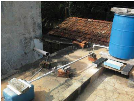
Descrição(4): Vista geral do dosador de flúor
