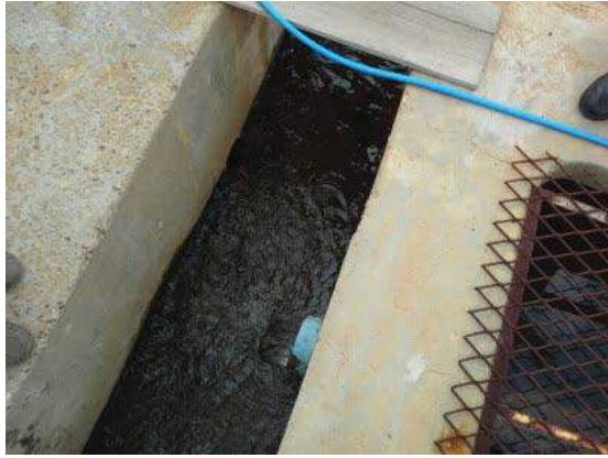
Descrição(3): Vista detalhada da caixa de passagem do decantador para o filtro lento
