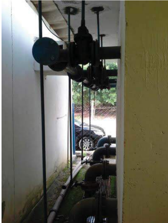
Descrição(6): Vista geral dos vazamentos nos registros de descarga de fundo dos filtros
