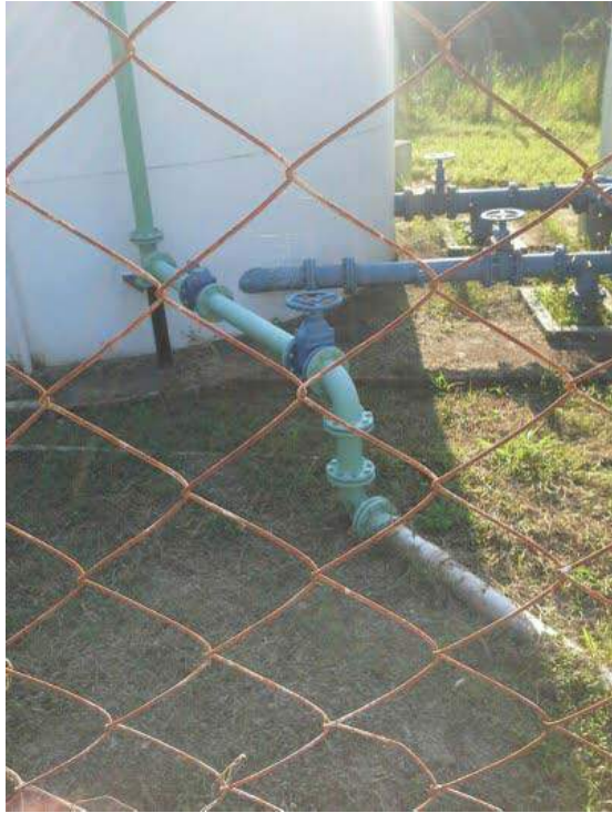
Descrição(3): Vista geral da adutora de gravidade de água tratada do SEMAE Piracicaba
