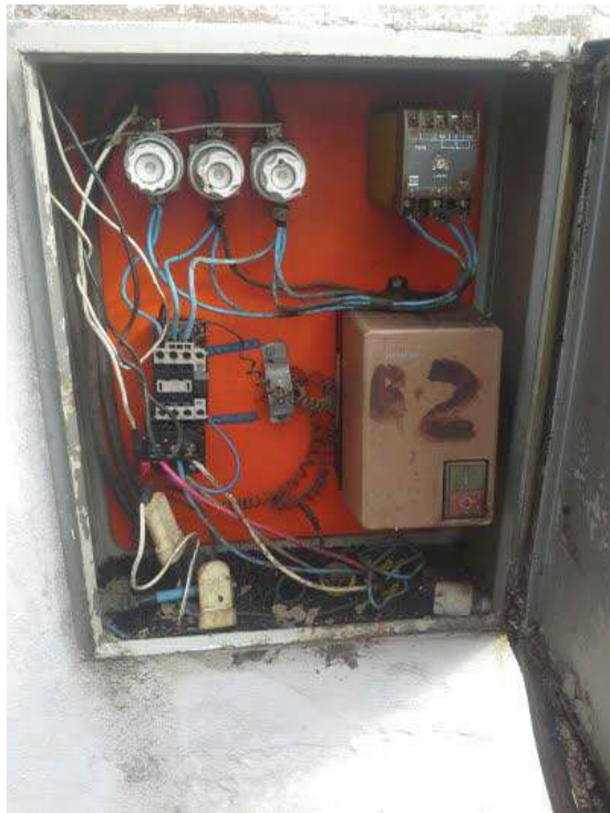
Descrição(3): Vista detalhada do painel elétrico
