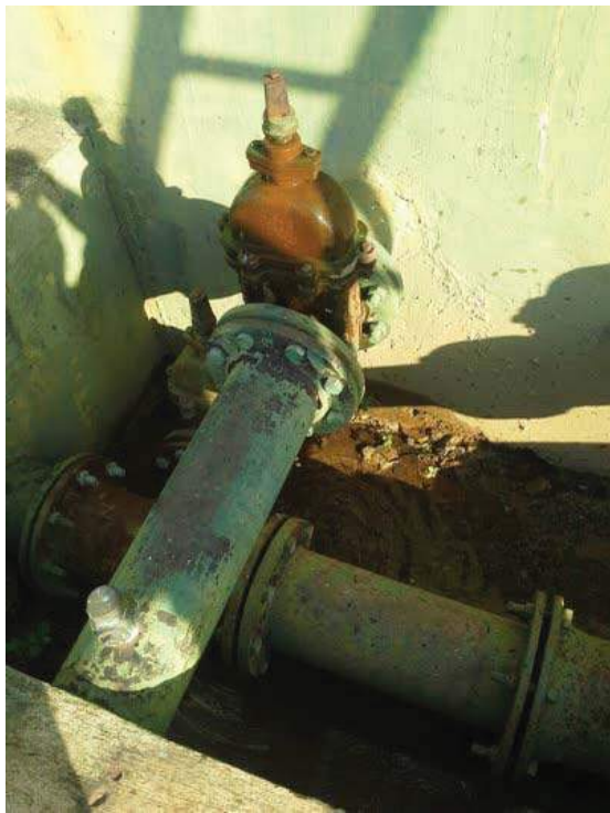
Descrição(3): Vista detalhada de vazamento no registro de abastecimento
