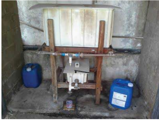
Descrição(3): Vista geral do dosador de ortopolifosfato
