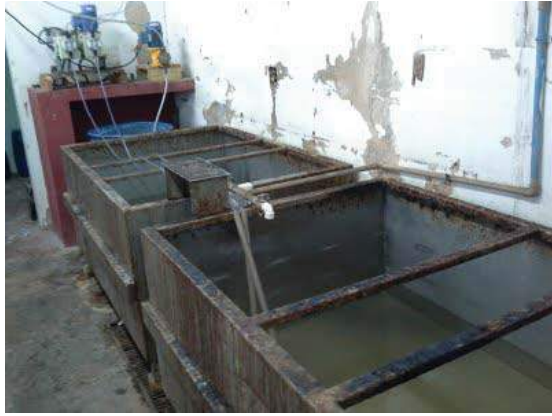
Descrição(13): Vista geral dos containers de mistura e bombas dosadores do PAC da ETA I e ETA II
