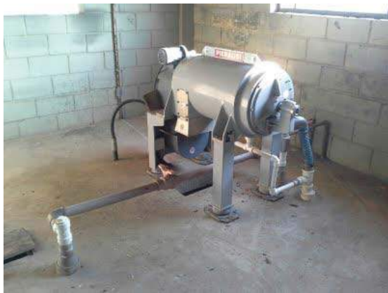
Descrição(5): Vista geral da centrífuga
