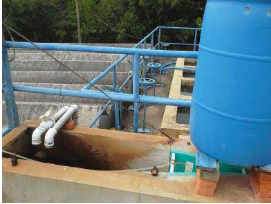
Descrição(6): Vista geral da entrada de água bruta, calha Parshall e zona de mistura rápida do PAC
