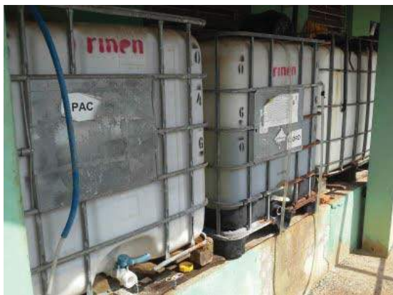
Descrição(15): Vista geral do armazenamento dos produtos químicos
