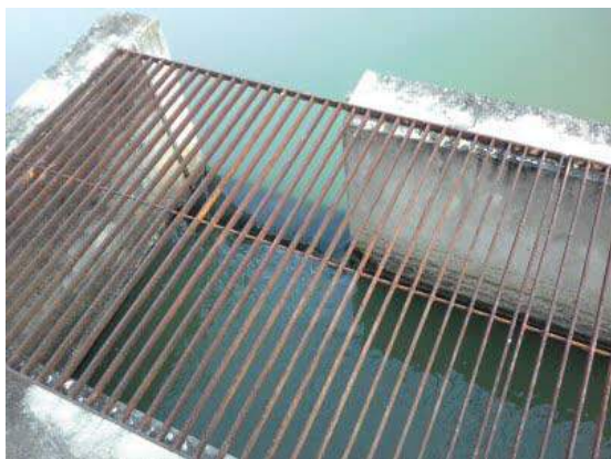
Descrição(9): Vista detalhada da saída do tanque decantador
