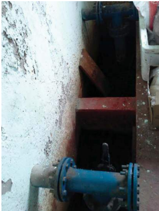
Descrição(9): Vista geral da descarga de fundo dos filtros
