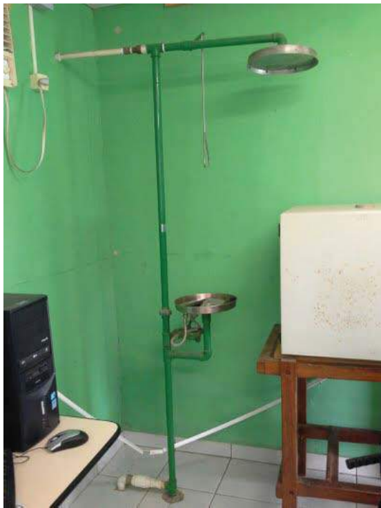
Descrição(9): Vista geral do chuveiro de emergência do laboratório
