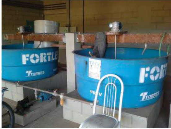
Descrição(7): Vista geral do misturador e dosador de polímero para desidratação do lodo
