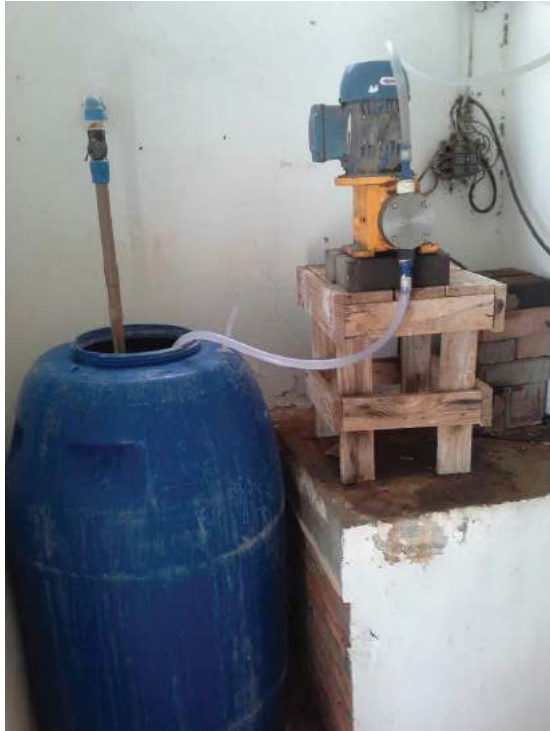
Descrição(5): Vista geral do dosador de cloro
