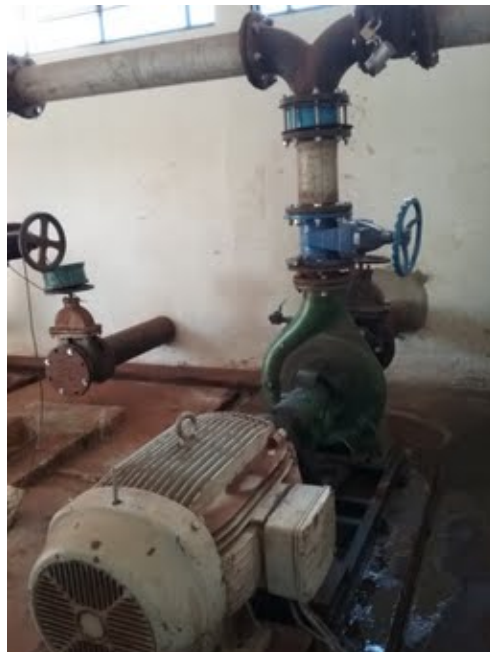
Descrição(5): Detalhe do único conjunto motobomba em funcionamento nesta EEAT (potência do motor = 100 CV)
