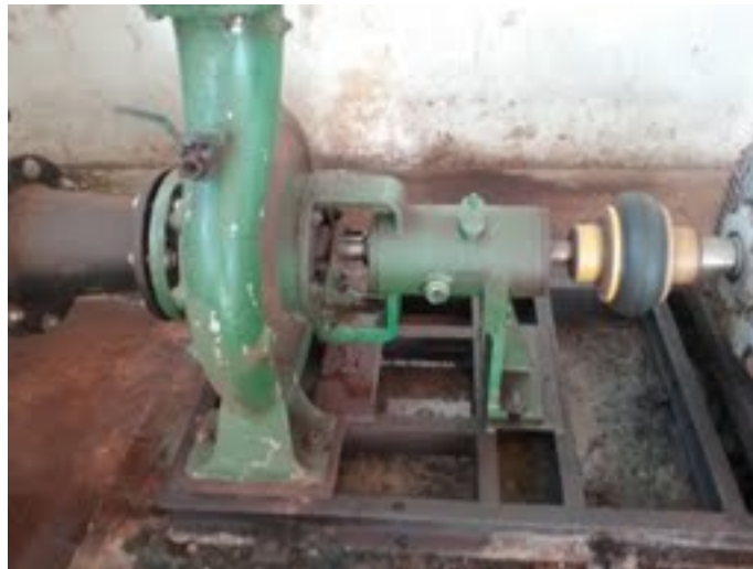
Descrição(4): Detalhe da ausência de sistema de drenagem da água de lubrificação da gaxeta da bomba hidráulica
