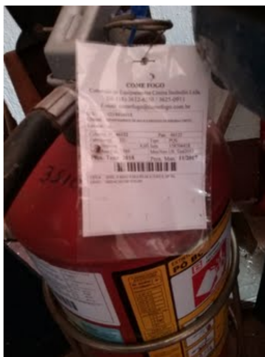
Descrição(8): Extintor de incêndio com a carga com o prazo de validade vencido
