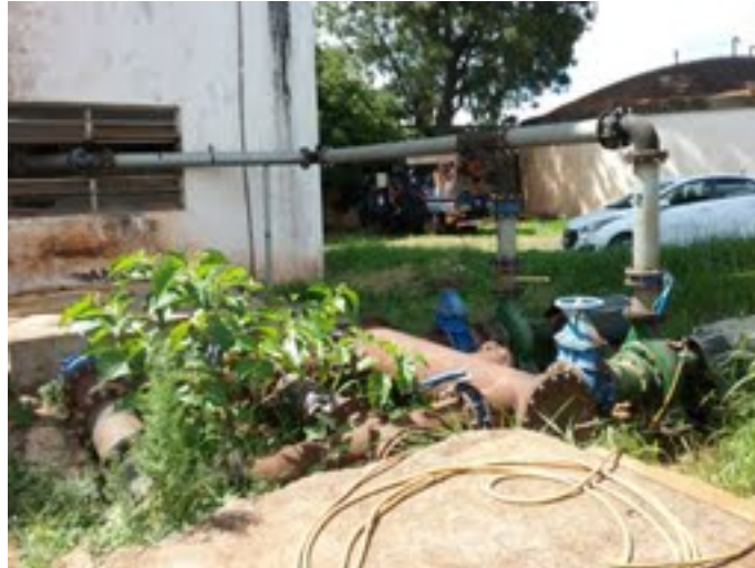
Descrição(3): Elevatória de água tratada local, Centro de Reservação Paulista, mostrando o detalhe da tubulação de recalque ao reservatório elevado local
