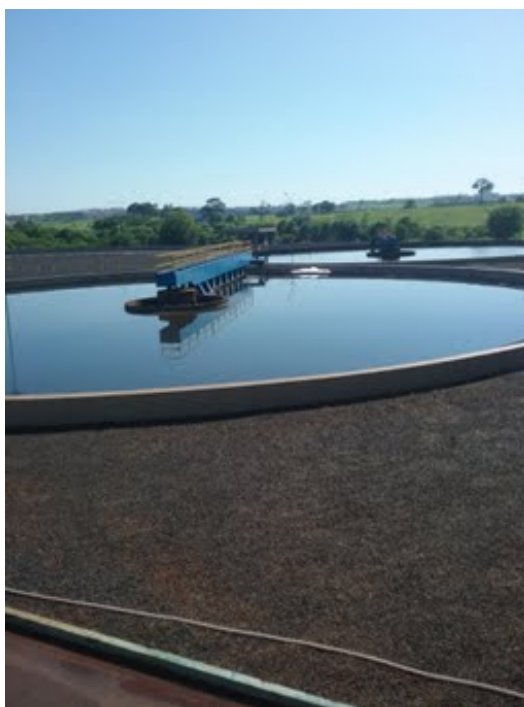
Descrição(12): Decantadores secundários
