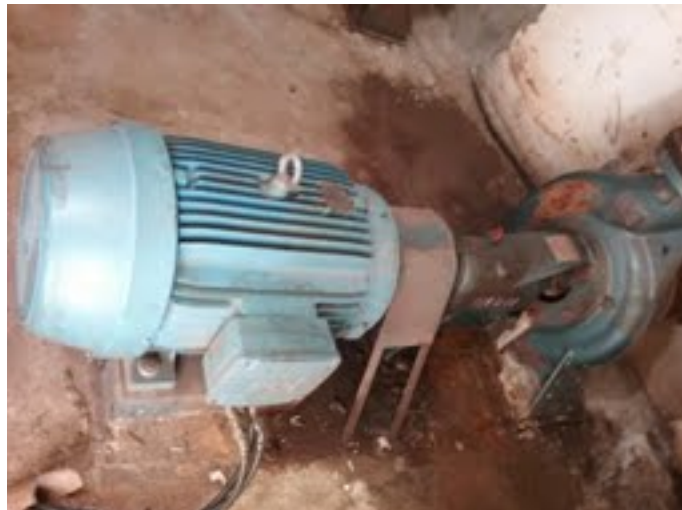
Descrição(5): Drenagem inadequada
