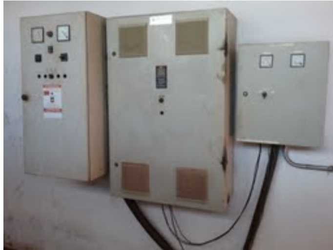
Descrição(3): Painéis elétricos de comando dos conjuntos motobombas da EEAT Imagem(4)
