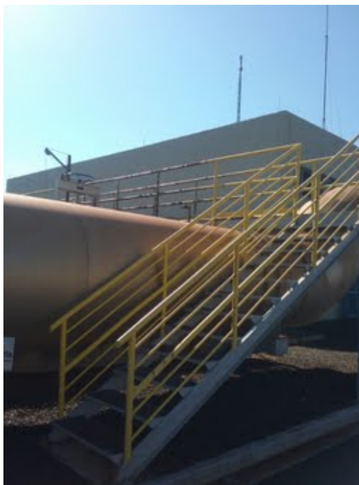
Descrição(10): Detalhe para oxidação da estrutura
