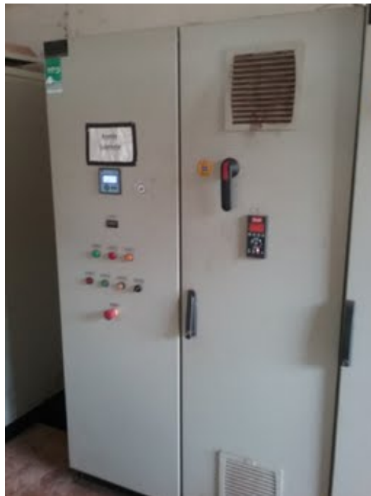
Descrição(5): Painelelétrico de comando do conjunto motobomba do poço tubular profundo
