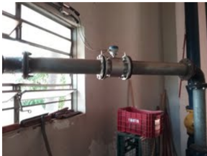
Descrição(6): Macromedidor de carretel instalado na tubulação de recalque para o Reservatório Elevado local
