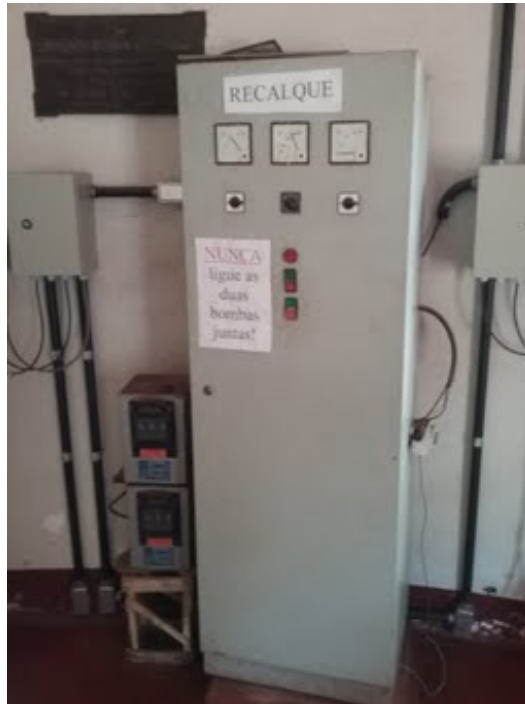
Descrição(5): Painel elétrico de comando dos conjuntos motobombas da EEAT local
