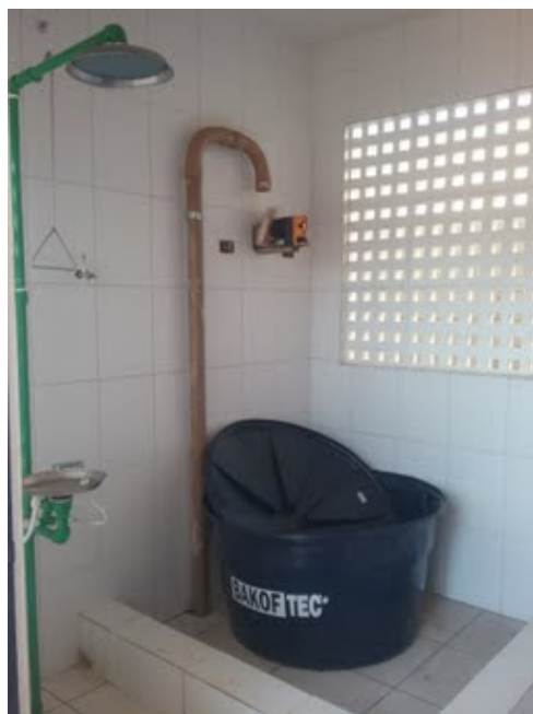
Descrição(1): Casa de química. Tampar o ralo da bacia de retenção.
