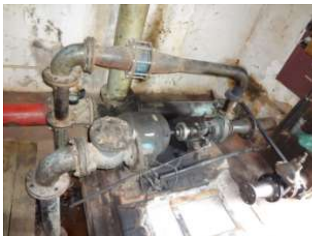
Figura 10 - Recalque da EEAT Hospital
