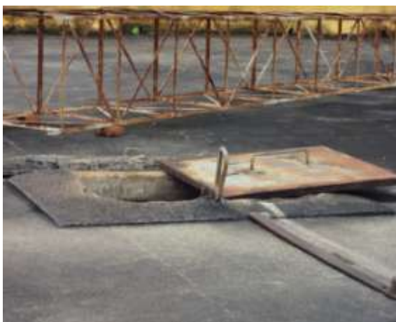
Figura 8 – Tampa de inspeção aberta e que não impede acesso de água de chuva, insetos e pequenos animais
