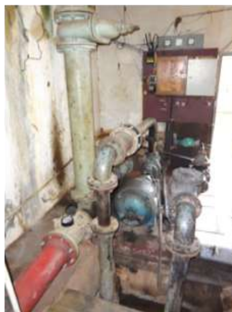
Figura 11 - Aspecto do recalque e macromedidor de entrada do Res. Hospital
