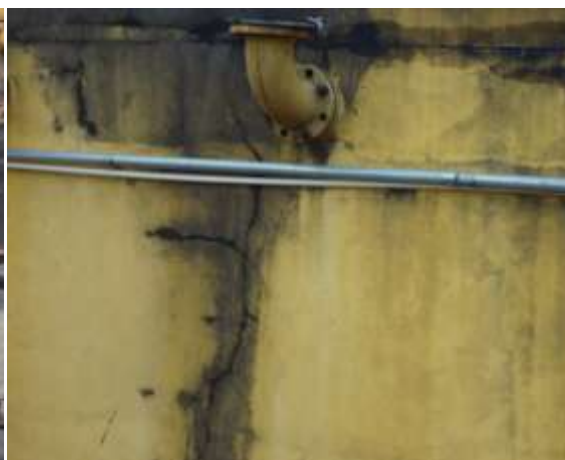
Figura 9 – Aspecto de fissuras no reservatório
