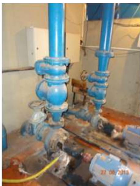
Figura 15 - Conjuntos de recalque para elevado Central
