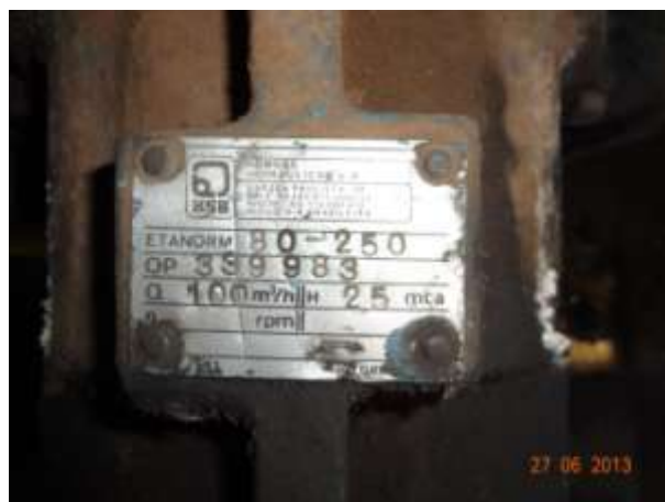
Figura 16 - Placa do conjunto de recalque
