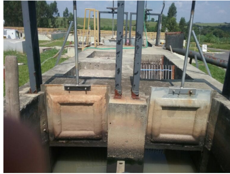
Descrição(1): Estrutura de entrada: Gradeamento, Calha Parshall, Caixa de areia Imagem(2)
