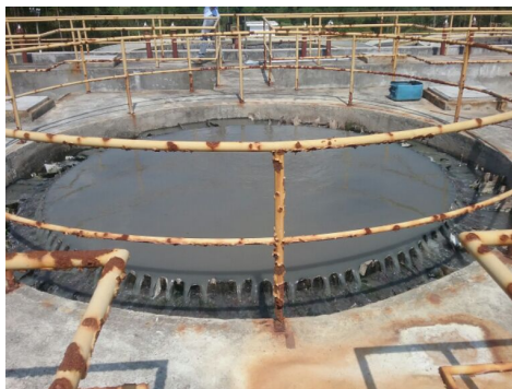
Descrição(8): Entrada central de esgoto nos Reatores UASB
