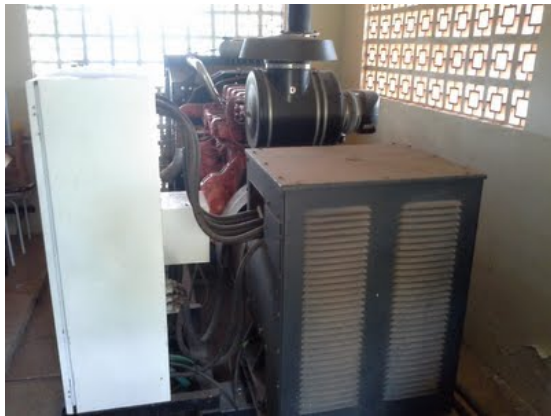
Descrição(5): Grupo gerador
