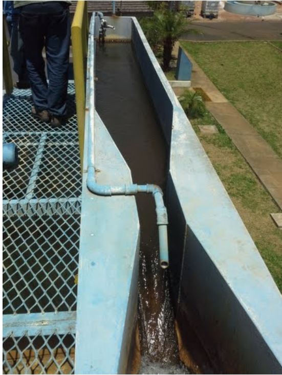
Descrição(2): Chegada da água bruta e mistura rápida
