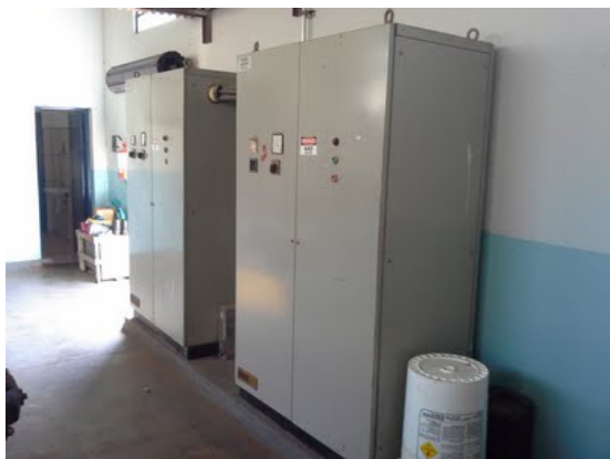
Descrição(11): Paineis elétricos
