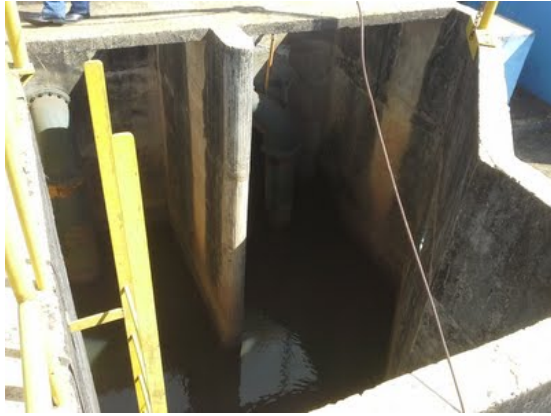
Descrição(6): POCO de sucção do recalque para ETAs 2/3
