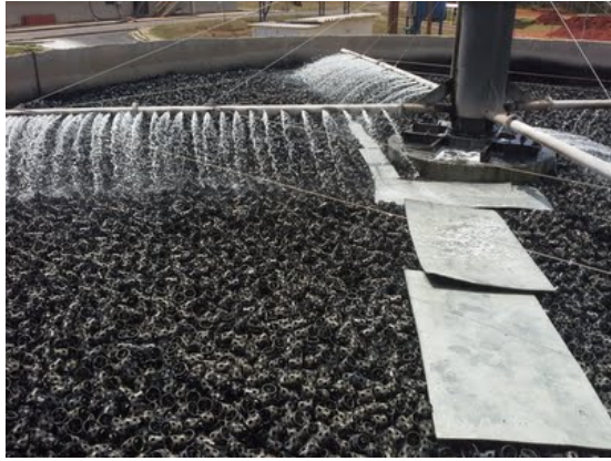
Descrição(10): Filtro biológico
