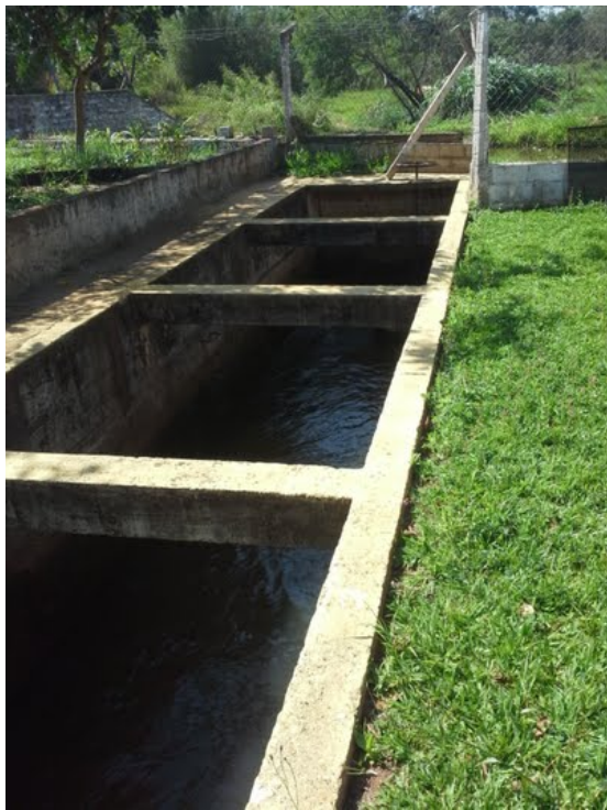
Descrição(2): Tomada e desarenador do recalque para ETA 1
