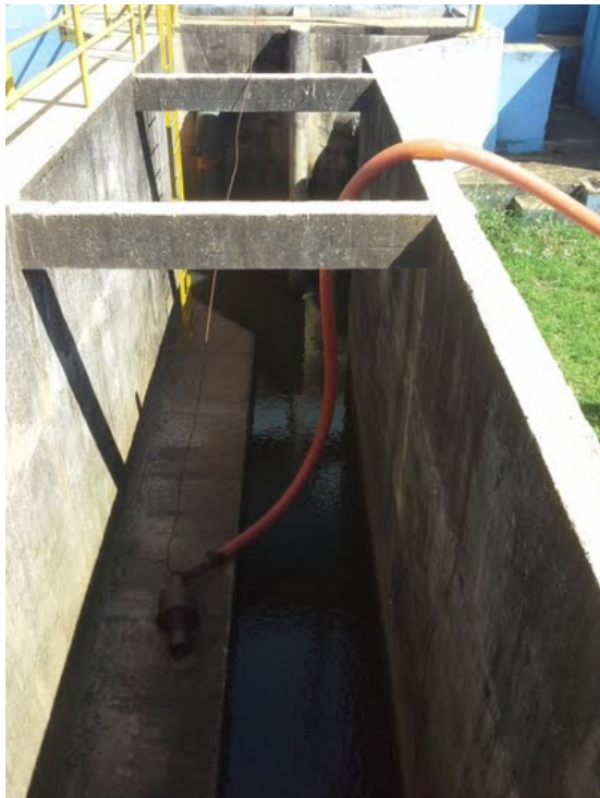
Descrição(5): Tomada e desarenador do recalque para ETAs 2/3
