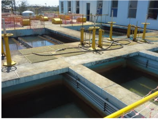
Descrição(7): Área dos decantadores e filtros que não possui guarda-corpos
