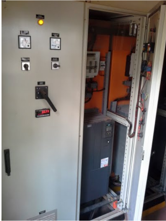
Descrição(6): Paineis elétricos
