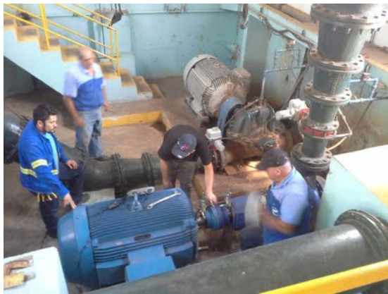
Descrição(7): Conjuntos de recalque para ETAs 2 / 3 - Bombas 1 e 2
