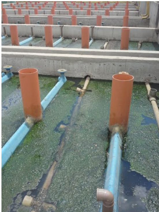
Descrição(7): Cobertura dos reatores anaeróbios
