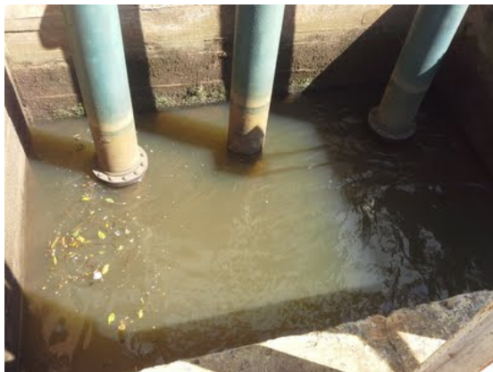
Descrição(3): POCO de sucção do recalque para ETA 1
