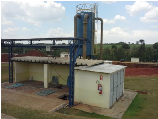
Descrição(9): Torre de carga do efluente dos reatores anaeróbios para o filtro biológico
