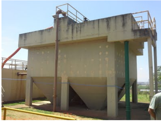
Descrição(16): Adensador de lodo
