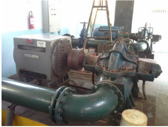
Descrição(9): Bombas 6 e 7 - recalque de água tratada na ETA 1 para Distribuição
