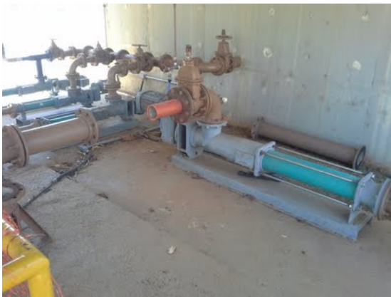
Descrição(14): Recalque do lodo adensado para centrifugação
