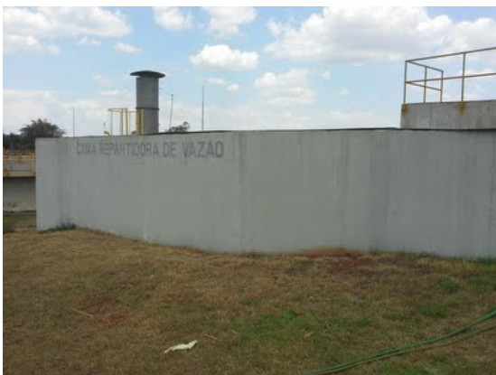
Descrição(5): Distribuidor para os reatores anaerobios
