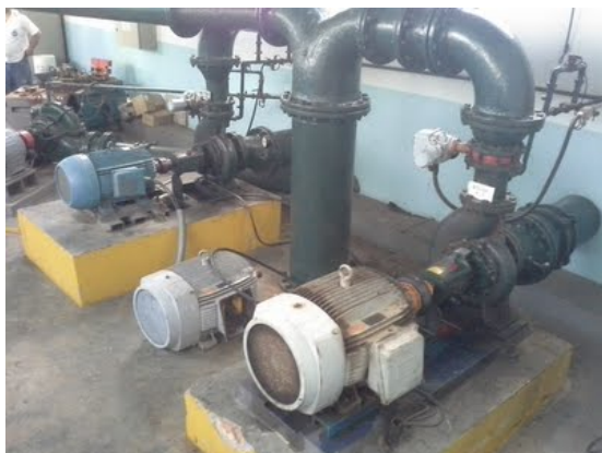
Descrição(8): Conjuntos de recalque para ETA 1 - Bombas 3, 4 e 5 (esta última desativada)
