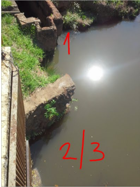
Descrição(4): Tomadas de água para ETAs 1 e 2/3
