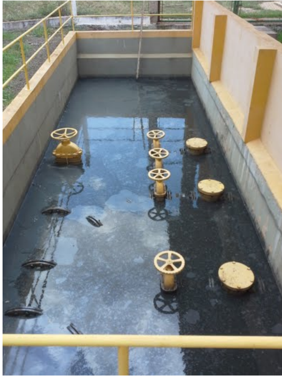
Descrição(4): Caixa de registros de recalque com vazamento no poço de sucção
