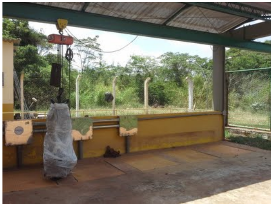
Descrição(7): Monovia e talha para manutenção
