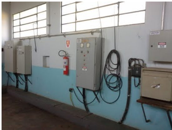
Descrição(10): Paineis elétricos
