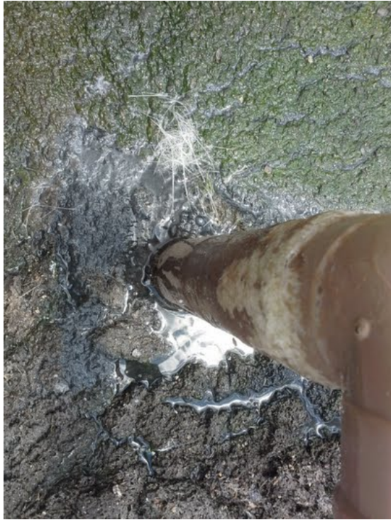
Descrição(8): Vazamento de gases
