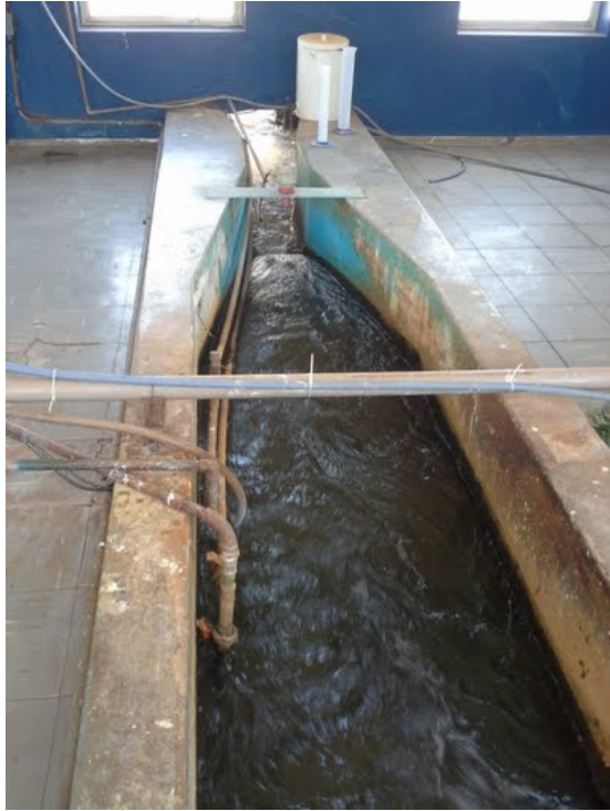
Descrição(2): Calha Parshall
