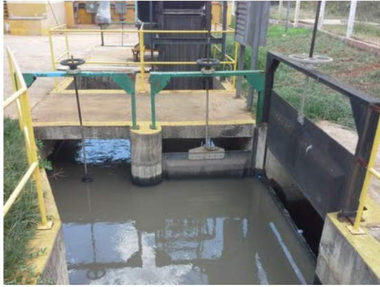
Descrição(2): Gradeamento grosseiro e by pass
