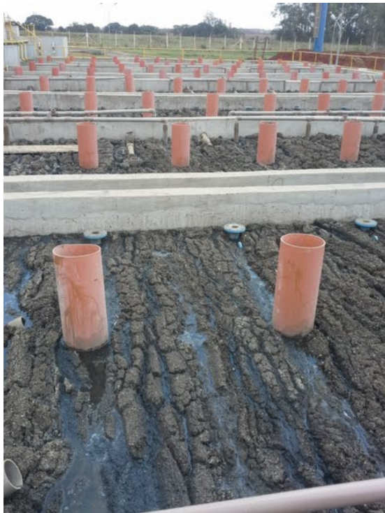
Descrição(6): Cobertura dos reatores anaeróbios
