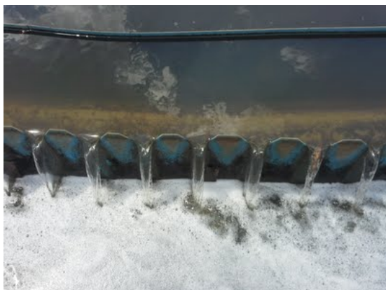
Descrição(12): Saida do decantador
