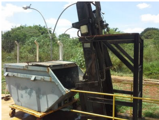
Descrição(3): Gradeamento com limpeza mecanizada
