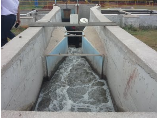
Descrição(3): Calha Parshall
