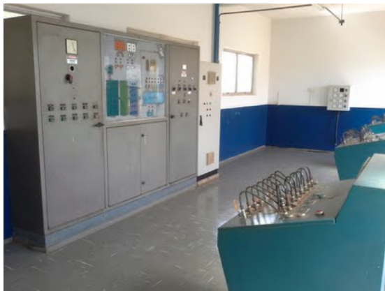
Descrição(8): Comando de válvulas e filtros
