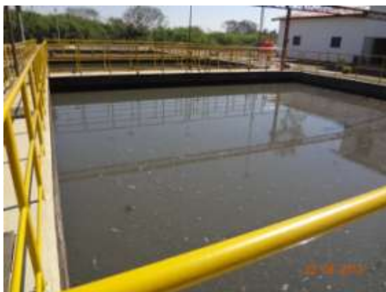
Figura 74 - Lagoa de decantação
