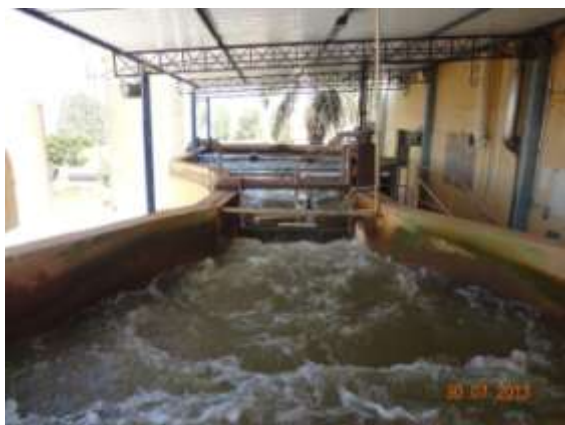
Figura 15 - Chegada da Água Bruta
