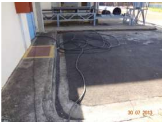
Figura 21 - Cabos expostos próximo ao sistema de desidratação de lodo
