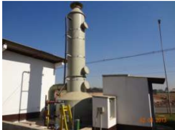
Figura 61 - Sistema de exaustão de gases
