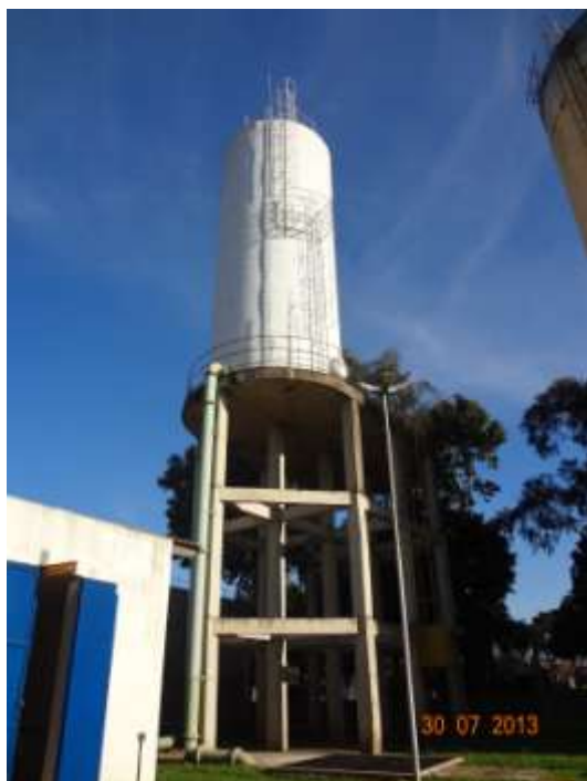
Figura 32 - Reservatório elevado 500 m 3
