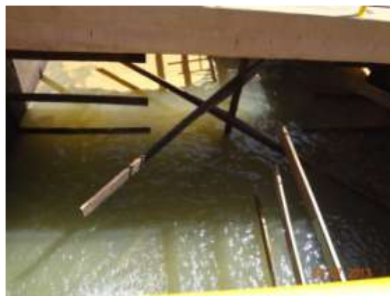
Figura 16 - Floculador em operação
