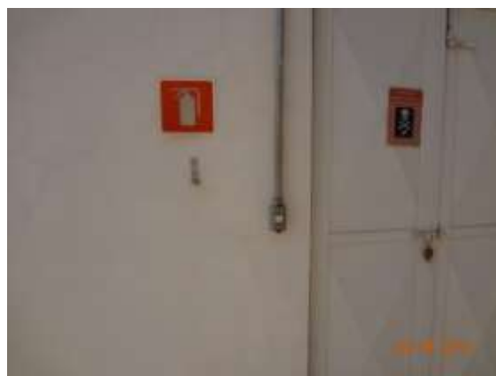
Figura 57 - Local reservado para extintor de incêndio próximo a sala dos sopradores
