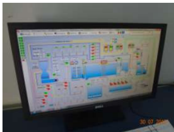
Figura 18 - Centro de Controle Operacional
