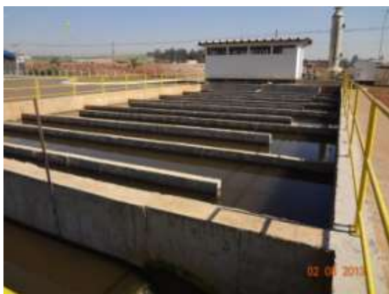
Figura 62 - Tanque de contato
