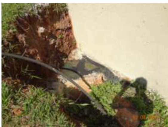
Figura 76 - Detalhe de vazamento na Parshall de saída do efluente tratado
