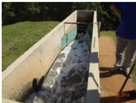
Figura 75 – Saída do efluente tratado
