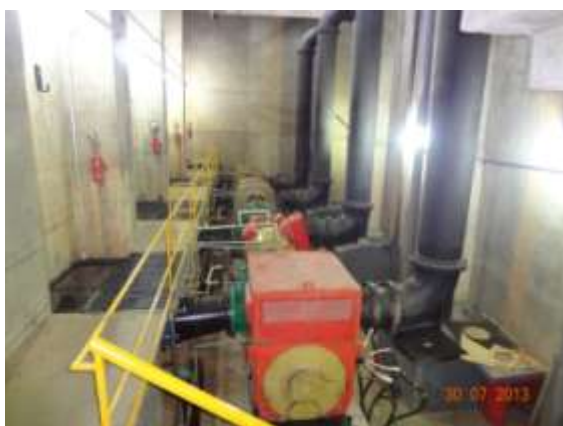
Figura 12 - Recalque da captação III
