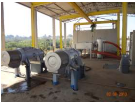
Figura 64 - Casa de desidratação de lodo
