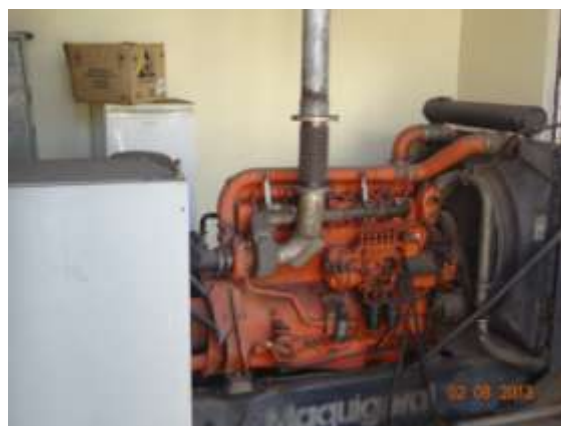
Figura 46 - Grupo gerador desativado
