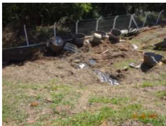
Figura 77 - Detalhe vazamento próximo a Parshall
