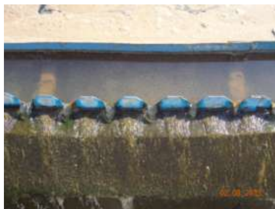
Figura 59 - Detalhe arraste de sólidos decantador
