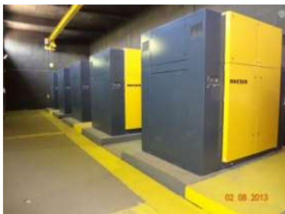
Figura 56 - Sala climatizada de Sopradores
