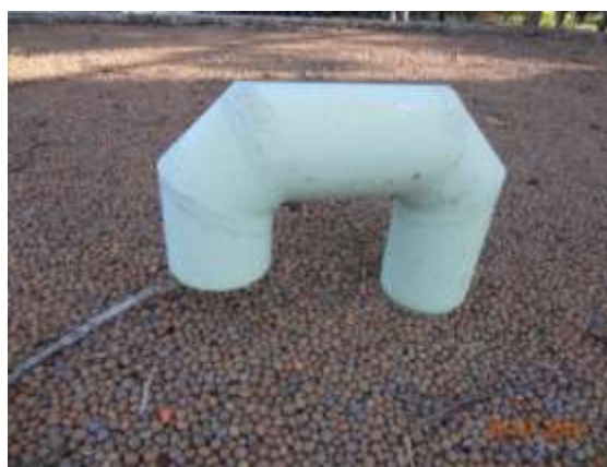
Figura 35 - Detalhe Tubo de ventilação sem tela de proteção
