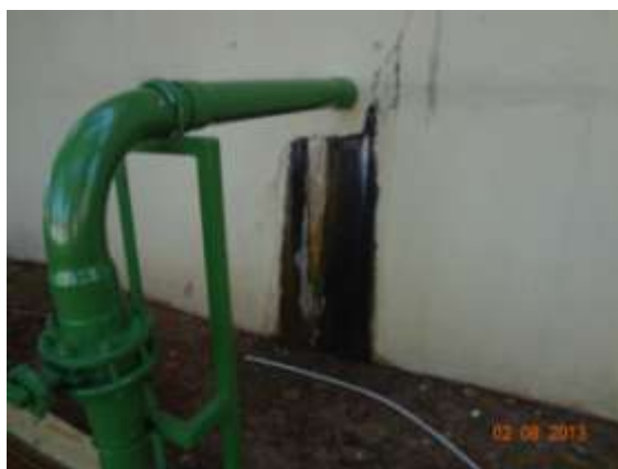
Figura 78 - Detalhe vazamento no tanque UASB
