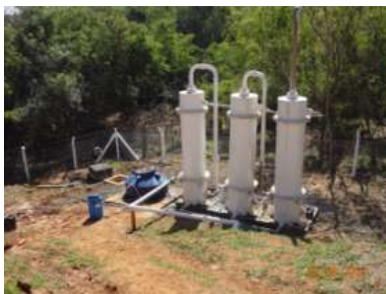
Figura 81 - Lavador de Gases
