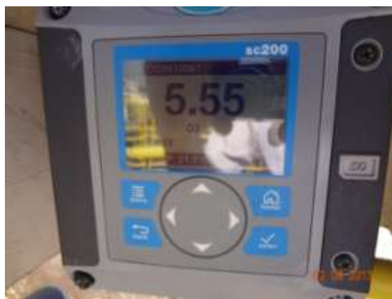
Figura 53 - OD Tanque Aeração (direita)
