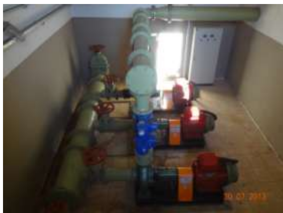
Figura 27 - Equipamentos hidráulicos da estação elevatória
