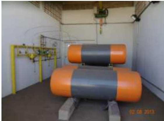
Figura 60 - Cilindros de cloro
