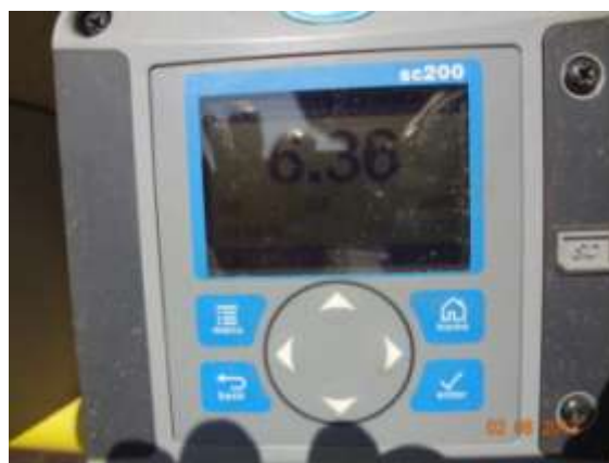
Figura 55 - OD Tanque de Aeração (esquerda)
