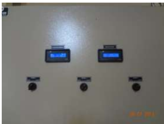
Figura 29 - Macromedicação entrada e saída da elevatória
