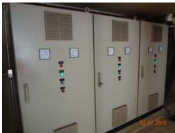
Figura 28 - Quadros elétricos na estação elevatória
