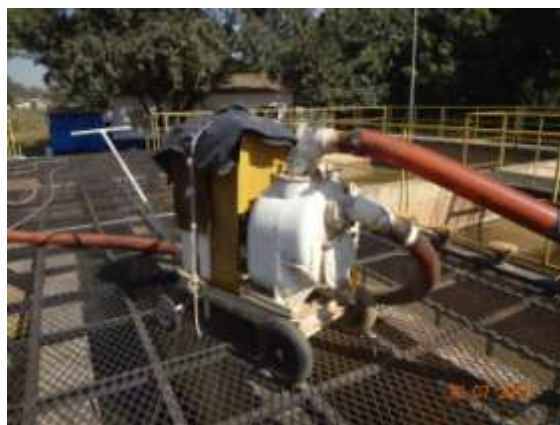
Figura 9 – Bomba para remoção de areia
