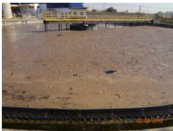
Figura 58 - Vista Superior do decantador
