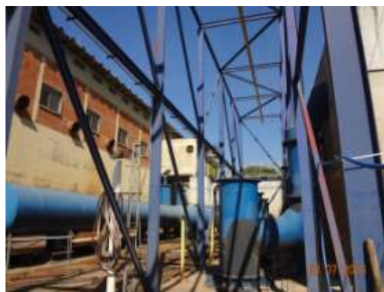
Figura 11 – Captação com bombas submersíveis para desarenadores
