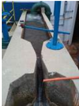
Descrição(2): Chegada da água bruta, medição de vazão e dosagem de coagulante
