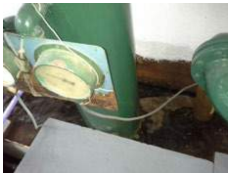
Descrição(7): Vazamento na vedação das válvulas de saída dos filtros
