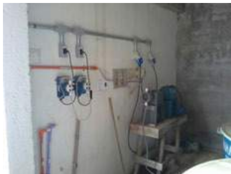
Descrição(8): Dosadoras de Cloro e Ácido Fluorsilícico, com reservas instaladas
