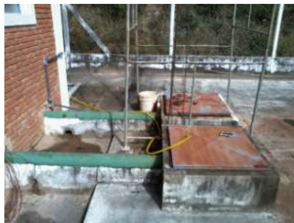
Figura 26 - Tampas de inspeção e tubulação de entrada
