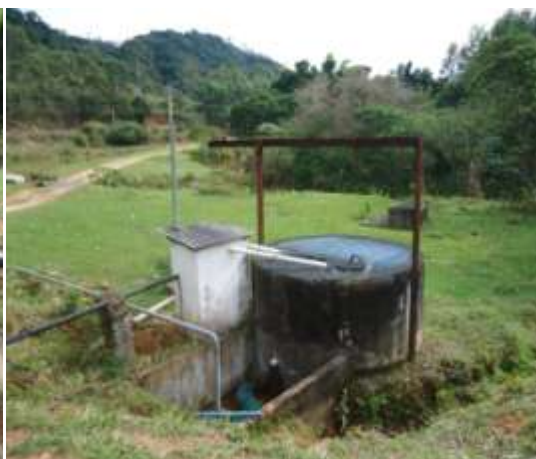
Figura 12 - Equipamentos hidráulicos da captação Recanto I
