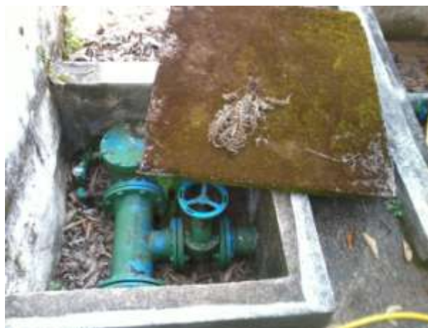
Figura 36 - Válvula de saída Estação elevatória
