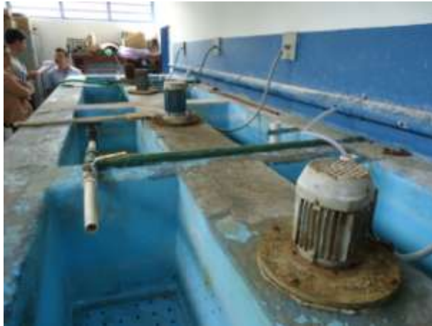
Figura 14 - Tanque de Mistura do coagulante
