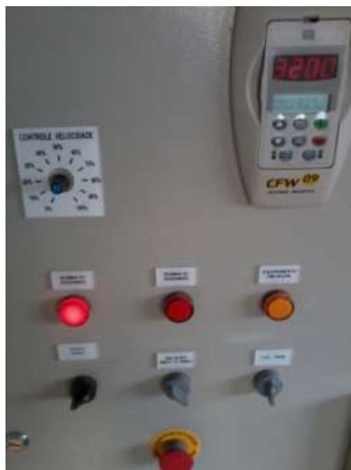
Figura 33 - Equipamentos elétricos da estação elevatória
