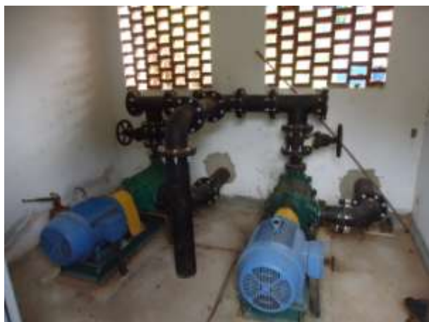
Figura 22 - Equipamentos hidráulicos da estação elevatória
