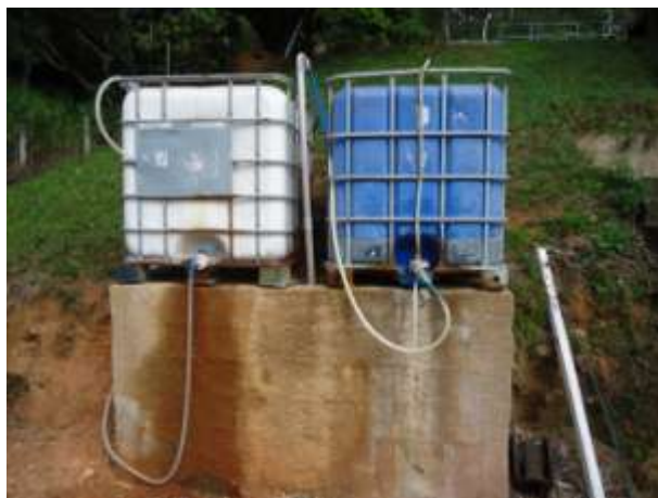
Figura 20 - Dosador de Cloro pós-filtração com vazamento
