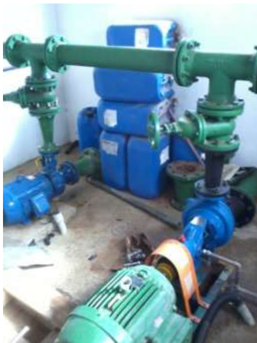
Figura 34 - Equipamentos hidráulicos da estação elevatória
