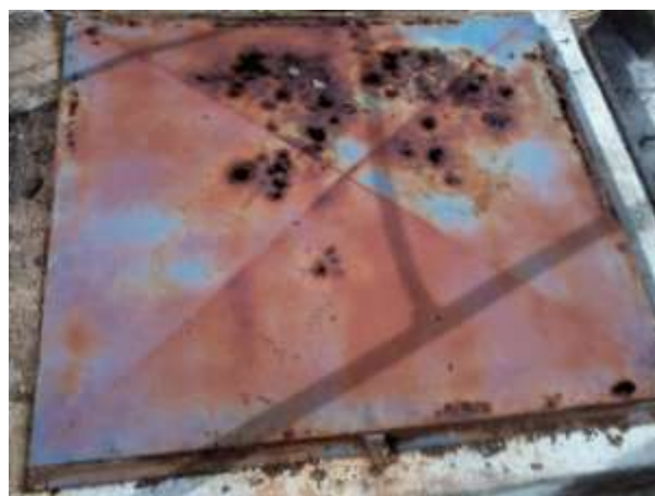
Figura 26 - Detalhe da tampa de inspeção deteriorada
