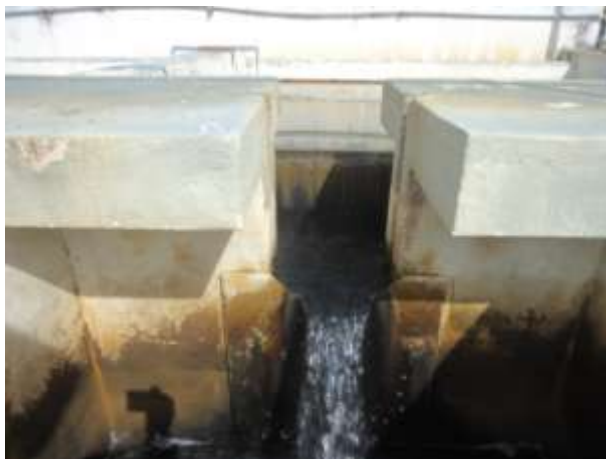
Figura 16 - Saída do decantador
