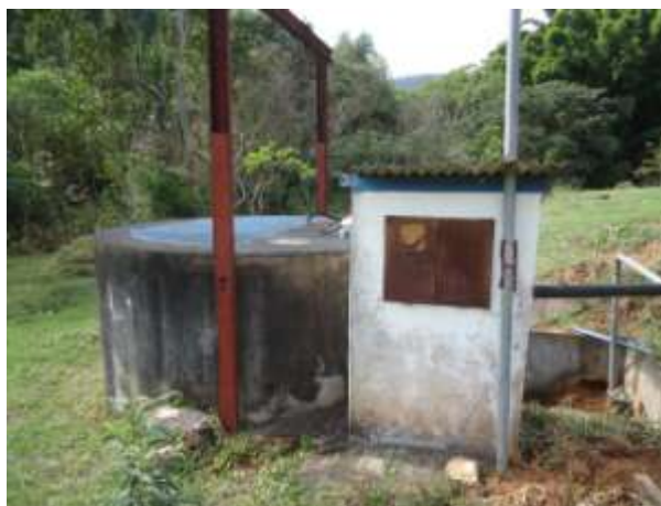
Figura 11 - Adutora de captação de água Recanto I
