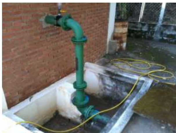
Figura 35 - Tubulações de saída da estação elevatória
