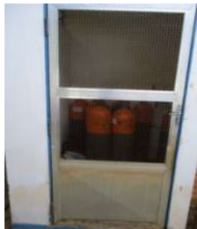
Figura 21 - Armazenamento do gás Cloro
