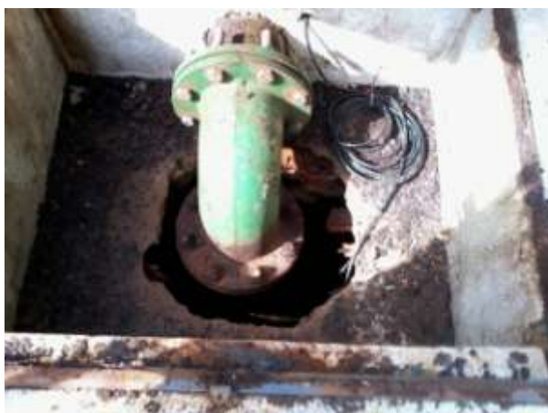
Figura 29- Detalhe da tampa de inspeção deteriorada
