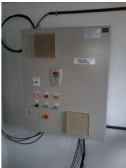
Figura 32 - Equipamentos elétricos da estação elevatória
