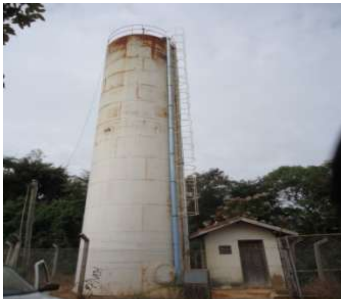
Figura 24: Reservatório Chácara Monte Alegre do Sul
