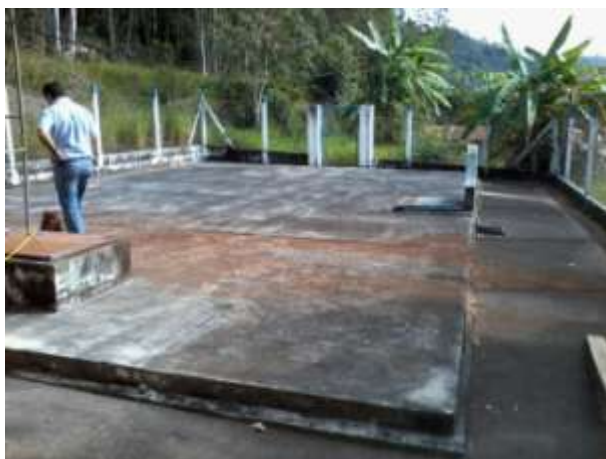
Figura 25 – Reservatório enterrado caixa baixa
