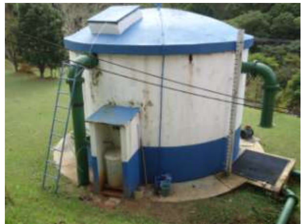
Figura 17 - Tanque de contato onde é feita dosagem de Cloro e Flúor
