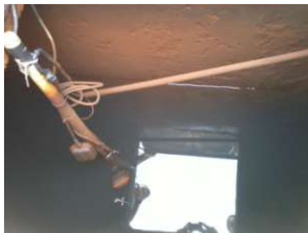
Figura 25 - Detalhe do interior do reservatório enterrado
