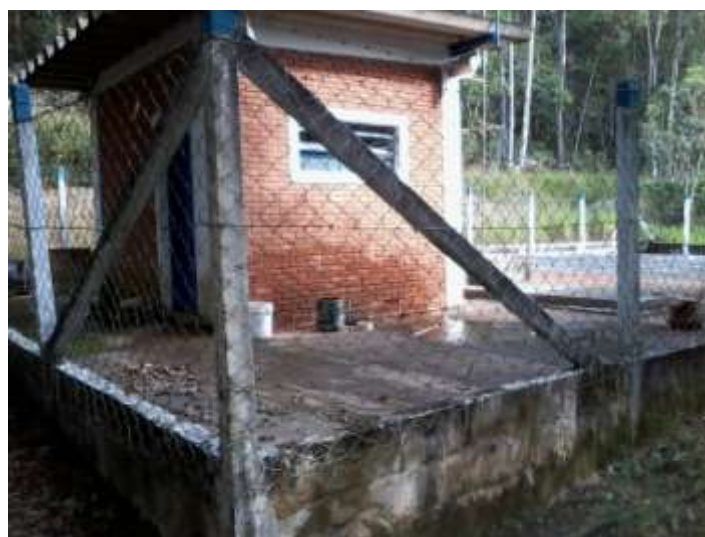
Figura 27 - Estação Elevatória de Água
