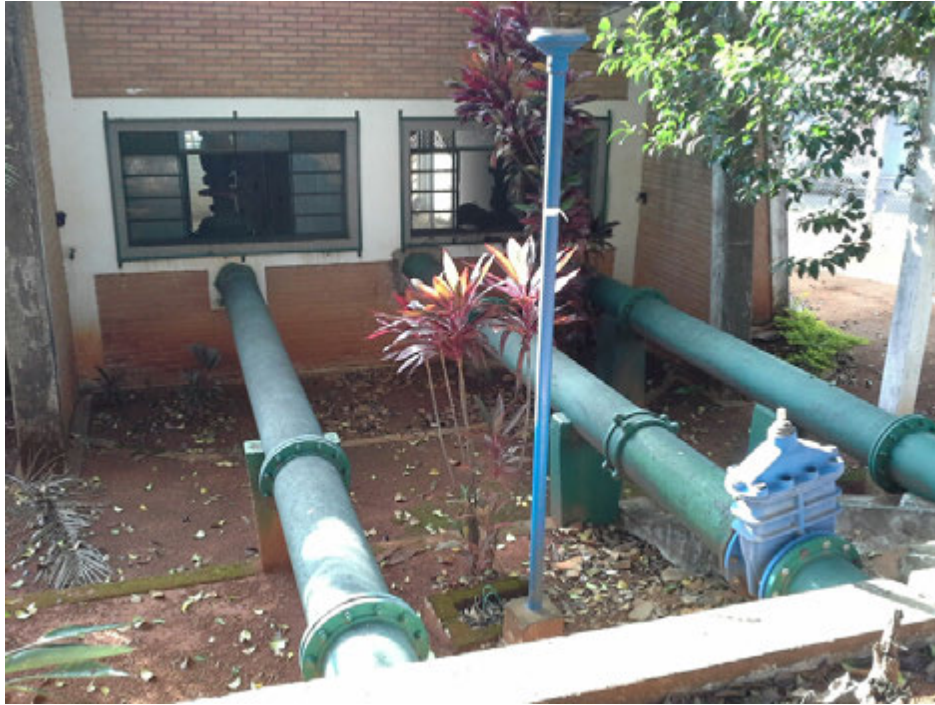
Descrição(5): Tubulação de sucção das bombas
