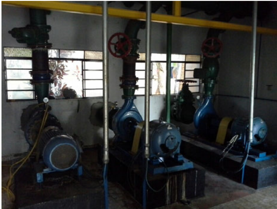
Descrição(3): Conjuntos de recalque Imagem(4)
