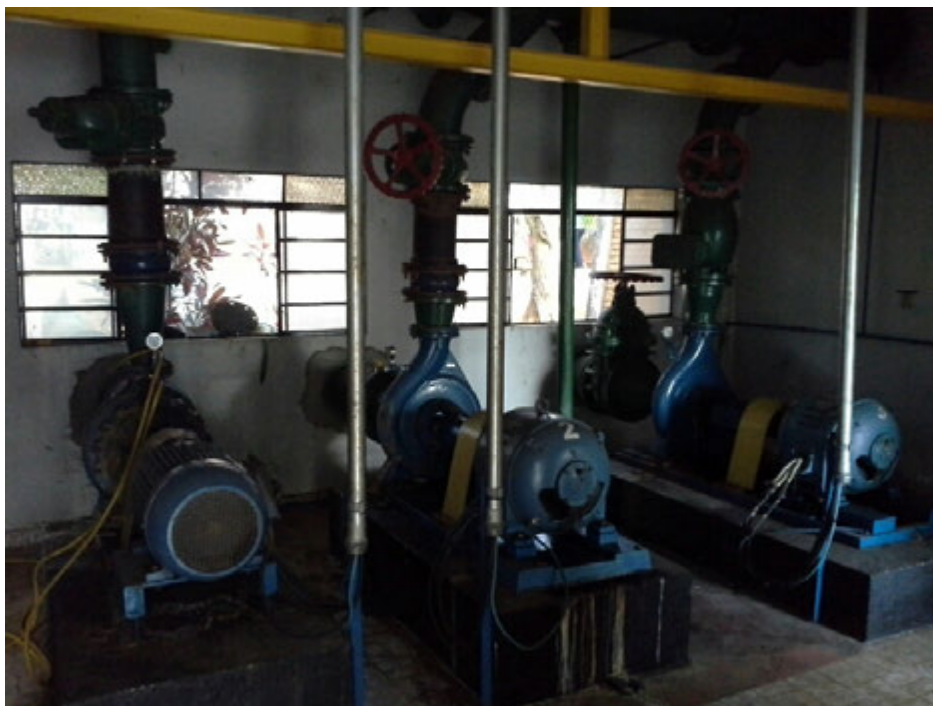
Descrição(3): Conjuntos de recalque Imagem(4)
