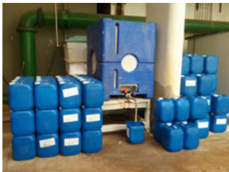
Descrição(9): Armazenamento de ortopolifosfato
