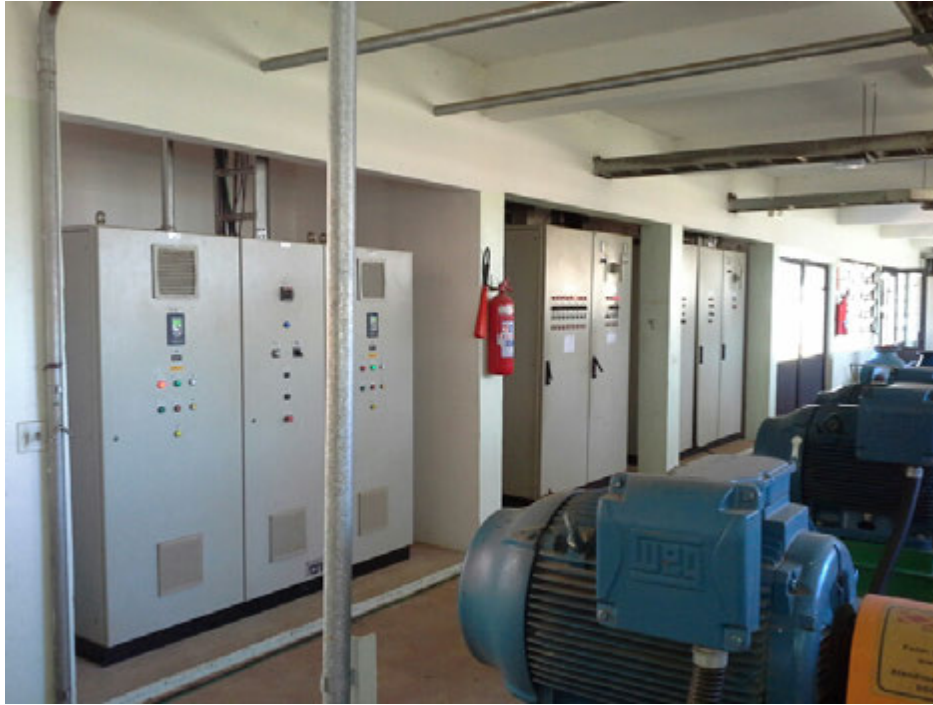
Descrição(2): Paineis elétricos e extintores de incêndio
