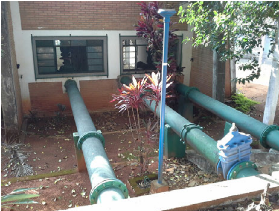
Descrição(5): Tubulação de sucção das bombas
