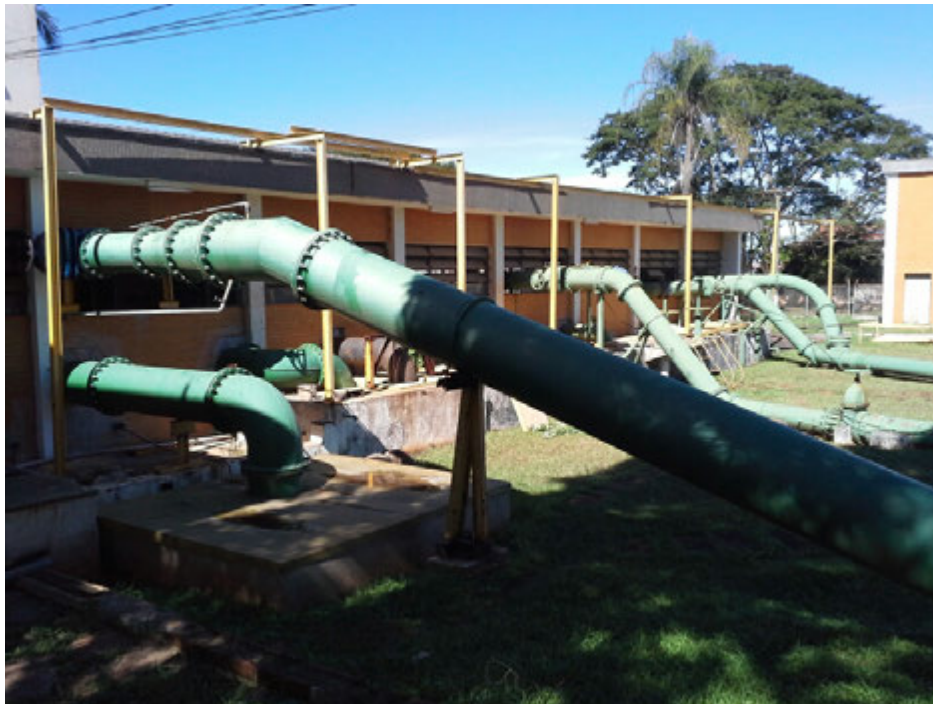
Descrição(3): Tubulações de recalque
