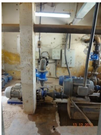
Figura 14 - bombas de recalque da água bruta
