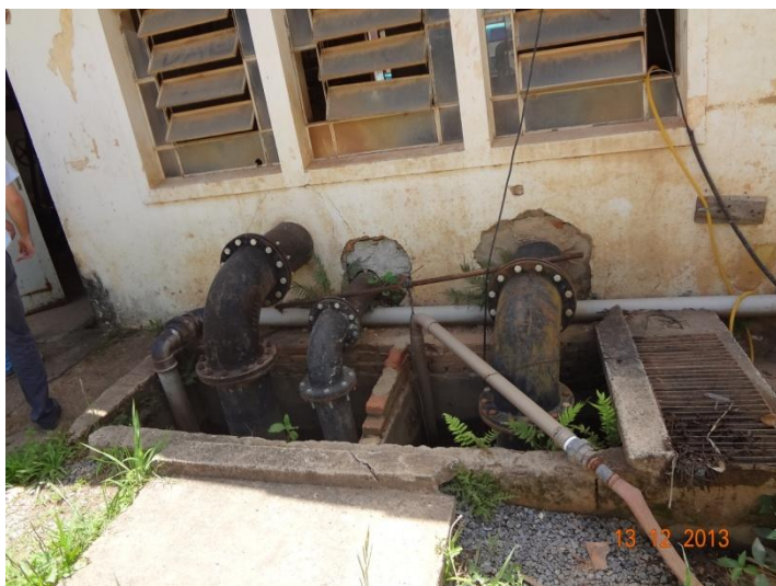
Figura 12 - Tubulação de entrada da água bruta
