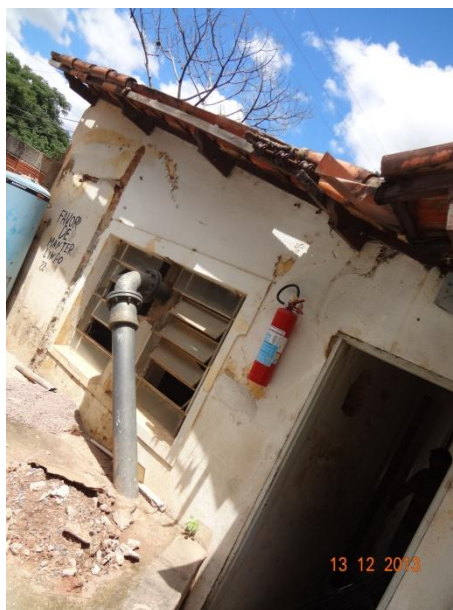
Figura 23 – Estação Elevatória de Água
