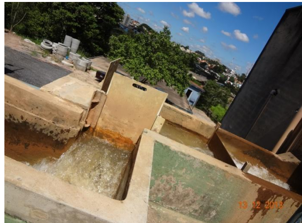
Figura 18 - Saída da calha Parshall
