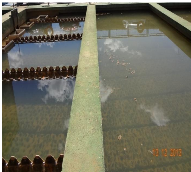
Figura 22 - Decantador e calha de condução da água aos filtros
