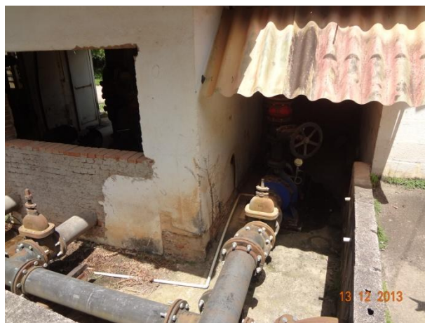
Figura 15 - Tubulação de entrada da água bruta
