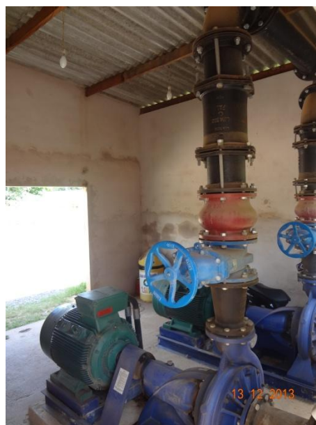
Figura 25 - Elevatória de água tratada
