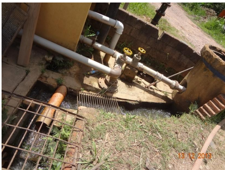
Figura 10 - Chegada da água bruta
