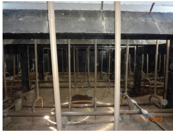
Figura 30 - Interior do reator anaeróbio
