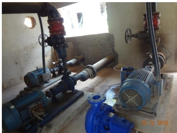
Figura 13 - Bombas de recalque da água bruta
