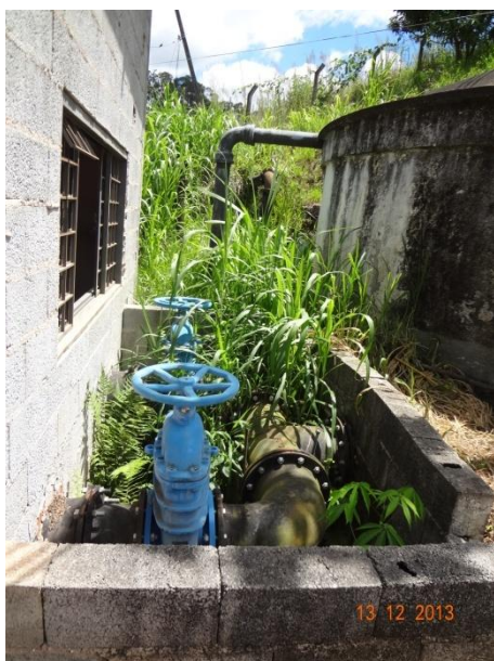
Figura 24 - Registro de entrada da água tratada
