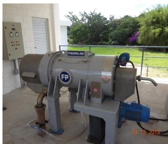
Figura 34 - Centrífuga (desidratação do lodo)
