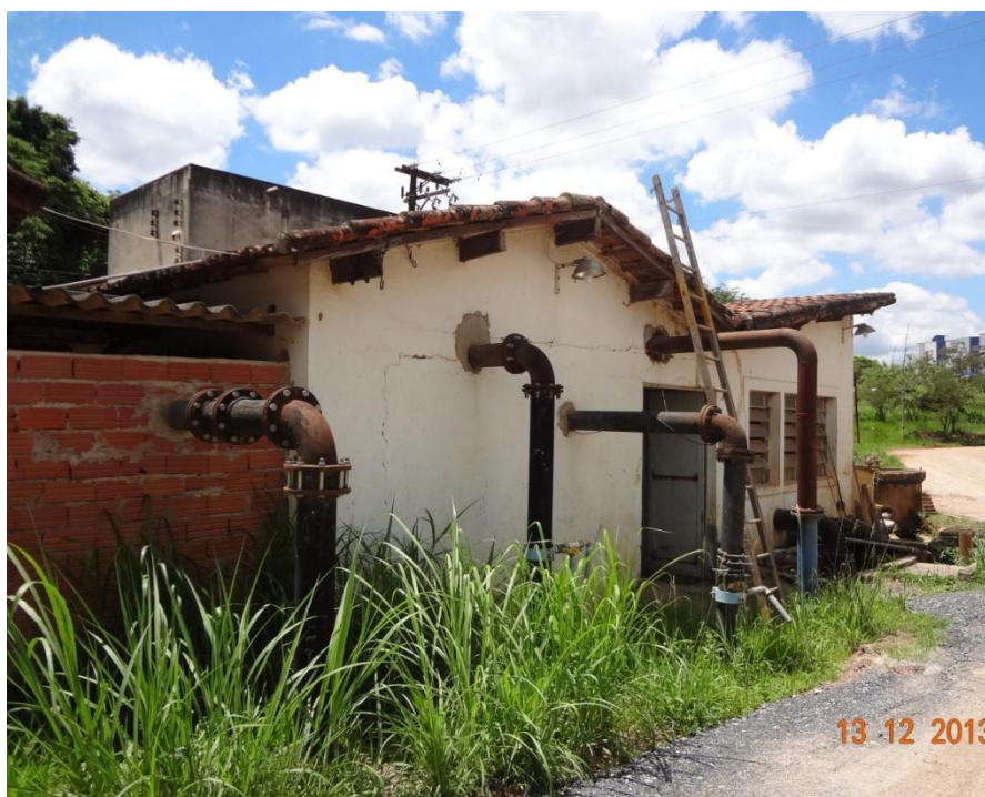
Figura 9 - Estação de captação de água do Córrego Fetá
