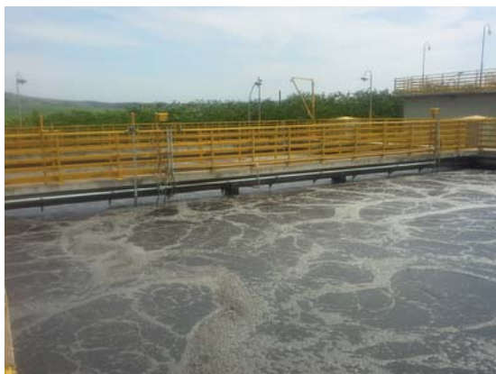
Descrição(8): Tanque aeração
