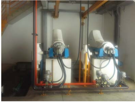
Descrição(6): Desidratação Lodo (centrífugas)
