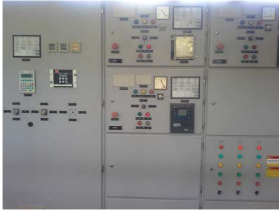
Descrição(3): Paineis elétricos
