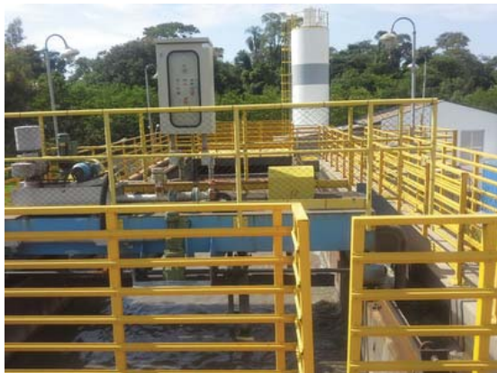
Descrição(5): Desarenador com remoção de gordura
