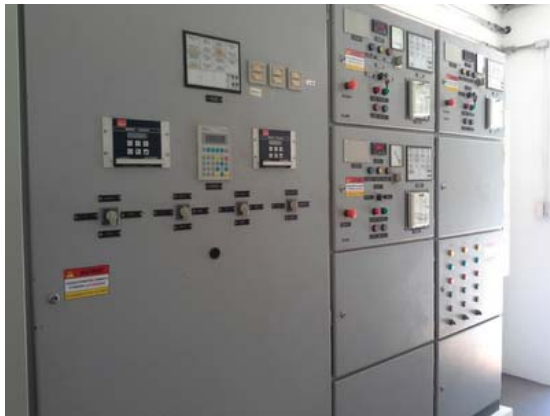
Descrição(6): Paineis elétricos
