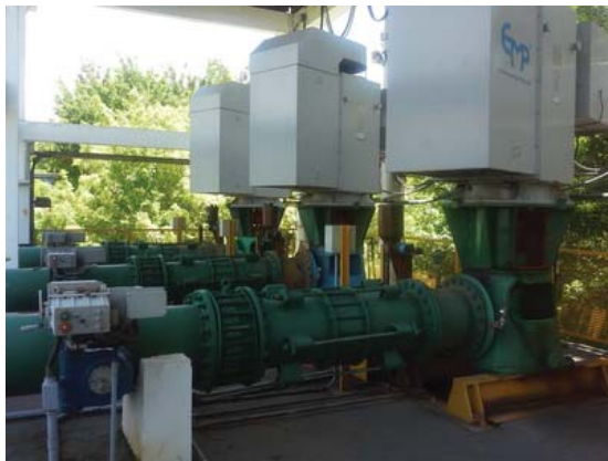
Descrição(4): Conjuntos de recalque
