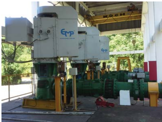
Descrição(3): Conjuntos de recalque
