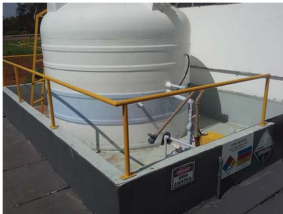
Descrição(10): Lavador de gases
