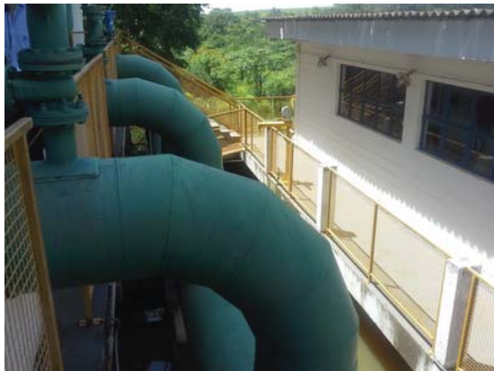
Descrição(6): Barrilete de recalque
