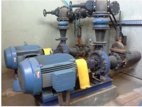
Descrição(3): Bombas 1 e 2
