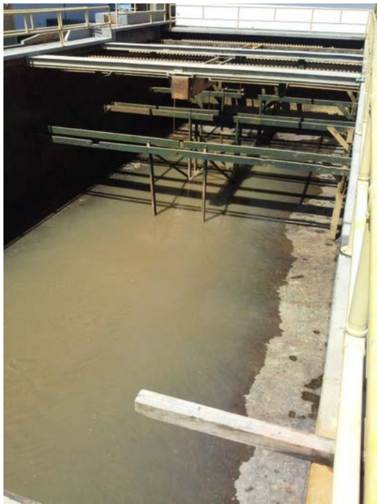
Descrição(5): Decantador após lavagem
