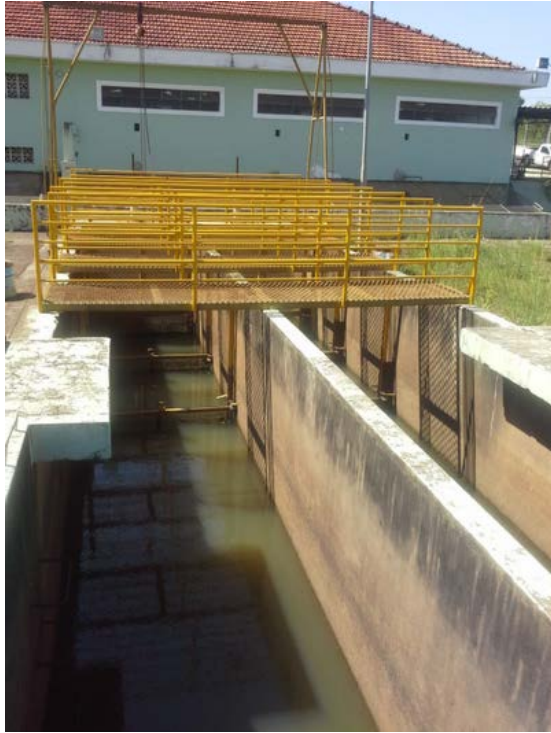
Descrição(2): Caixa de areia
