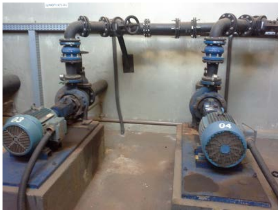
Descrição(4): Bombas 3 e 4
