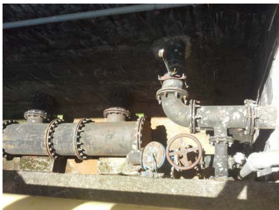
Descrição(5): Barrilete de saída e válvula de alívio
