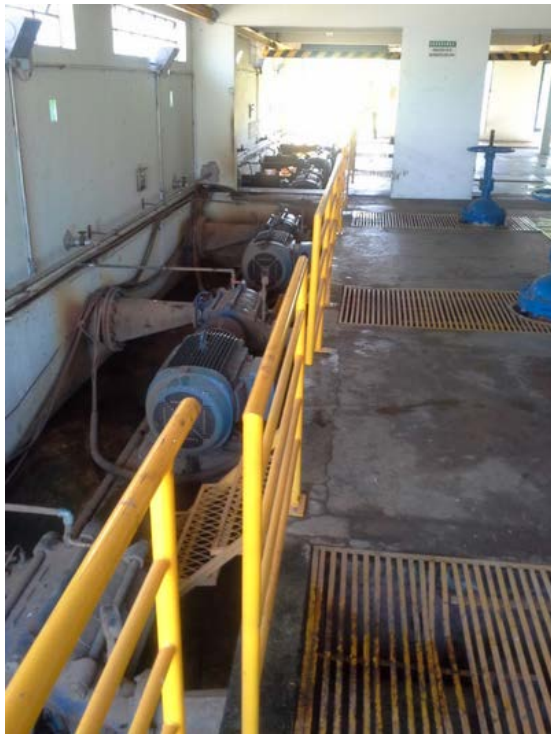
Descrição(6): Conjuntos de recalque
