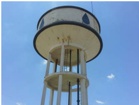
Descrição(4): Elevado 150m3
