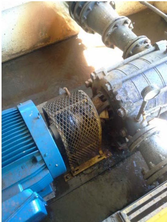
Descrição(9): Gaxeta com vazamento excessivo
