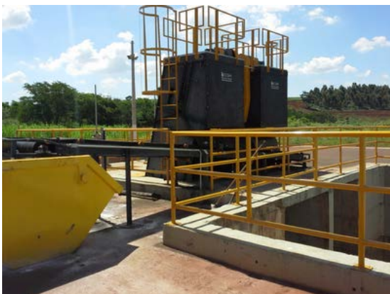
Descrição(9): Gradeamento grosseiro
