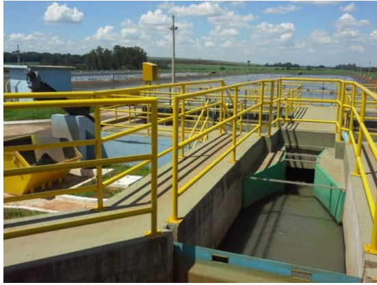
Descrição(4): Calha Parshall e lagoas
