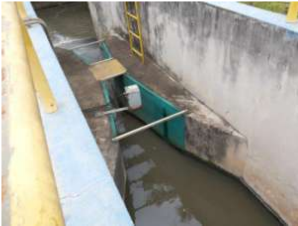
Figura 67 - Entrada do efluente com medidor Parshall e dispositivo ultrassônico
