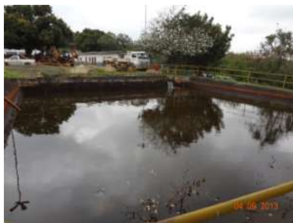
Figura 46 - Lagoa de decantação do efluente de lavagem de filtros e decantadores
