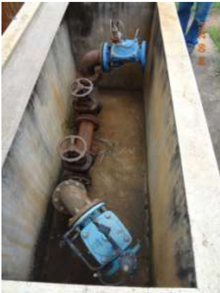
Figura 49 - Tubulação de entrada de um dos módulos da estação elevatória
