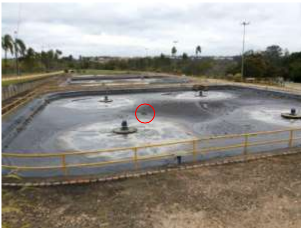
Figura 75 - Zona morta no tanque de aeração
