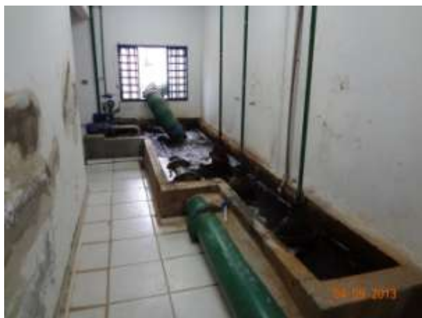
Figura 47 - Tanque de passagem
