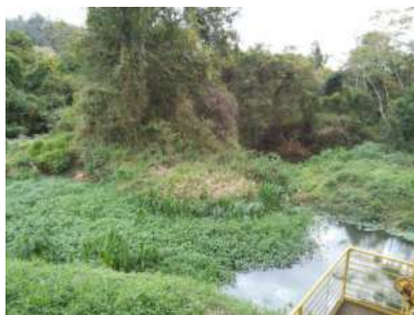
Figura 8 - Presença de plantas e assoreamento da tomada de água
