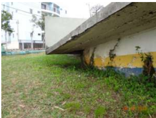
Figura 62 - Rachaduras no reservatório
