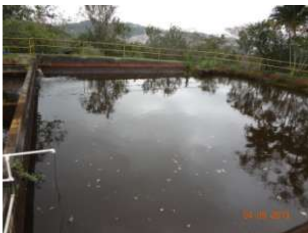
Figura 45 - Lagoa de decantação do efluente de lavagem de filtros e decantadores
