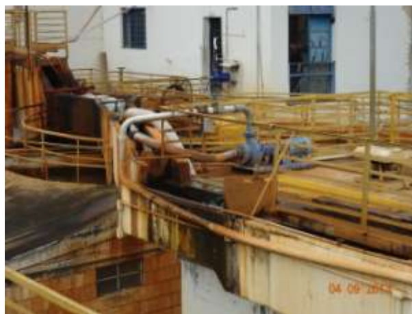
Figura 36 - Entrada do efluente visto da ETA módulo 4
