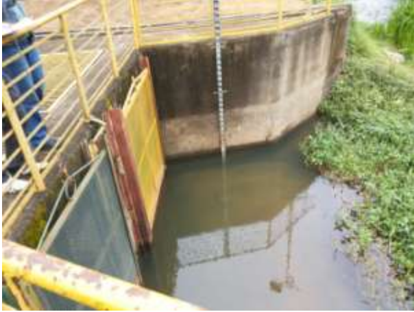
Figura 10 - Tela de retenção de sólidos grosseiros e aparente assoreamento local
