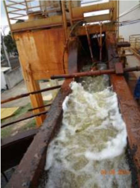
Figura 27 - Dosagem de produtos na calha Parshall (detalhe para o extravasamento da água)
