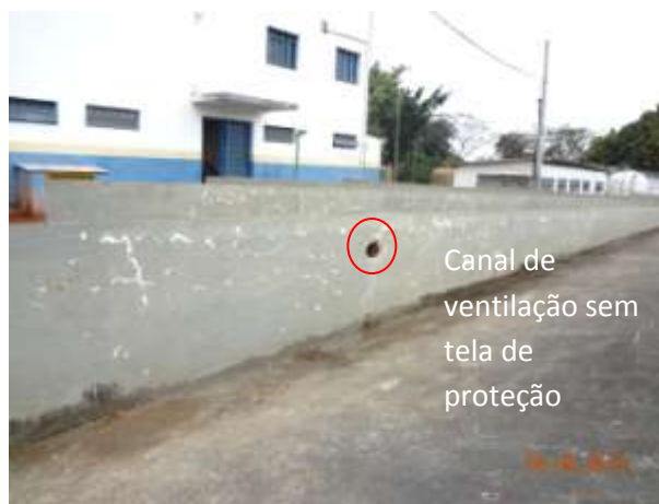
Figura 61 - Canal de ventilação sem tela de proteção
