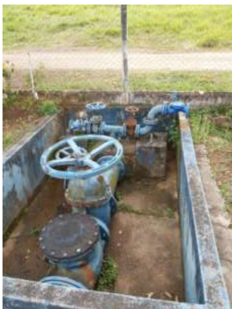
Figura 22 - Tubulação de saída da captação com sistema anti golpe
