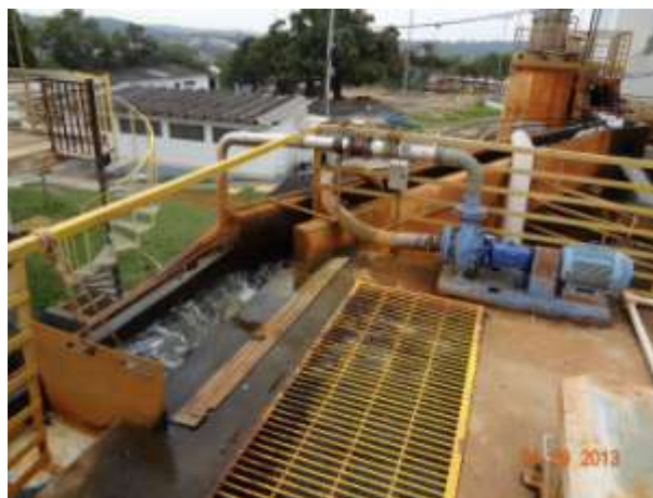
Figura 32 - Bomba que destina a água para o módulo 4
