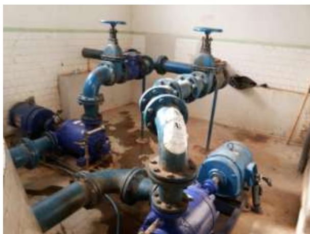
Figura 16 - Conjunto moto-bomba sem a proteção de segurança do eixo
