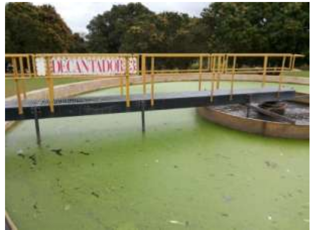
Figura 74 - Decantador com grande presença de algas
