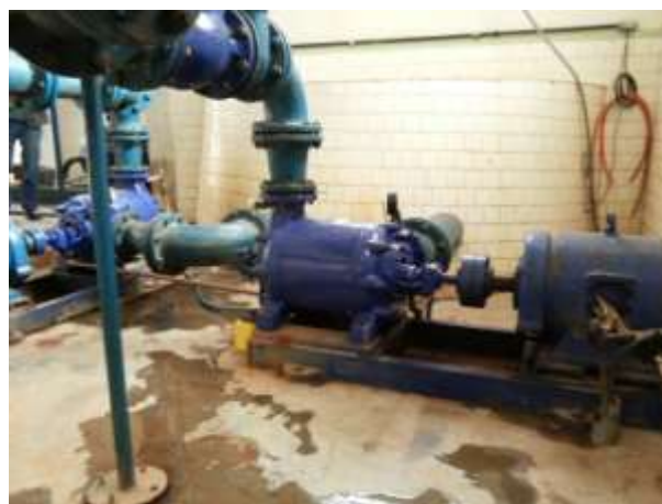
Figura 17 - Conjunto moto-bomba sem a proteção de segurança do eixo
