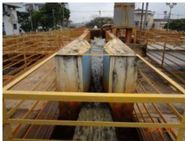
Figura 38 - Calha Parshall do módulo 4
