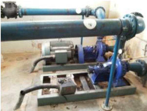
Figura 20 - Conjunto moto-bomba, com motor reserva retirada para manutenção
