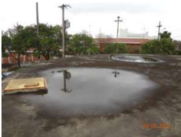
Figura 58 - Acúmulo de água na parte superior do reservatório
