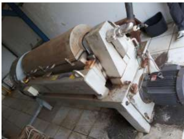
Figura 81 - Centrífuga de desidratação do lodo (inoperante no momento da fiscalização)
