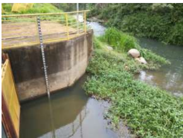
Figura 7 - Presença de plantas e assoreamento da tomada de água
