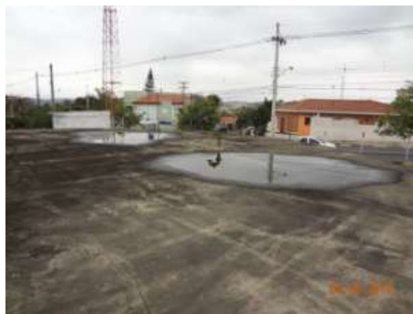
Figura 59 - Acúmulo de água na parte superior do reservatório
