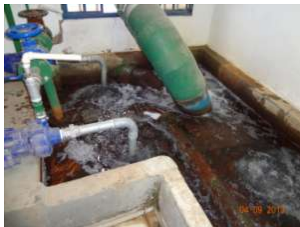
Figura 48 - Tanque de passagem
