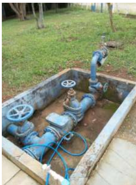
Figura 23 - Tubulação de saída da captação com sistema anti golpe
