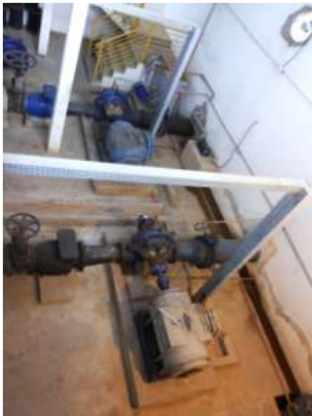
Figura 12 - Bombas Aspiradas, sendo uma reserva
