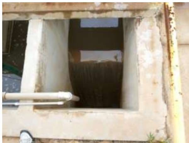
Figura 80 – Saída da chicana para o poço de aeração, com adição de cloro
