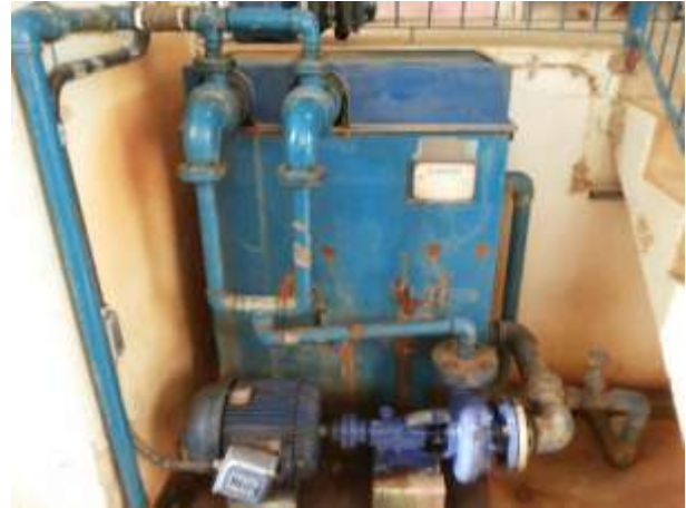
Figura 19 - Escorva com moto-bomba sem a proteção de segurança do eixo
