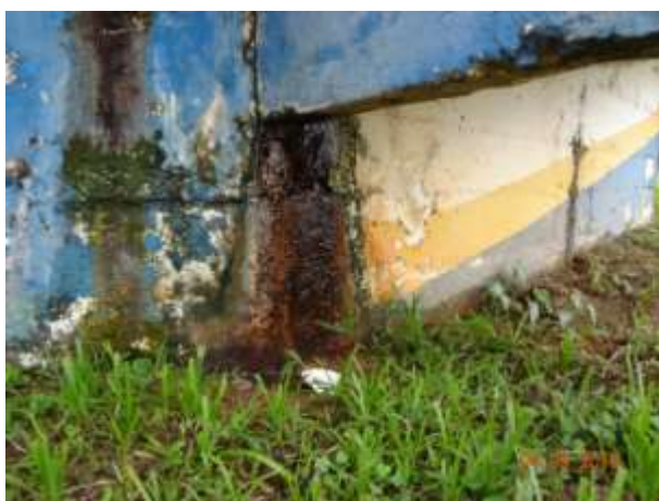
Figura 60 - Rachaduras no reservatório
