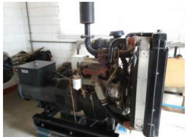
Figura 70 – Grupo gerador de energia elétrica
