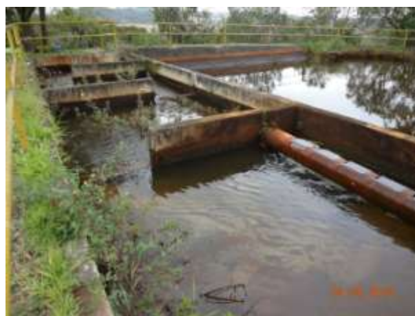
Figura 44 - Lagoa de decantação do efluente de lavagem de filtros e decantadores
