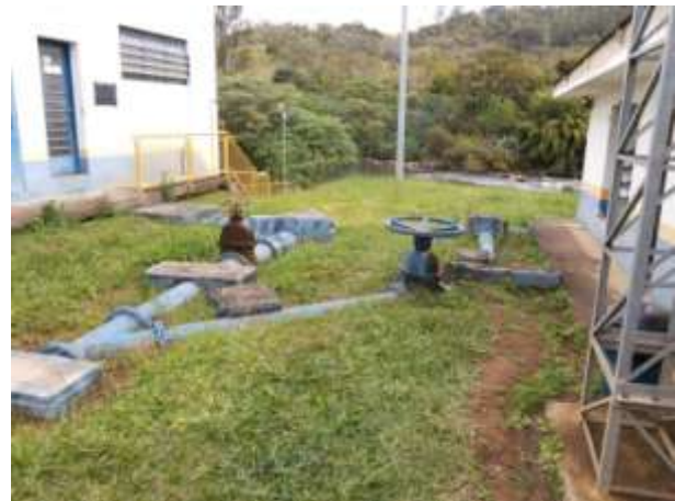
Figura 21 - Tubulações de saída
