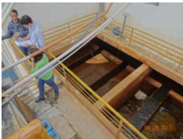
Figura 31 - Filtros em processo de lavagem
