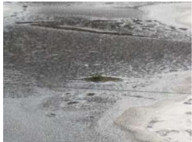
Figura 76 - Detalhe do crescimento de plantas no tanque de aeração
