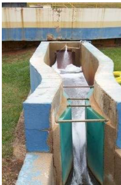
Figura 78 - Calha Parshall da saída do decantador
