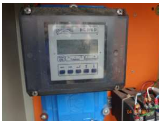
Figura 54 - Painel do Macromedidor
