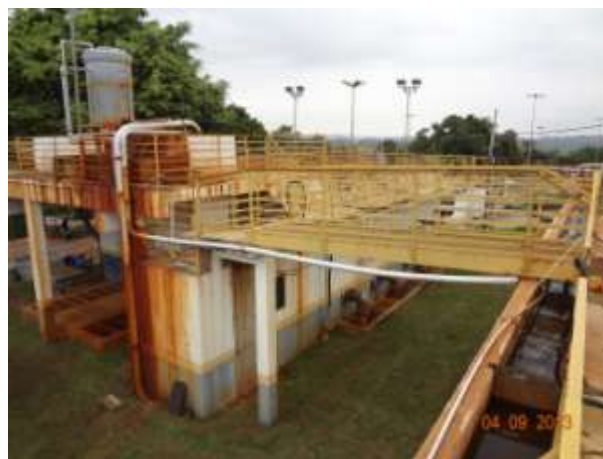
Figura 42 - Detalhe do transbordamento de produtos no módulo 4 da ETA
