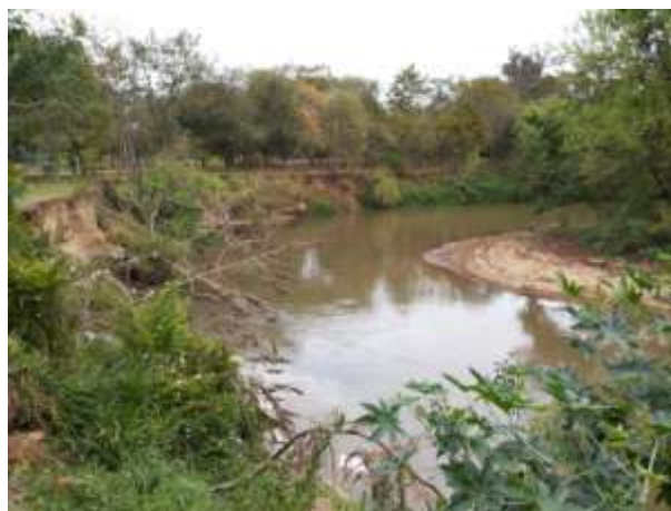
Figura 82 - Erosão aparente próximo a saída do efluente
