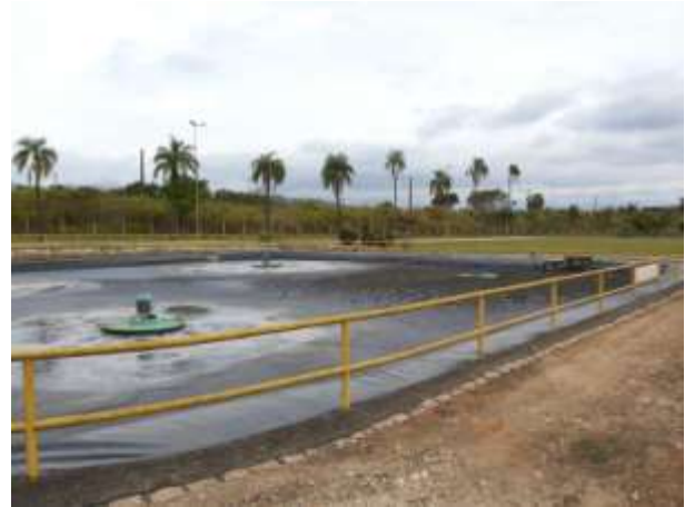
Figura 72 - Aerador com dispositivo inoperante
