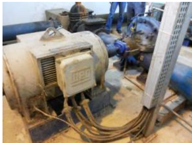
Figura 13 - Conjunto moto-bomba sem a proteção de segurança do eixo
