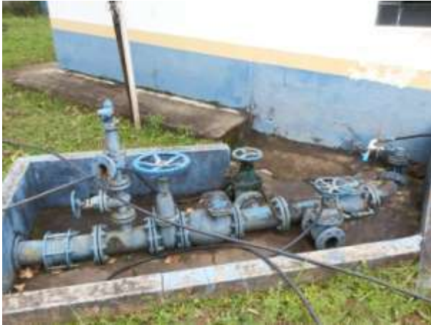
Figura 18 - Tubulação de saída com dispositivos de proteção
