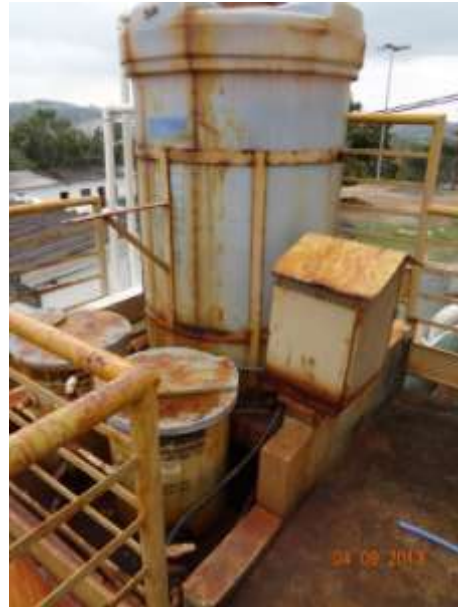
Figura 28 - Armazenamento de produtos químicos
