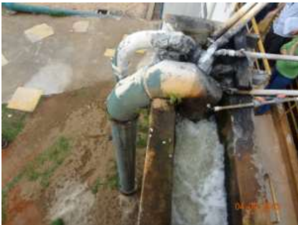
Figura 25 - Entrada da água de recirculação e dosagem de produtos químicos
