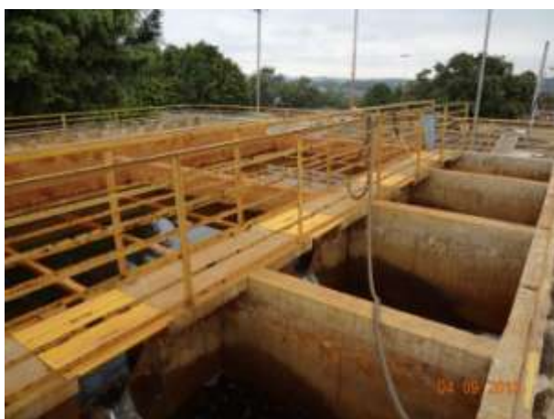
Figura 43 - Passagem do decantador para o filtro no módulo 4
