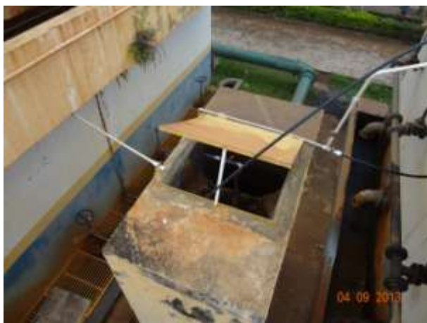
Figura 35 - Tanque de contato
