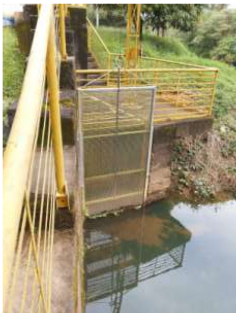
Figura 14 - Tela de retenção de sólidos grosseiros e aparente assoreamento local
