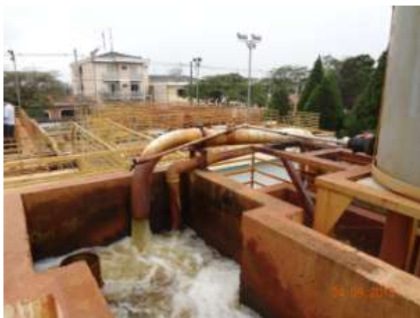
Figura 37 - Entrada da água bruta no módulo 4
