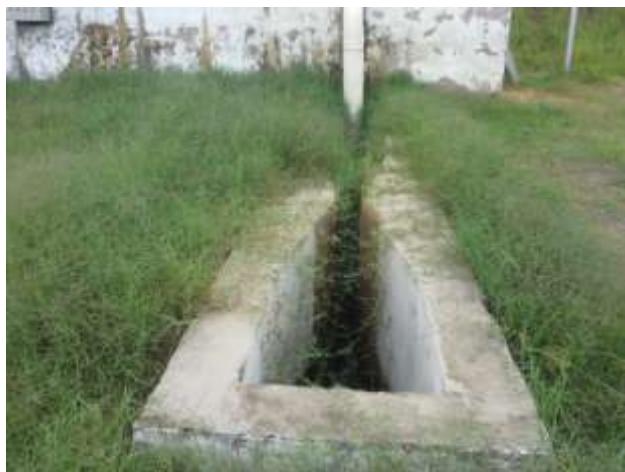
Descrição(14): Calha Parshal (saída esgoto tratado)
