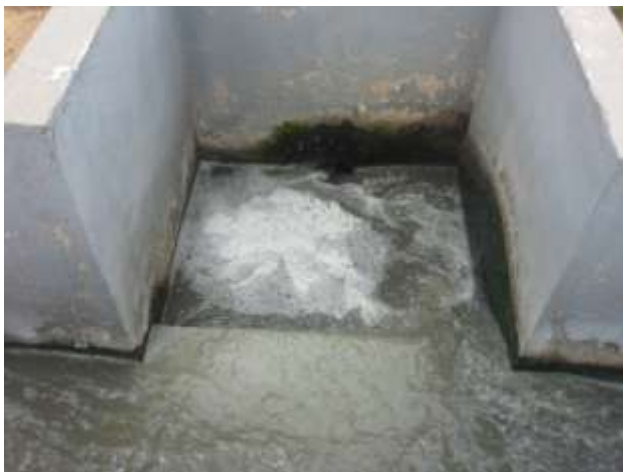
Descrição(11): Chegada de esgoto na Lagoa Facultativa
