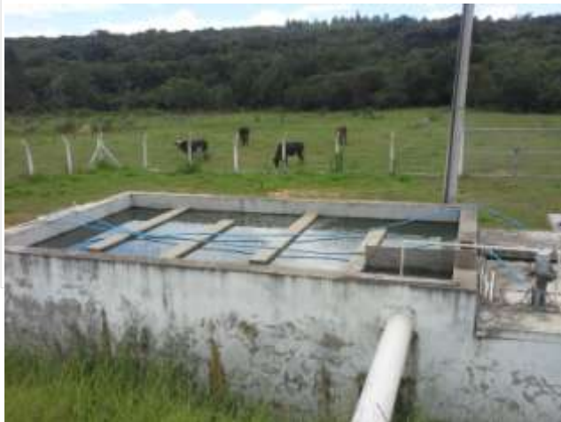
Descrição(13): Tanque contato
