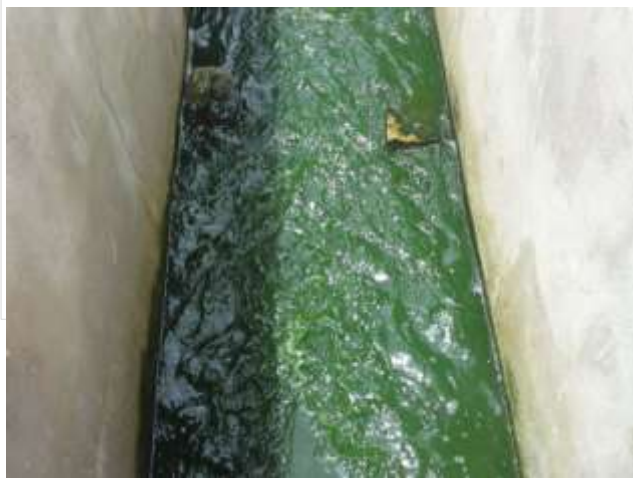
Descrição(16): Detalhe esgoto tratado
