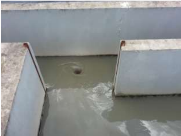
Descrição(9): Chegada esgoto bruto na lagoa Anaeróbia
