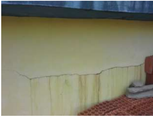
Descrição(3): Detalhe fissuras do reservatório apoiado
