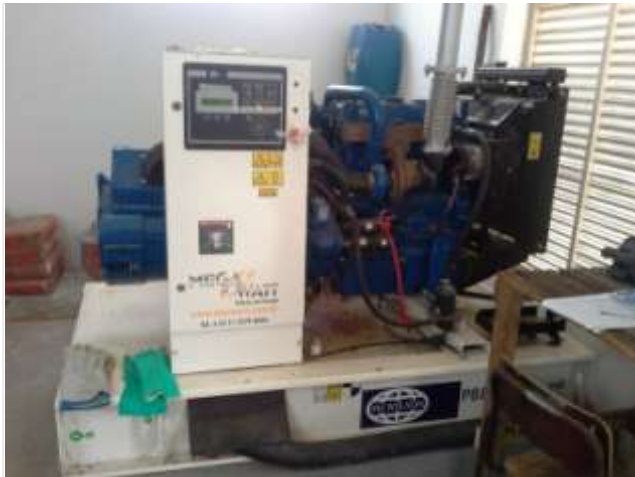
Descrição(6): Gerador de energia
