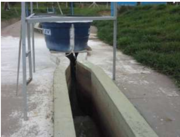
Descrição(4): Sistema de dosagem de cal
