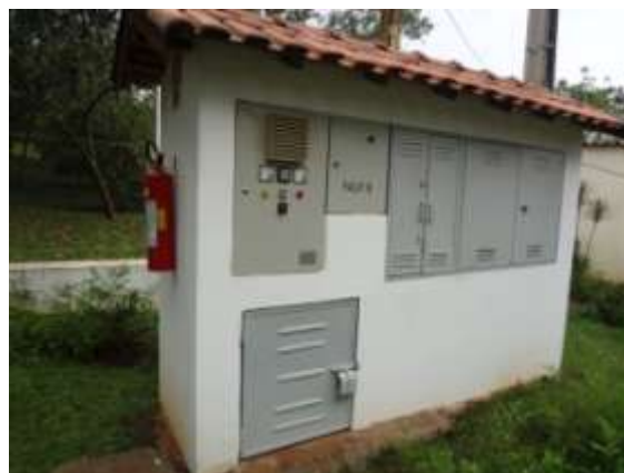
Figura 8 - Painel elétrico e extintor de incêndio
