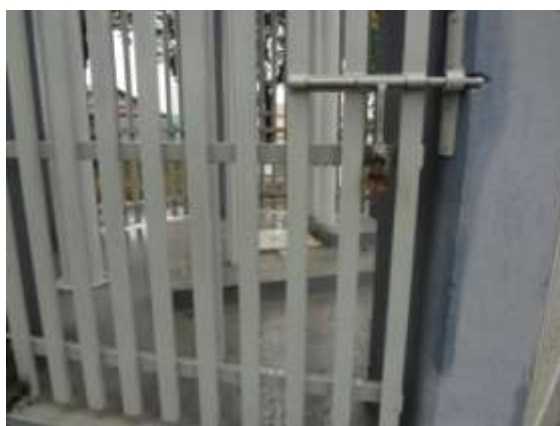
Figura 14 - Fechamento adequado do reservatório elevado
