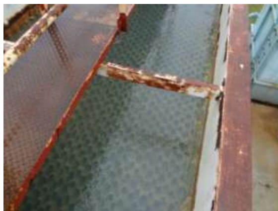
Figura 24 - Decantador do módulo em aço
