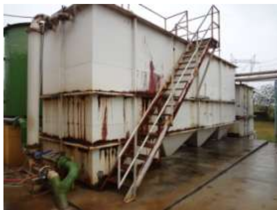
Figura 17 - Módulo compacto de tratamento em aço
