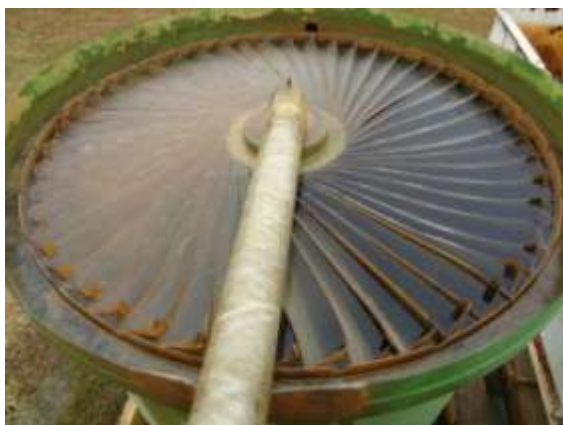
Figura 23 - Decantador do módulo em PRFV
