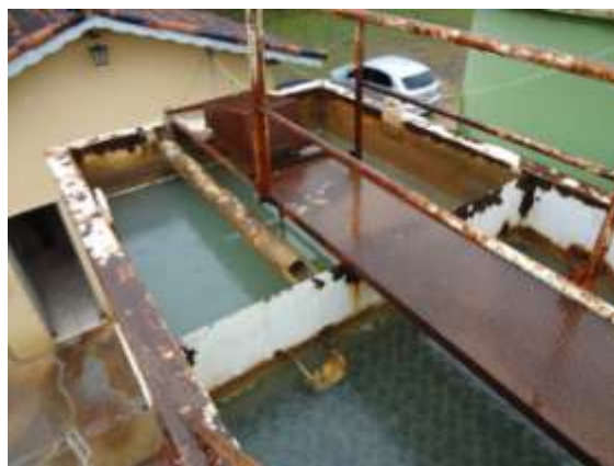
Figura 20 - Ausência de guarda-corpo e corrosão nos existentes
