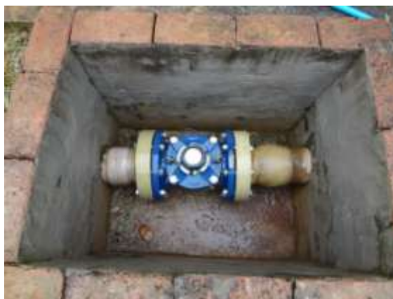
Figura 18 - Macromedidor de saída da ETA
