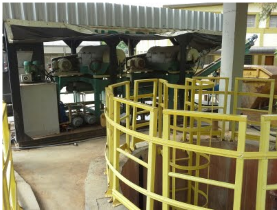
Descrição(10): Adensador e desidratação de lodo por centrifugação
