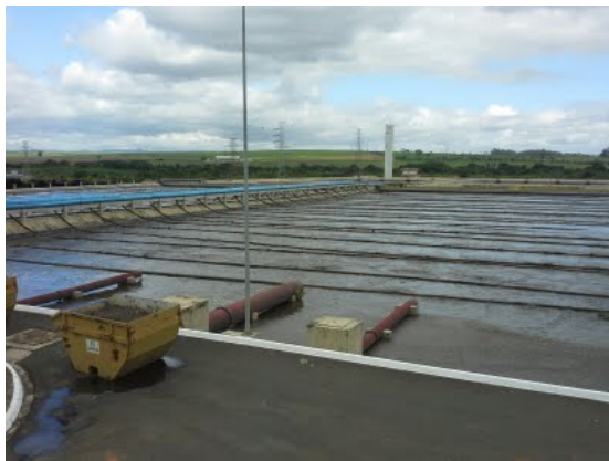
Descrição(4): Tanques de aeração
