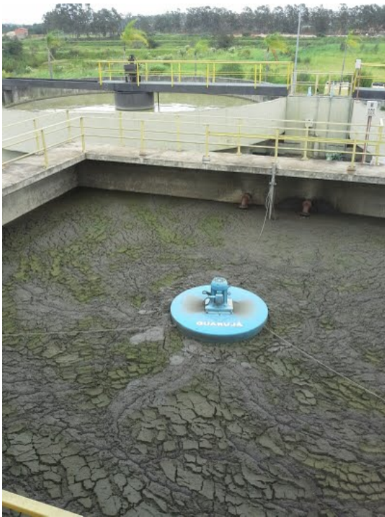
Descrição(9): Adensador de lodo
