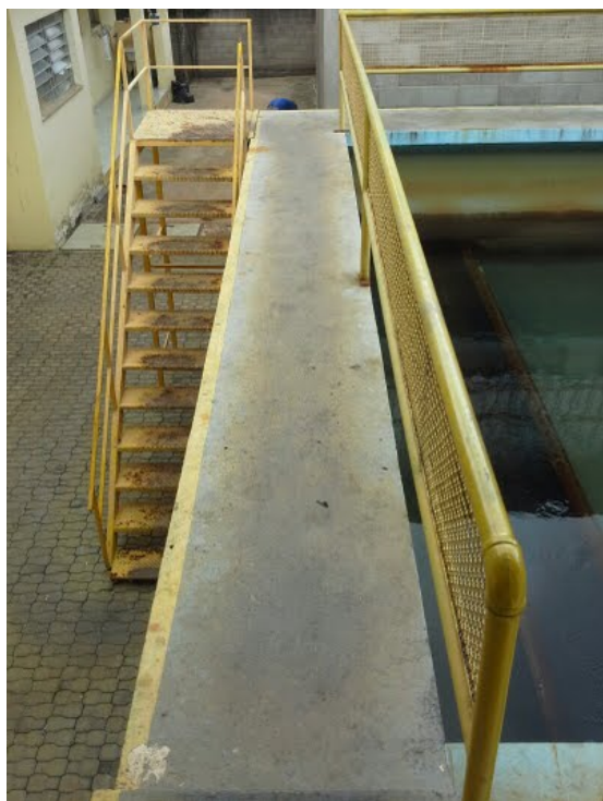
Descrição(12): Passadiço sem guarda-corpo
