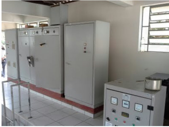
Descrição(5): Paineis elétricos
