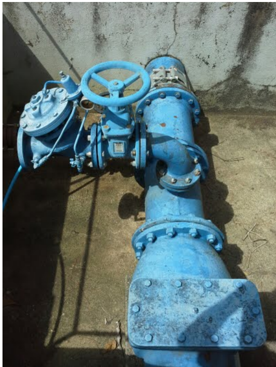
Descrição(8): Barrilete de recalque e antecipadora de ondas
