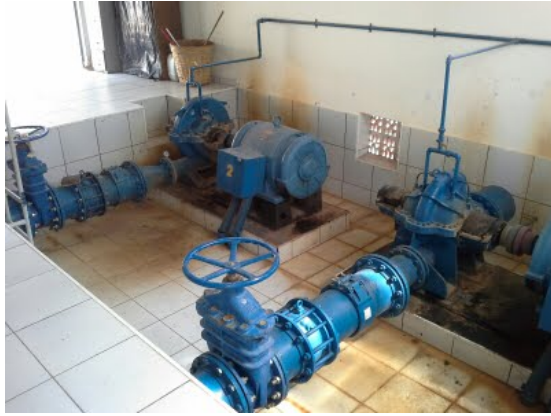
Descrição(3): Conjuntos de recalque
