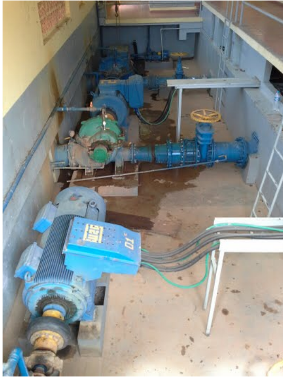
Descrição(5): Conjuntos de recalque
