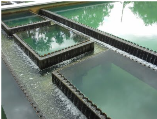
Descrição(5): Saída da água decantada
