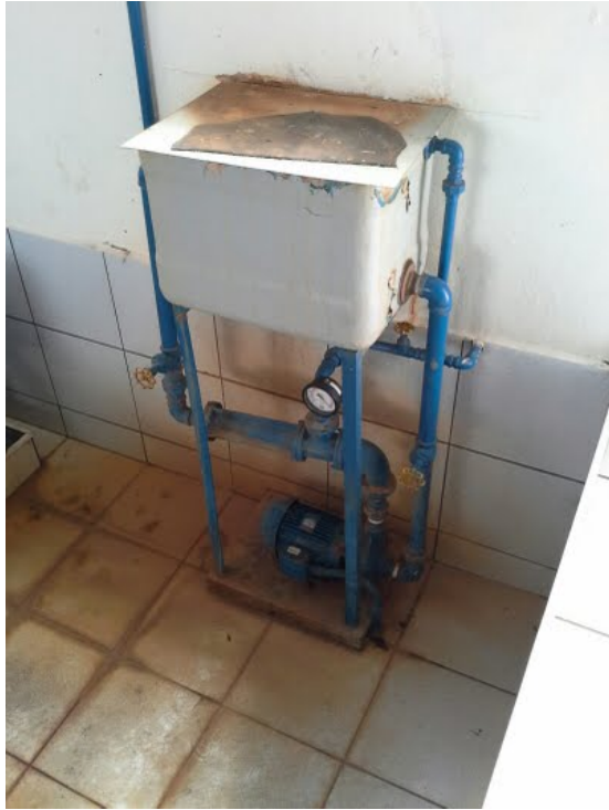
Descrição(7): Sistema de escorva das bombas
