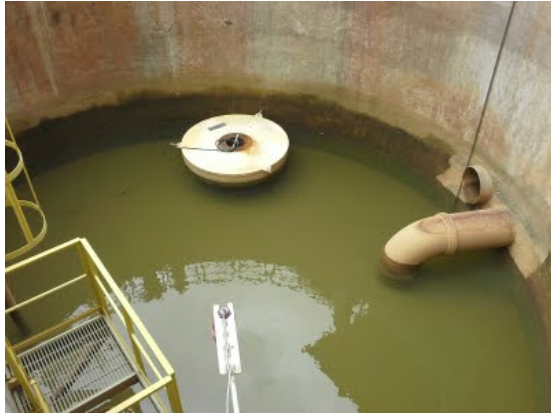
Descrição(9): Tanque de água de reuso da decantação e filtração
