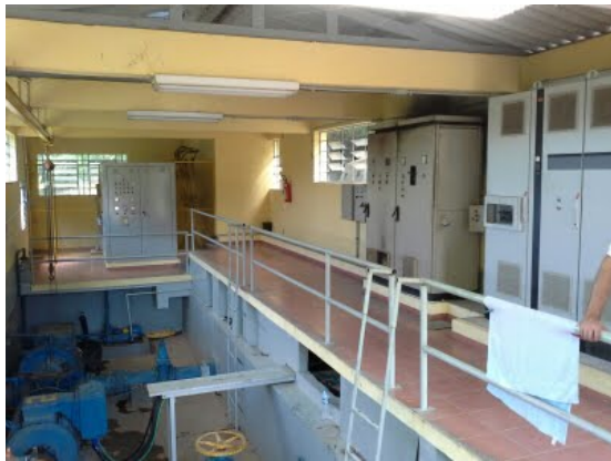
Descrição(6): Paineis elétricos e extintores de incêndio
