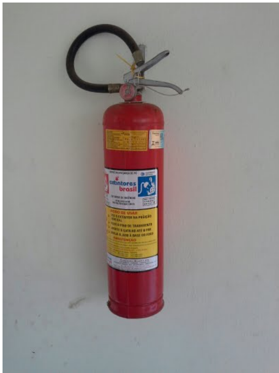
Descrição(6): Extintor de incêndio
