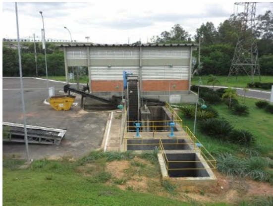
Descrição(13): Estacao elevatória de esgoto bruto, com gradeamento grosseiro em manutenção na ocasião da inspeção
