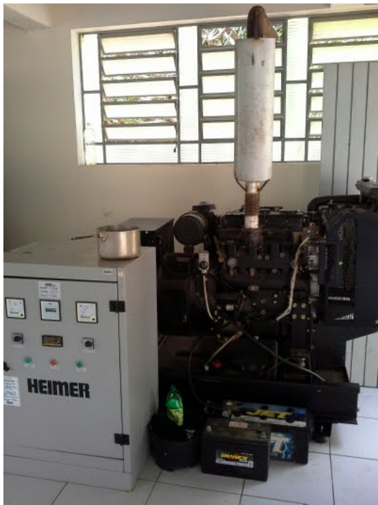
Descrição(4): Grupo gerador
