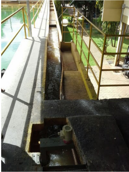
Descrição(2): Medição de vazão e mistura rápida
