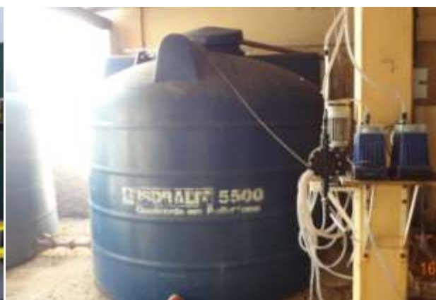
Figura 21 - Tanque de armazenamento de PAC
