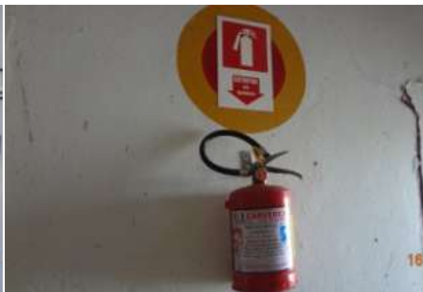
Figura 12 - Extintor de incêndio
