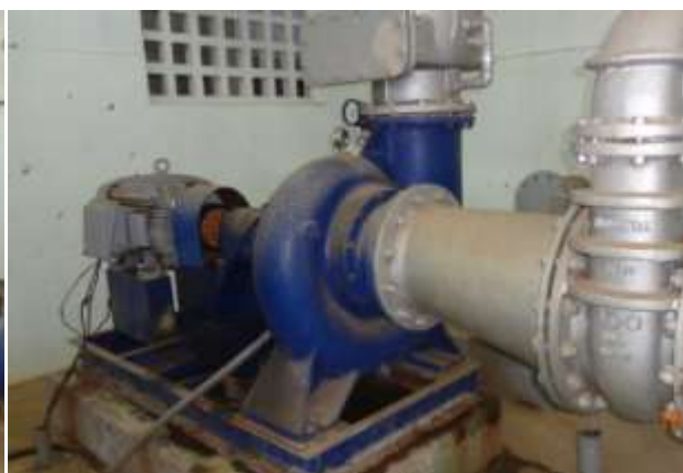
Figura 10 – Conjunto utilizado para lavagem dos filtros da ETA
