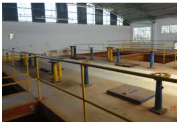
Figura 18 - Vista Geral Sistema de Filtração
