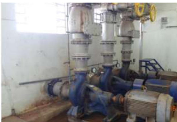
Figura 9 - Conjuntos de recalque da captação
