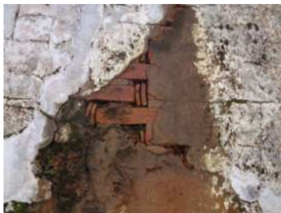
Figura 15 - Trinca com vazamento e alvenaria aparente
