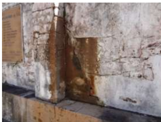
Figura 13 - Trinca com vazamento
