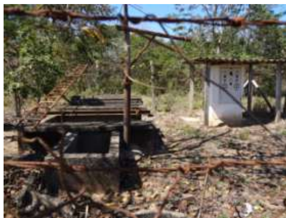
Figura 18 - Aspecto do painel elétrico, gradeamento e talha para manutenção
