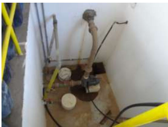
Figura 9 - Recalque para reservatórios
