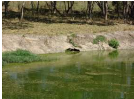
Figura 20 - Rompimento no revestimento
