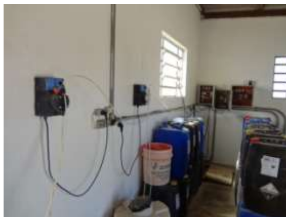
Figura 8 - Bombas dosadoras de Hipoclorito de Sódio e Ácido Fluorsilícico
