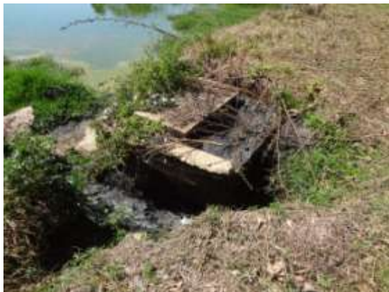
Figura 19 - Rompimento do revestimento do talude na chegada na ETE
