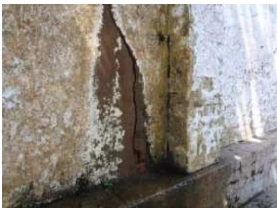
Figura 14 - Trinca com vazamento
