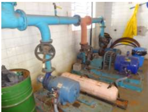
Figura 24 - Equipamentos da elevatória
