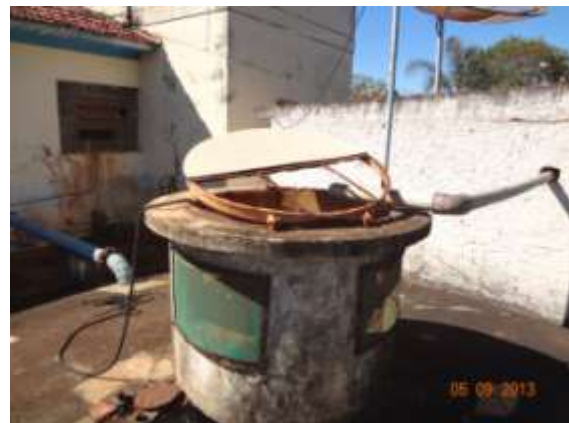
Figura 29 - Detalhe da tampa de inspeção danificada
