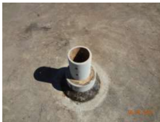
Figura 30 - Tubo de ventilação sem tela de proteção
