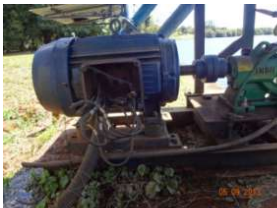
Figura 9 - Detalhe dos fios expostos
