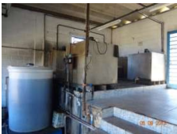
Figura 17 - Armazenamento dos produtos químicos
