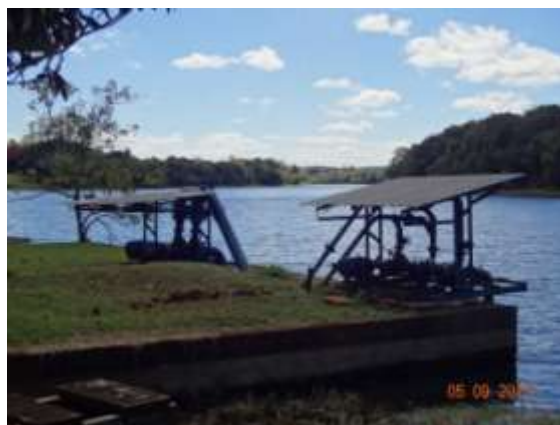
Figura 8 - Vista Geral da captação
