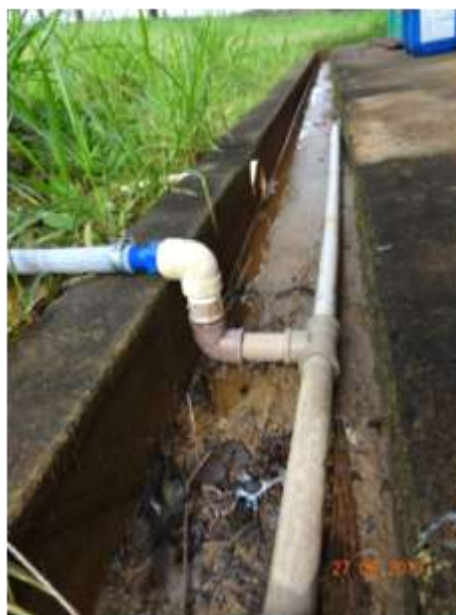
Figura 18 - Vazamento de PAC
