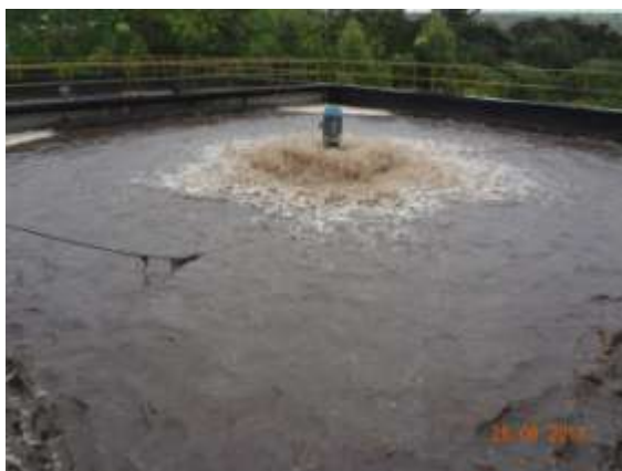
Figura 34 - Tanque de Aeração
