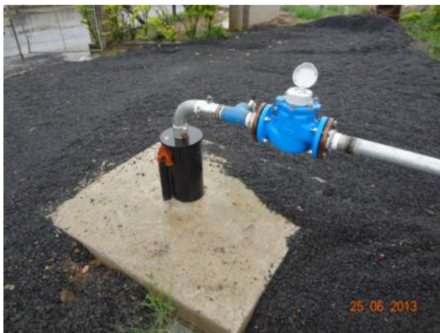
Figura 26 - Hidrômetro e laje de proteção do poço Castelani
