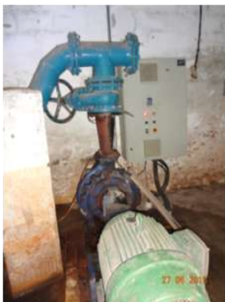
Figura 23 - Detalhe do conjunto de recalque
