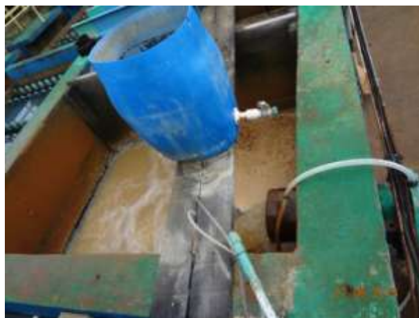
Figura 10 - Entrada de água bruta e dosagem de PAC
