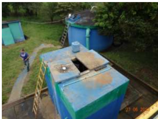
Figura 14 - Aspecto do tanque de contato
