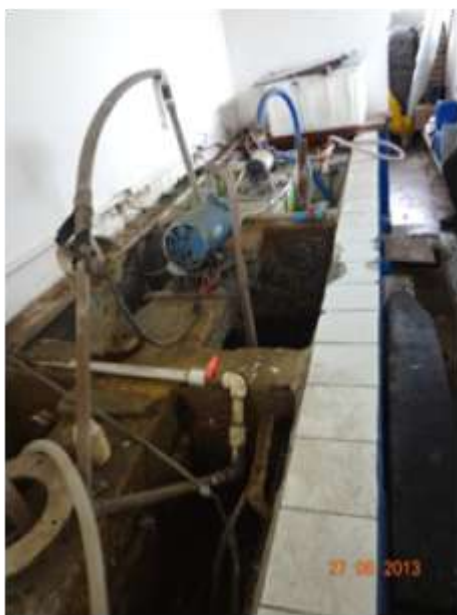
Figura 17 - Aspecto da sala de preparo de carga
