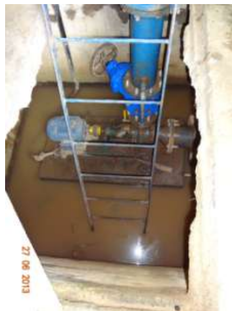
Figura 8 - Conjunto de cota mais baixa, com parte dos cabos imersos
