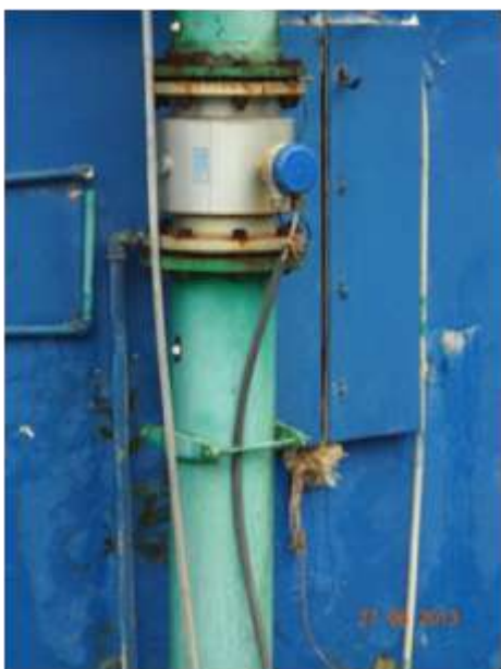
Figura 9 - Medidor de vazão de entrada (inoperante)
