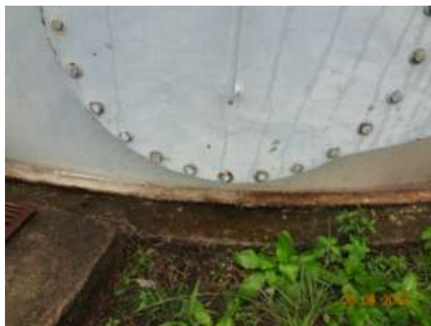
Figura 30 - Vazamento em tampa de inspeção no costado do reservatório
