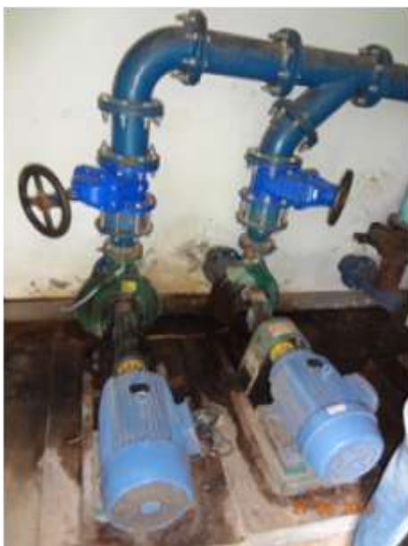
Figura 19 - Conjuntos de recalque para Gran Tour
