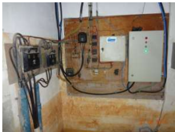
Figura 24 - Aspecto dos quadros elétricos
