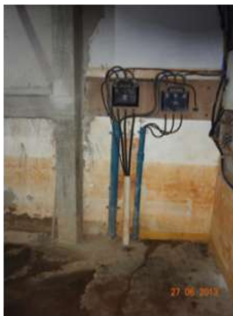
Figura 22 - Marcas de inundação recente, antes do isolamento da área do reservatório e EEAT
