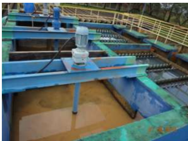
Figura 11 - Aspecto dos flocladores
