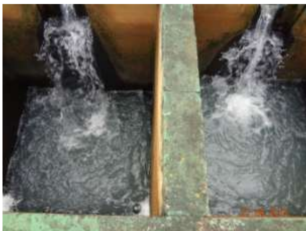
Figura 13 - Entrada da água nos filtros
