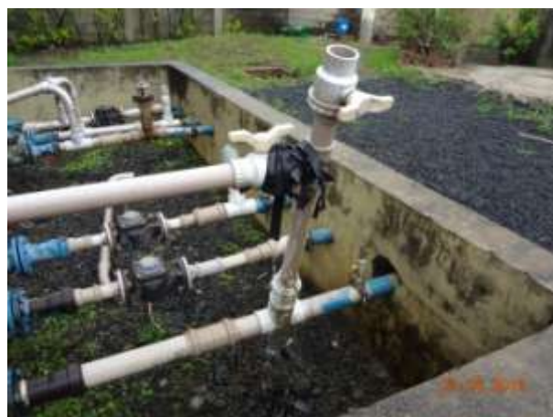
Figura 28 - Detalhe de vazamento na tubulação de saída do reservatório
