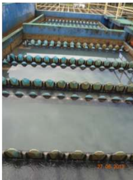
Figura 12 - Decantadores e saída para filtração
