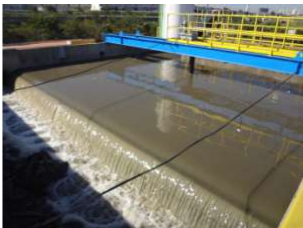
Figura 42 - Saída do efluente da caixa de areia
