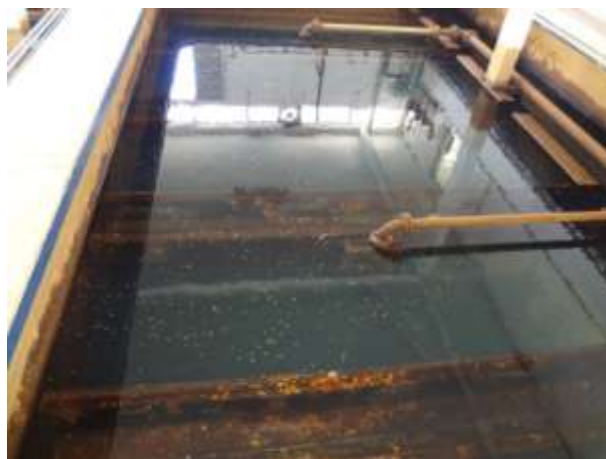
Figura 21 - Tanques de filtração com folhas de árvores próximas
