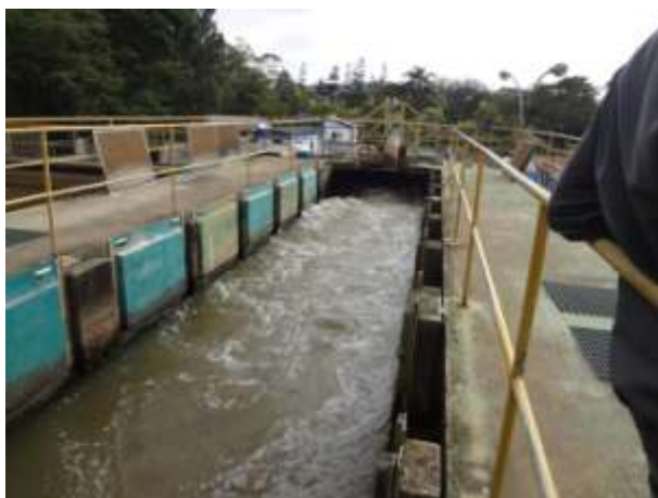
Figura 27 - Chegada da água bruta
