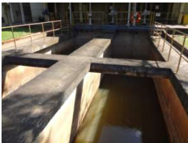
Figura 8 - Caixa de areia
