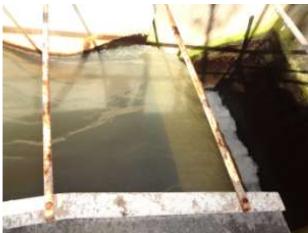
Figura 53 - Efluente após tratamento (saída da calha Parshall)
