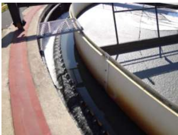
Figura 51 - Saída do efluente do flotador
