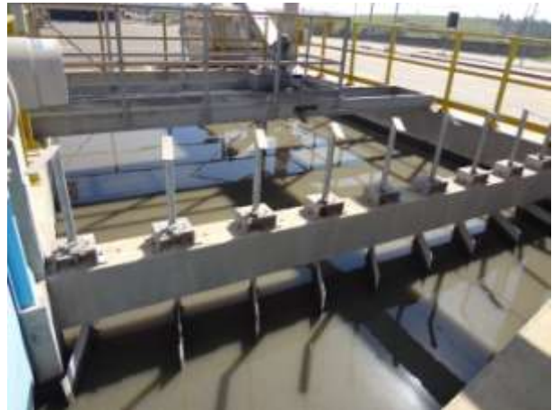
Figura 59 - Caixa de areia
