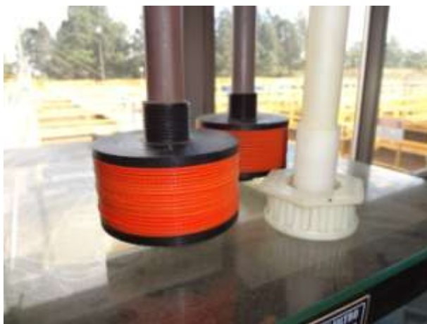
Figura 33 - Crepinas contidas nos filtros
