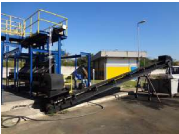
Figura 44 - Sistema de retirada dos sólidos das grades grosseiras
