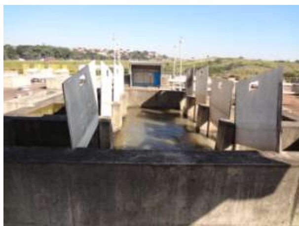
Figura 47 - Entrada do efluente no reator
