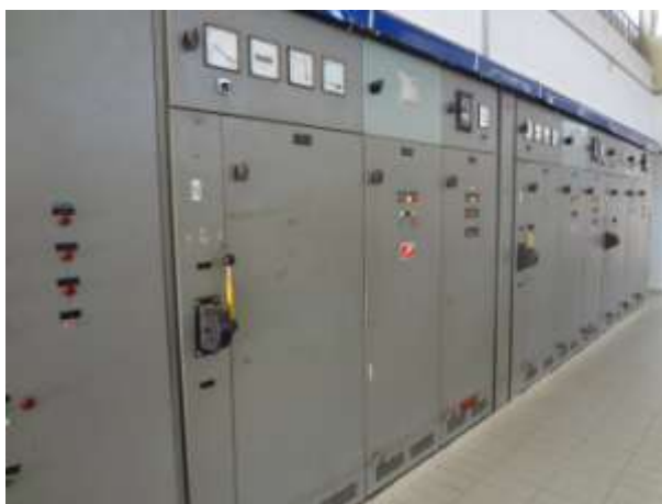
Figura 12 - Pannel elétrico em boas condições e operante
