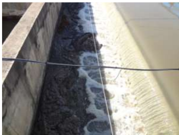
Figura 43 - Detalhes do acúmulo de gordura na saída do desarenador
