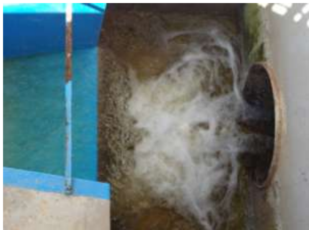
Figura 60 - Saída do Efluente final
