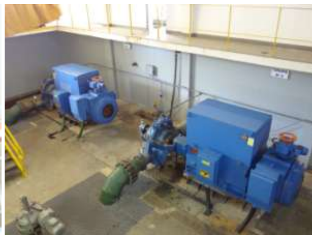
Figura 11 - Casa de máquinas
