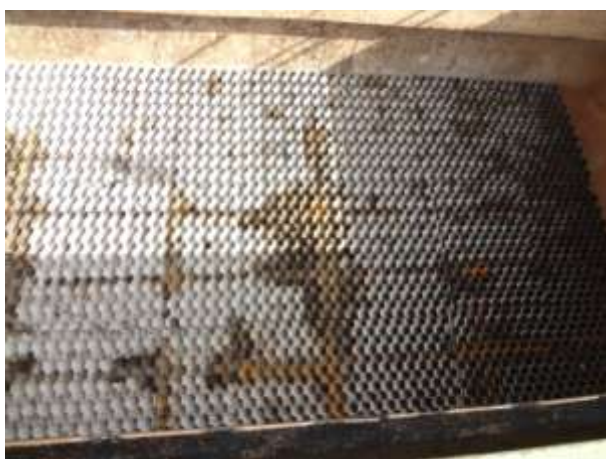
Figura 31 - Decantador de alta taxa tipo colmeia (após lavagem)
