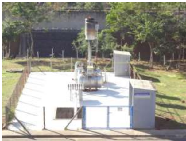
Figura 45 - Queimador de biogás
