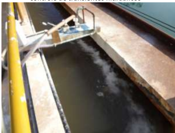
Figura 18 - Dosador de produtos químicos para floculação
