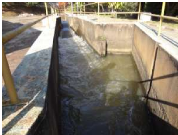
Figura 17 - Chegada da água bruta
