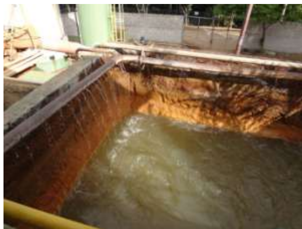
Figura 28 - Tanque de contato
