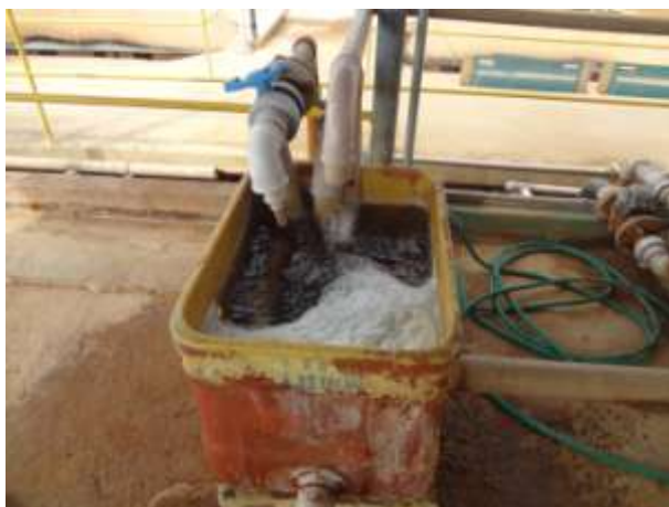
Figura 29 - Dosador de produtos químicos
