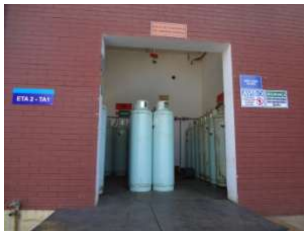
Figura 23 - Armazenamento de amônia
