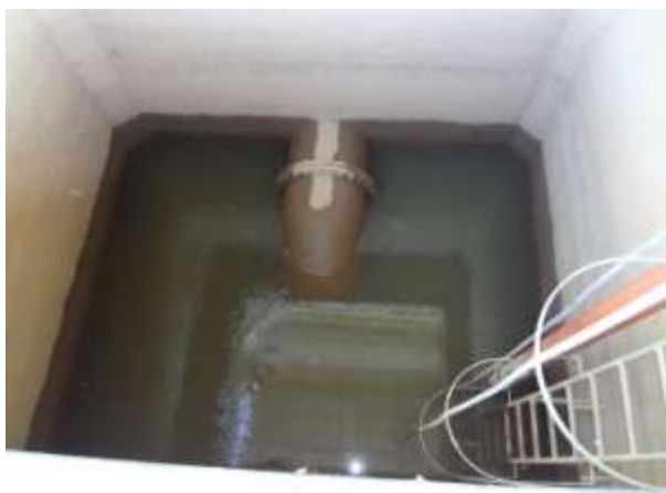
Figura 10 - Poço de sucção
