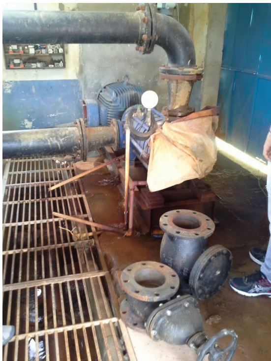
Descrição(5): Casa de bombas
