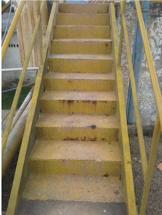
Descrição (9): Escadas de acesso a ETA em processo de oxidação
