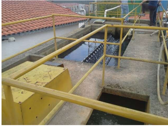
Descrição (15): Vista geral da ETA
