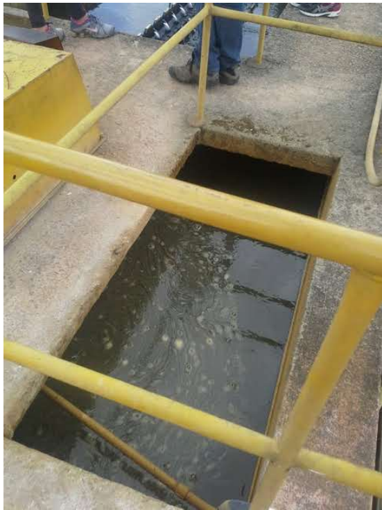
Descrição (14): Floculador mecânico
