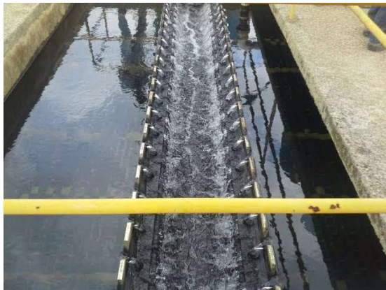
Descrição (16): Vertedor de saída para os filtros
