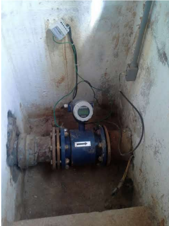
Descrição(2): Macromedidor de vazão eletromagnético
