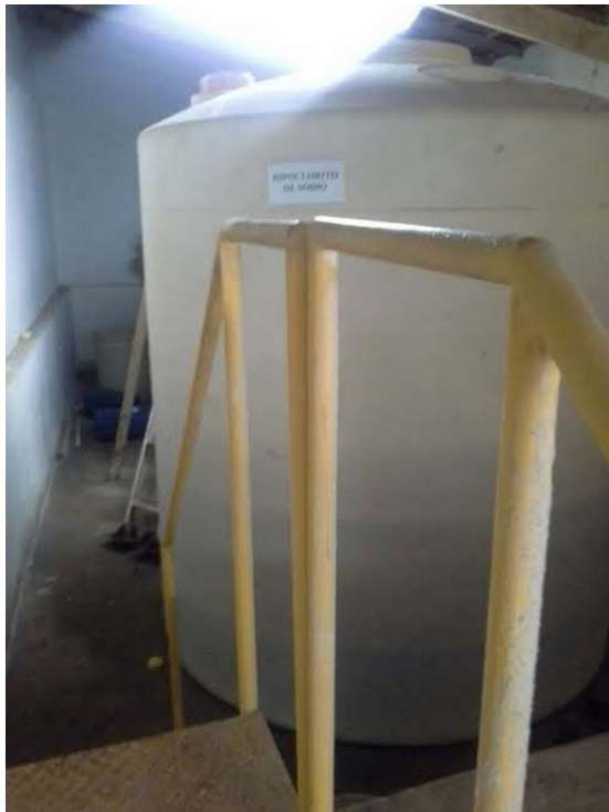
Descrição (5): Tanque de hipoclorito de sódio
