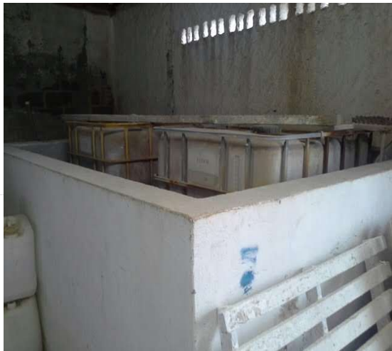
Descrição (4): Tanques de armazenamento de flúor
