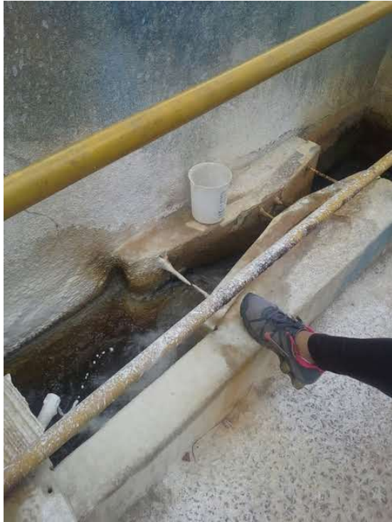
Descrição (13): Entrada da água bruta.
