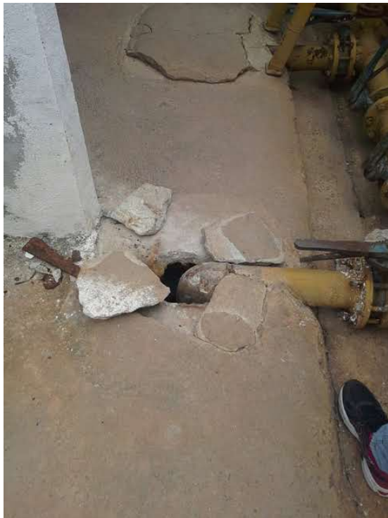
Descrição (17): Poço de passagem de água tratada contendo rachaduras.
