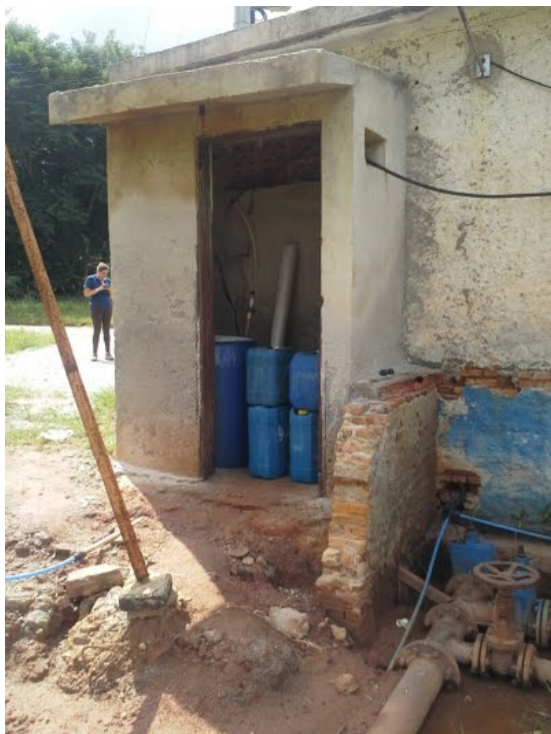
Descrição(3): Armazenamento de hipoclorito de sódio
