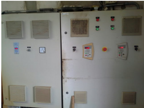
Descrição(9): Painel elétrico
