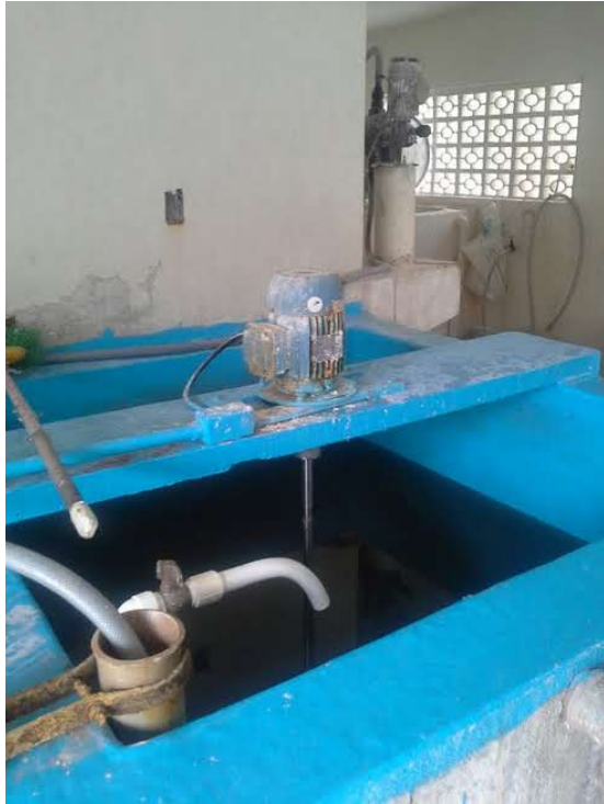
Descrição (7): Tanque para preparo dos produtos quimicos (sulfato de alumínio)
