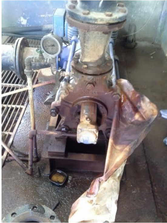
Descrição(8): Detalhes do vazamento de água pelas gaxetas
