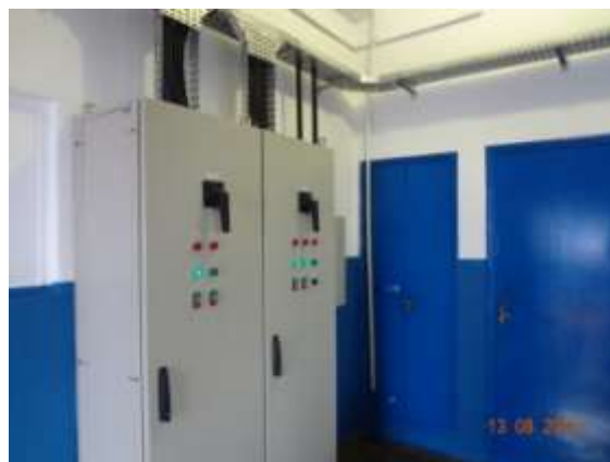
Figura 26 - Painéis elétricos da casa de bombas
