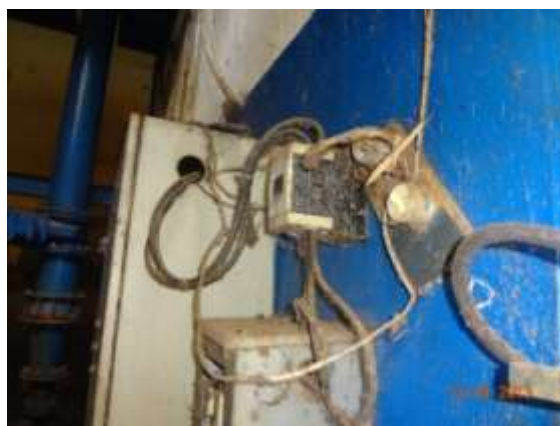
Figura 10 - Detalhe da fiação exposta
