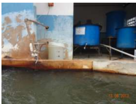
Figura 21 - Mangueiras de aplicação de coagulante que necessitam ser fixada adequadamente
