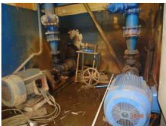
Figura 9 - Conjuntos moto-bomba reserva
