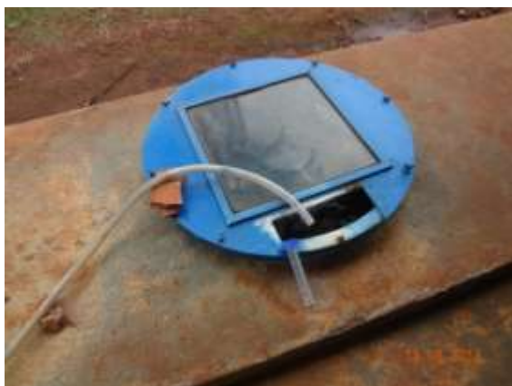
Figura 19 - Mangueira de aplicação de Cloro que necessita ser fixada adequadamente
