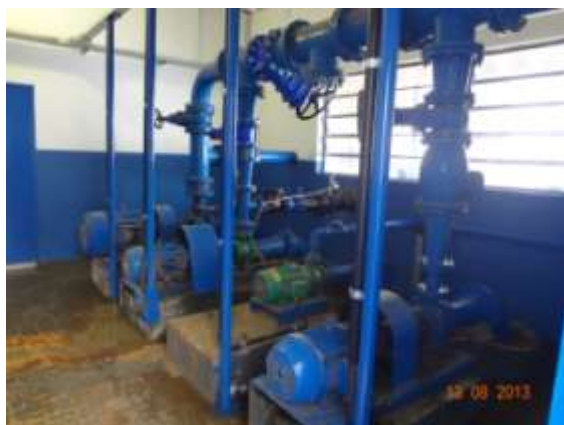
Figura 25 - Equipamentos da casa de Bombas
