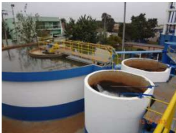
Figura 15 - Vista geral de um módulo da ETA II
