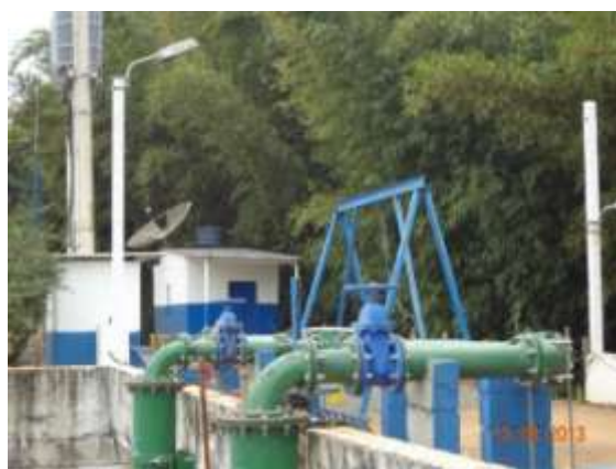
Figura 8 - Captação represa Cotrins
