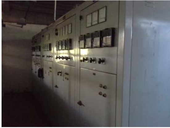
Descrição(8): Paineis eletricos
