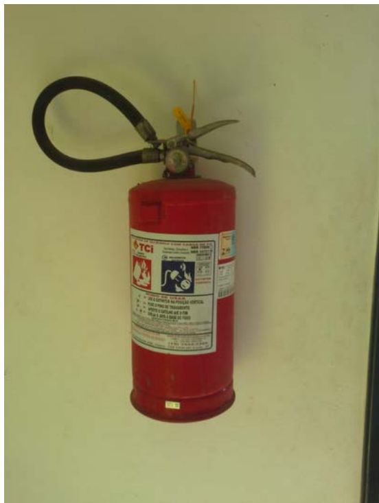
Descrição(9): Extintor de incêndio
