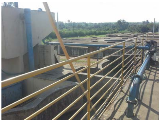
Descrição(5): Separador de areia
