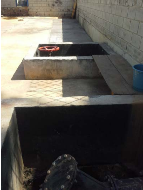
Descrição(8): Registros de saída das adutoras
