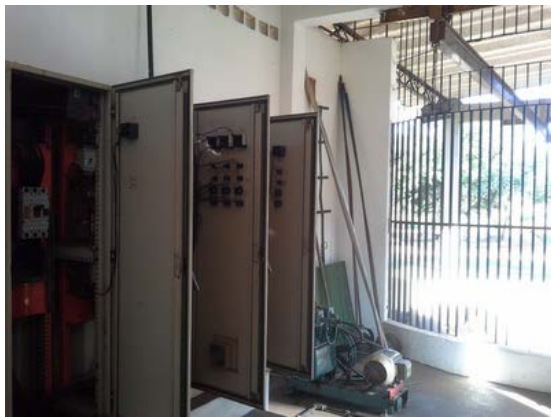
Descrição(12): Paineis elétricos e monovia
