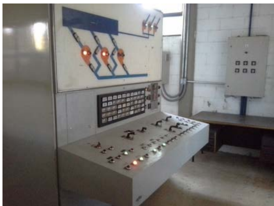
Descrição(7): Paineis de comando
