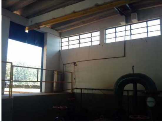
Descrição(8): Monovia para retirada de bombas e motores
