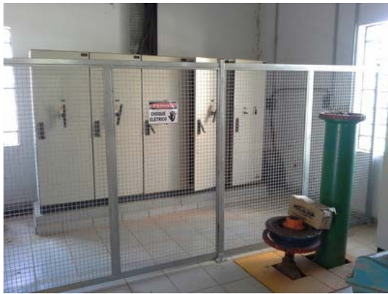
Descrição(6): Paineis elétricos
