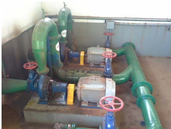
Descrição(3): Conjuntos de recalque
