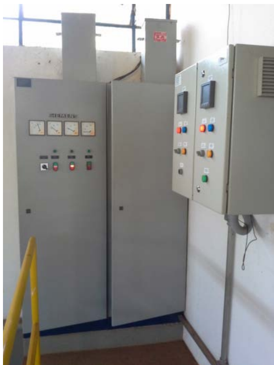
Descrição(4): Paineis elétricos
