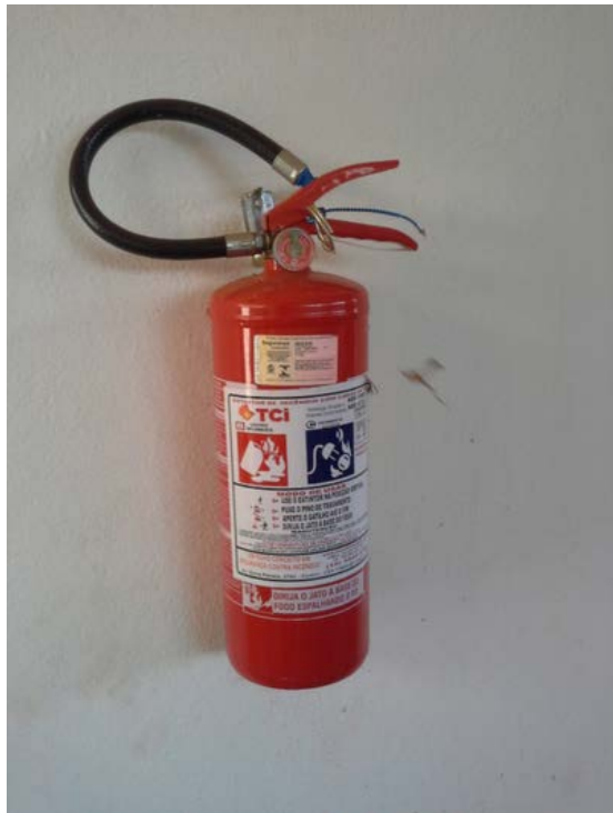
Descrição(5): Extintor de incêndio
