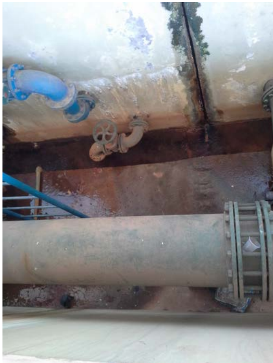
Descrição(9): Vazamentos nas paredes dos filtros e tanque de contato
