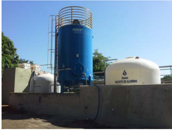
Descrição(6): Armazenamento de produtos químicos
