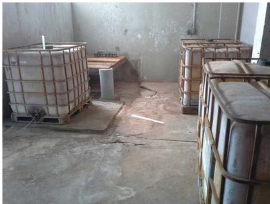
Descrição(7): Armazenamento e dosagem de Ácido Fluorsilícico
