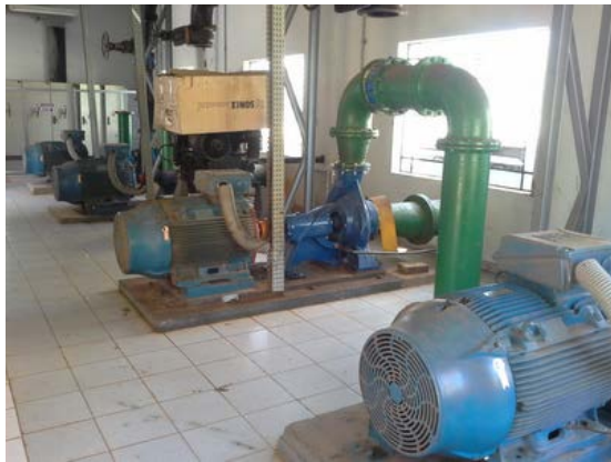
Descrição(5): Conjuntos de recalque
