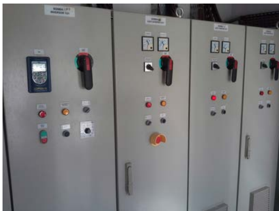
Descrição(7): Paineis dos conjuntos de recalque
