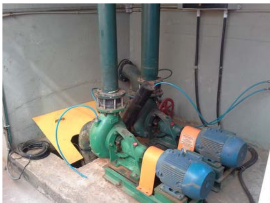
Descrição(5): Recalque da água de lavagem de filtros para reuso
