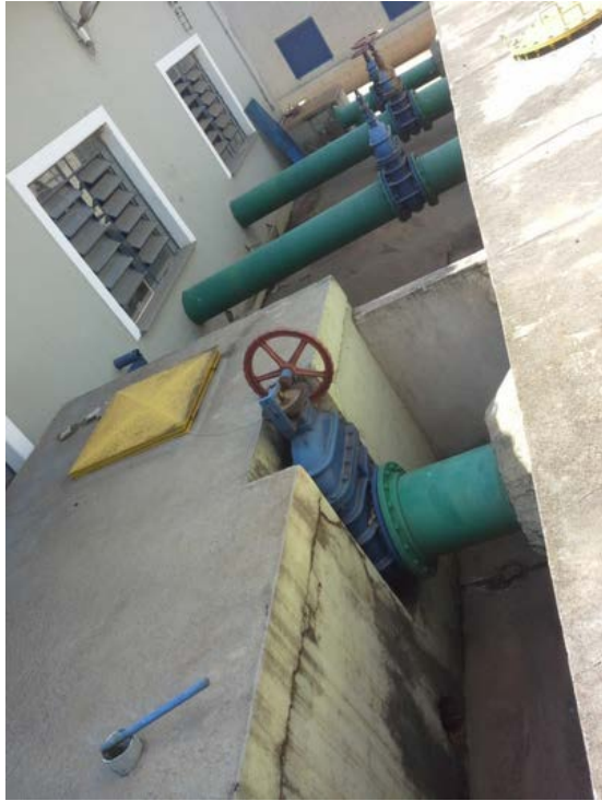
Descrição(4): Tubulações de sucção
