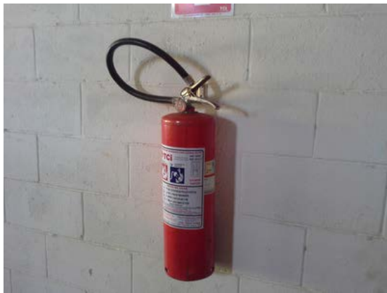
Descrição(9): Extintor de incendio
