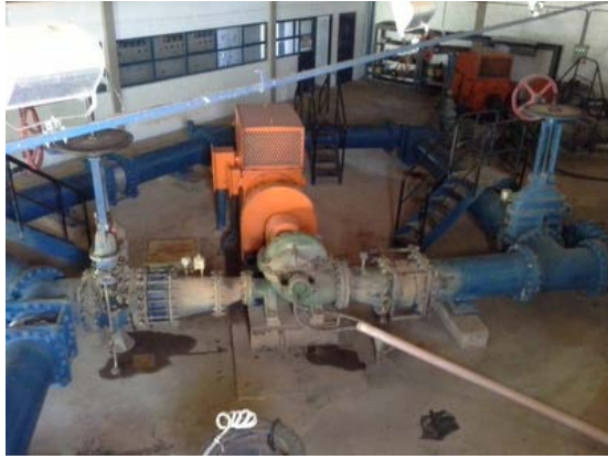
Descrição(5): Conjuntos de recalque
