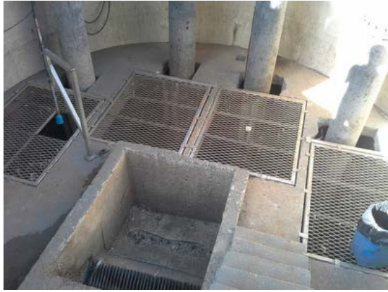
Descrição(11): Gradeamento grosseiro e poço de sucção da EEBB
