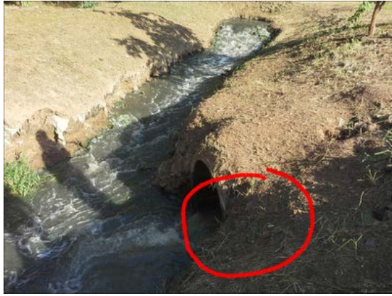
Descrição(14): Efluente final e by-pass em destaque
