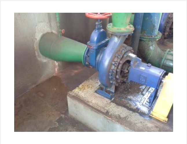
Descrição(7): Drenagem da água de lubrificação de gaxetas
