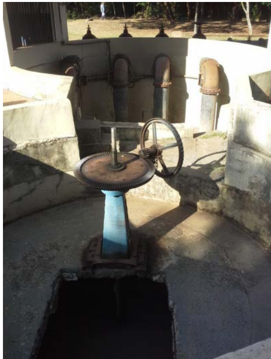
Descrição(10): Chegada da esgoto bruto na EEEB
