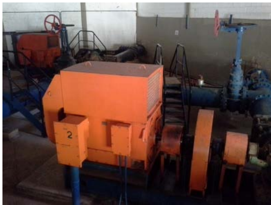
Descrição(6): Conjuntos de recalque
