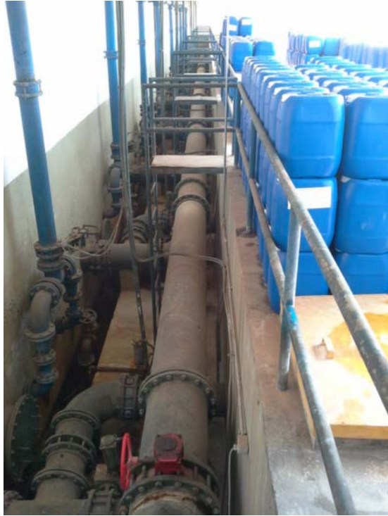
Descrição(8): Tubulações de saída de filtros e armazenamento de Ortopolifosfato
