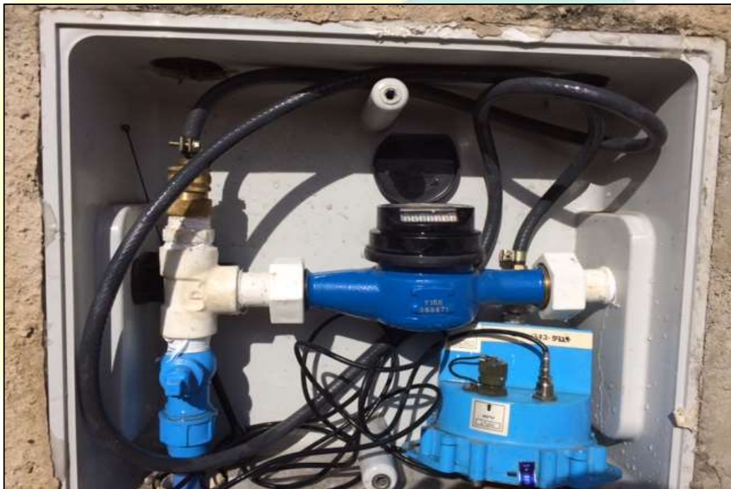
Figura 1 – Foto do local da instalação do Datalogger modelo Multilog LX GPRS
