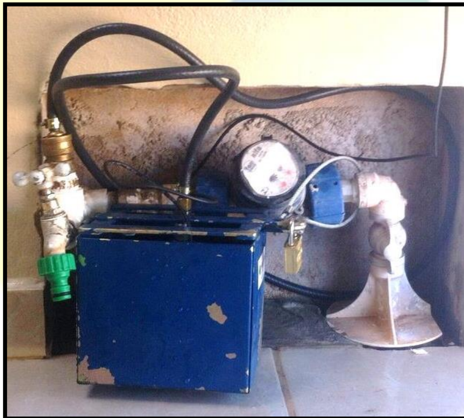
Figura 1 – Foto do local da instalação do Datalogger modelo Multilog LX GPRS
