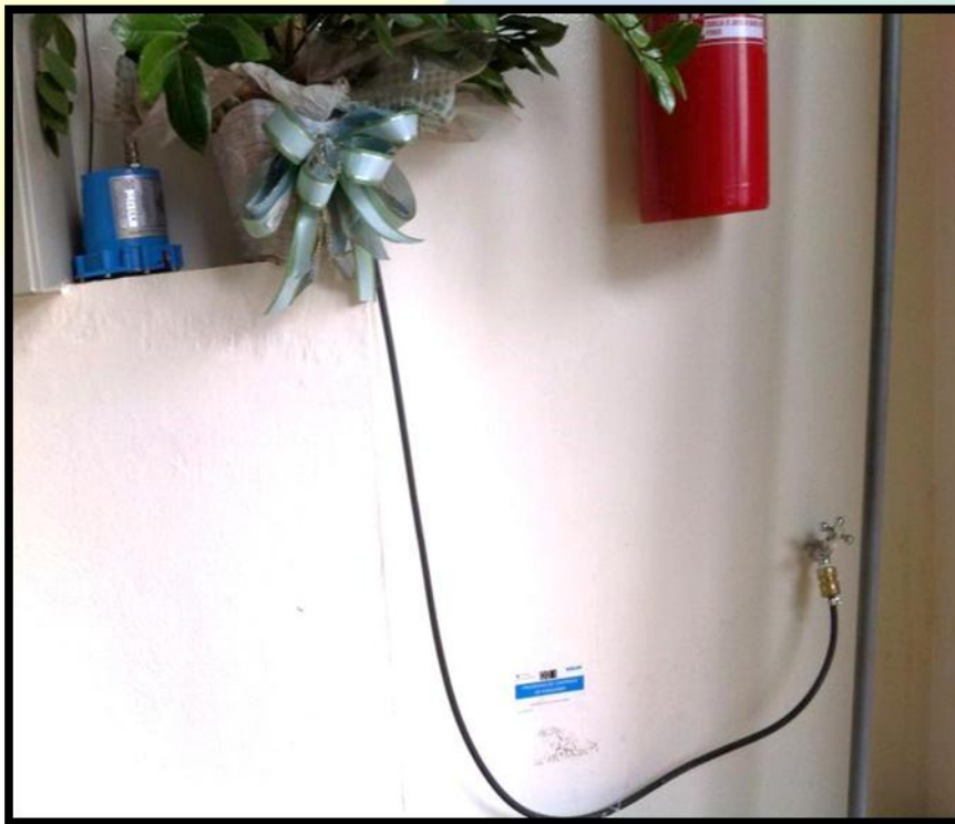
Figura 1 – Foto do local da instalação do Datalogger modelo Multilog LX GPRS
