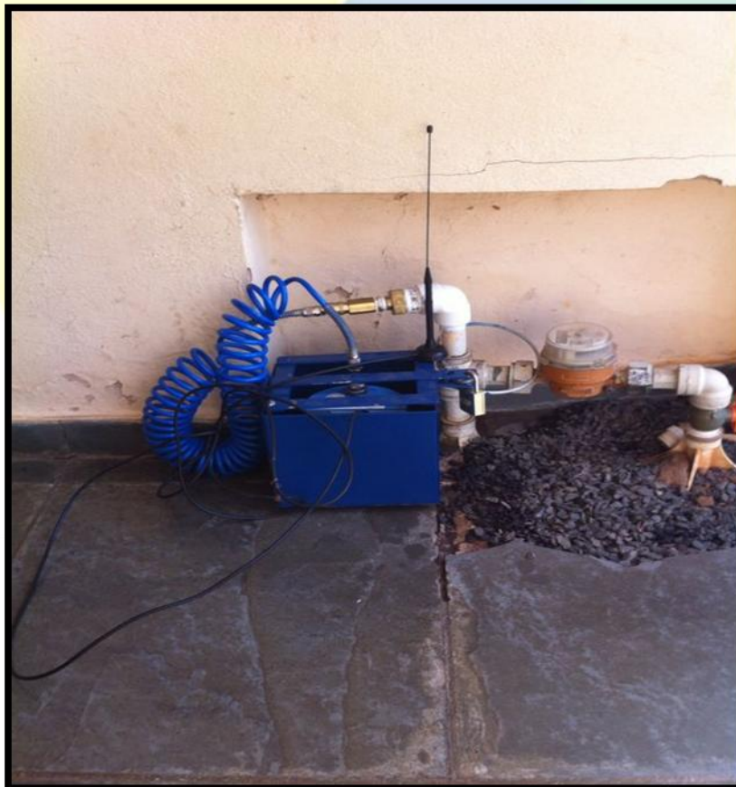
Figura 1 – Foto do local da instalação do Datalogger modelo Multilog LX GPRS
