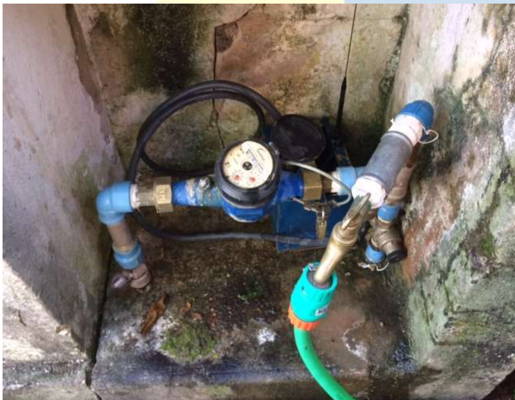
Figura 1 – Foto do local da instalação do Datalogger modelo Multilog LX GPRS
