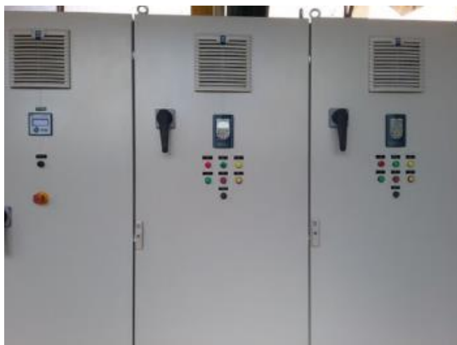
Figuras 4 a 7 – Bombas e painéis novos da Captação Superficial Piray.
