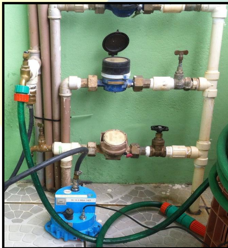
Figura 1 – Foto do local da instalação do Datalogger modelo Multilog LX GPRS
