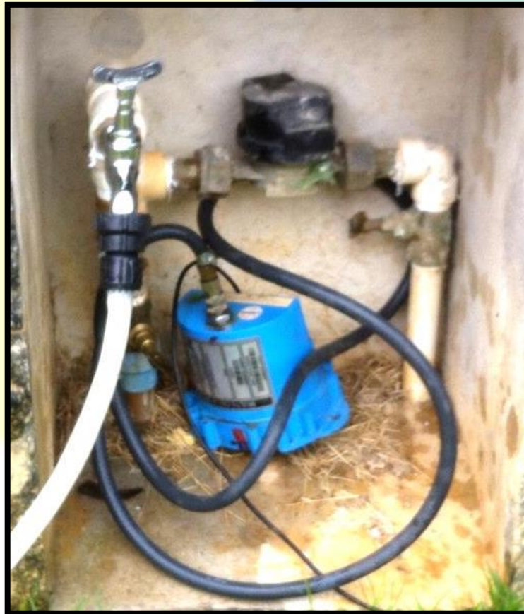
Figura 1 – Foto do local da instalação do Datalogger modelo Multilog LX GPRS
