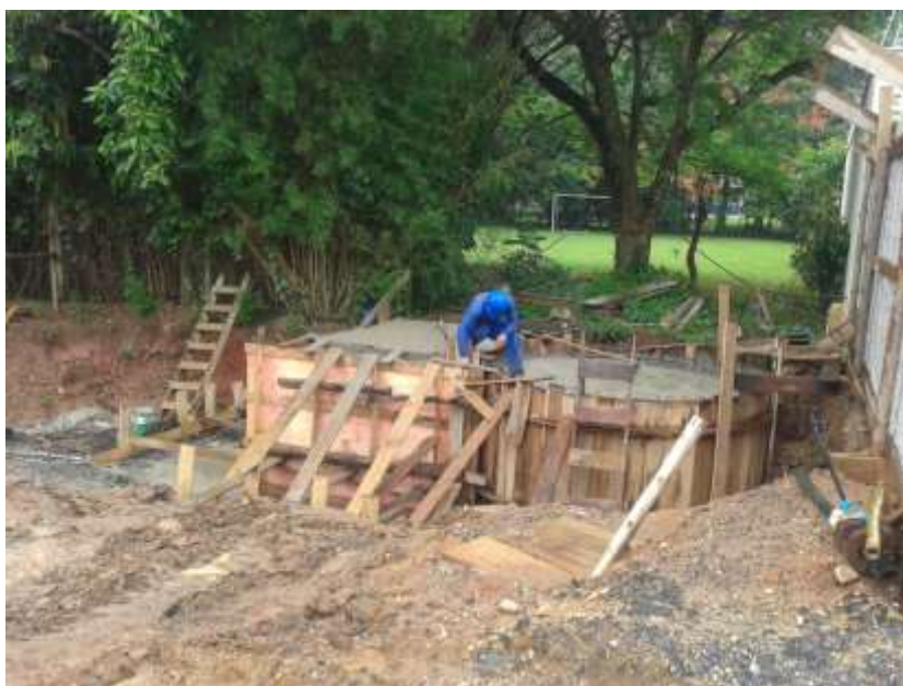
Figura 9 – Construção do Sistema de Coleta e Afastamento de Esgoto Fase II, 2ª Etapa
