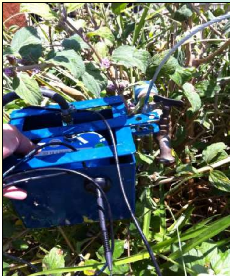
Figura 1 – Foto do local da instalação do Datalogger modelo Multilog LX GPRS
