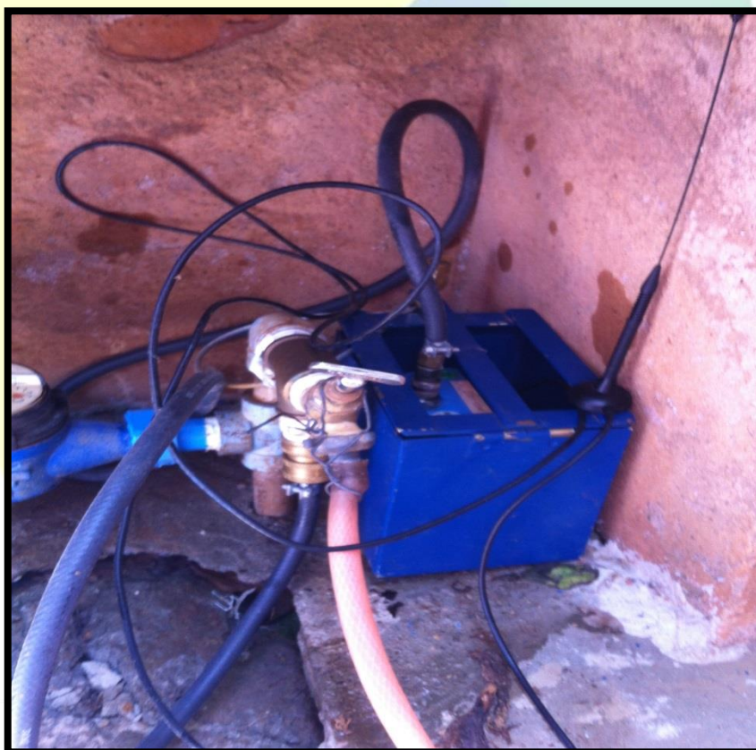
Figura 1 – Foto do local da instalação do Datalogger modelo Multilog LX GPRS
