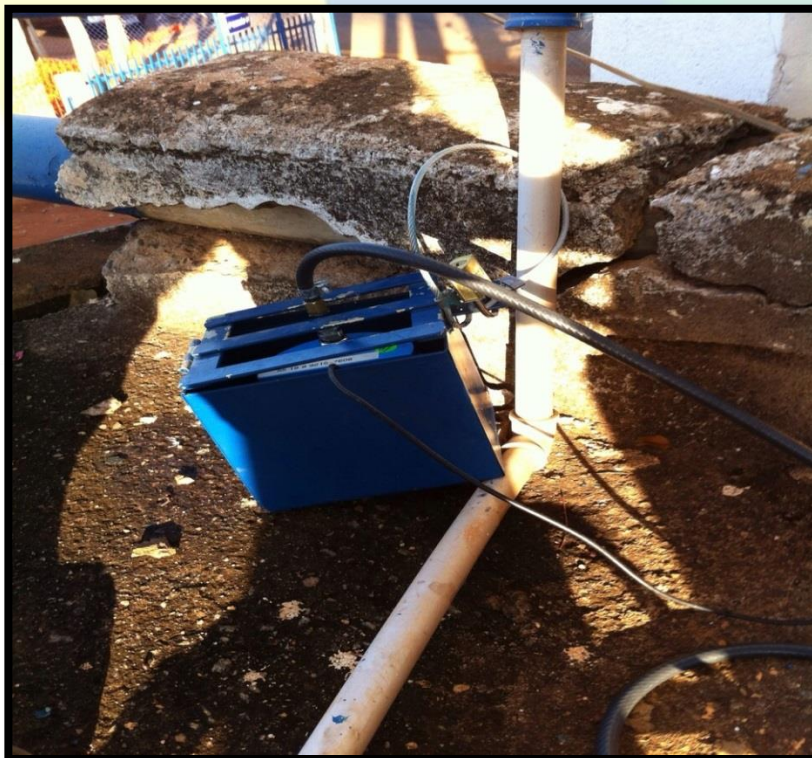
Figura 1 – Foto do local da instalação do Datalogger modelo Multilog LX GPRS
