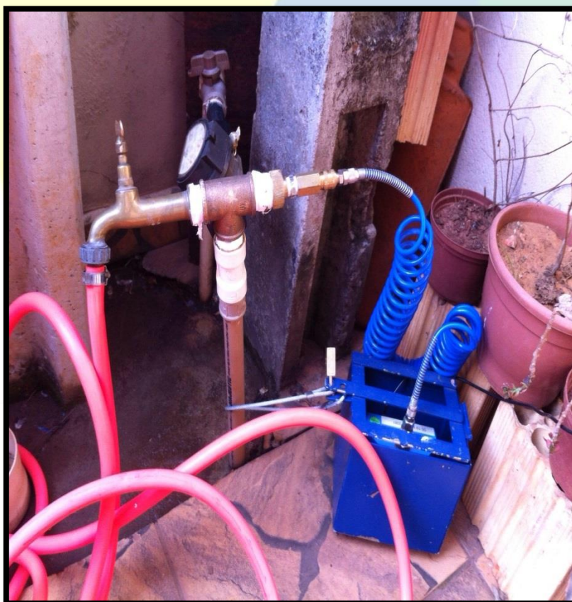
Figura 1 – Foto do local da instalação do Datalogger Multilog LX GPRS.
