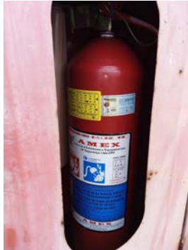
Descrição(8): Extintor de incêndio dentro do prazo de validade Imagem(9)
