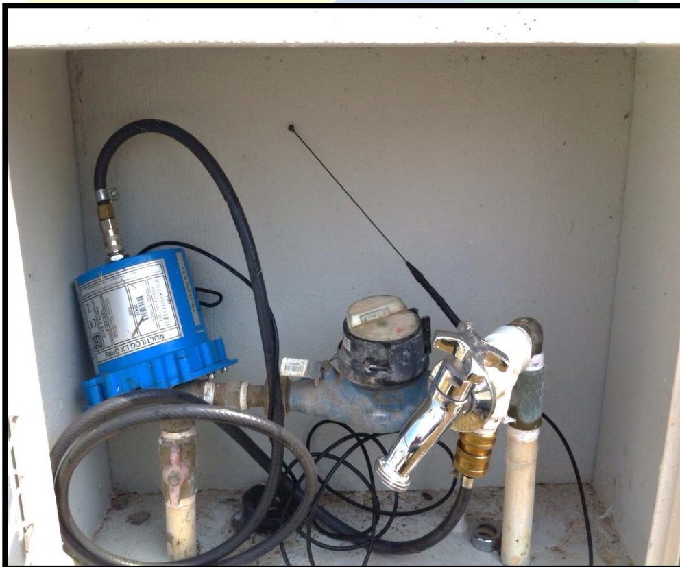
Figura 1 – Foto do local da instalação do Datalogger modelo Multilog LX GPRS
