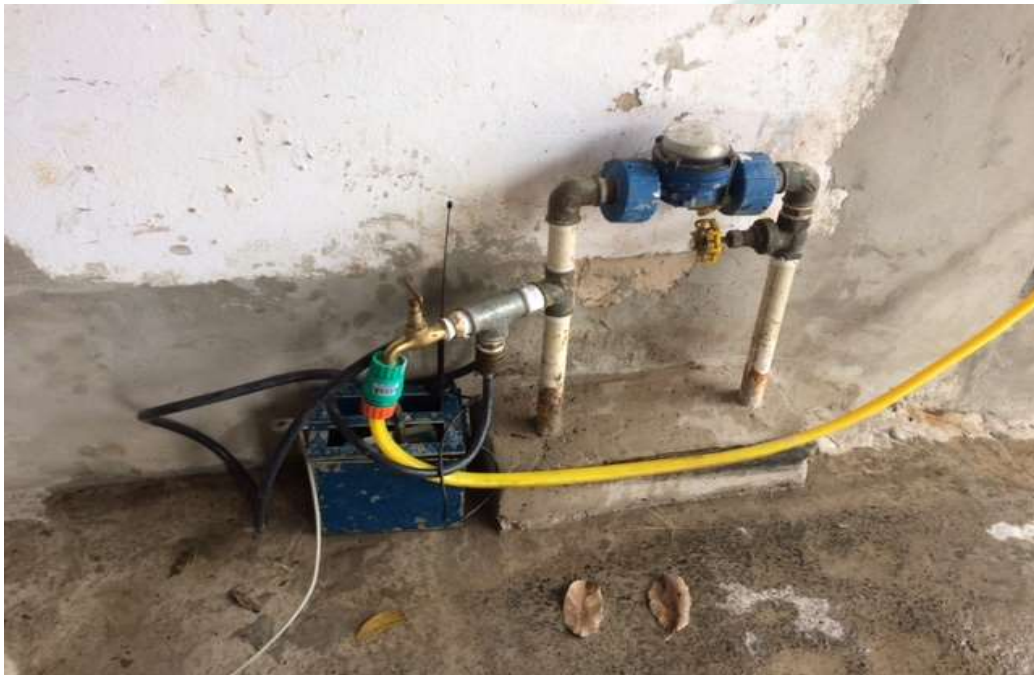
Figura 1 – Foto do local da instalação do Datalogger modelo Multilog LX GPRS
